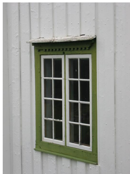
Vindu i sørveggen med original utvendig belistning. Selve rammene er utskiftet i flere av fagene. Opphavsrett: Statsbygg.
