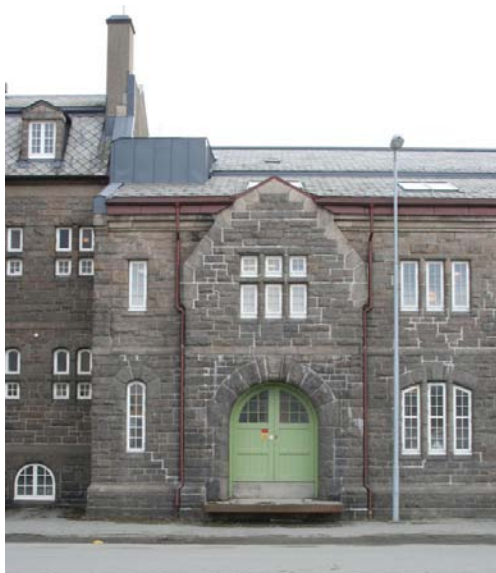
Møte mellom hovedbygningen t.v. og nordre pakkhusfløy. Stor variasjon i vinduenes former og formater. Foto: J. Chr. Eldal, NIKU 2008.
