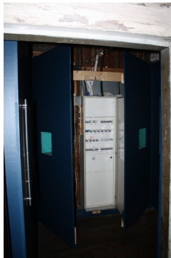
FIGUR 98 TAVLEROM 2.7 SVINGBAR UTSTILLING MONTERT FORAN SIKRINGSTAVLE.
