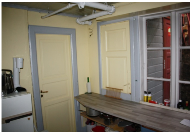
FIGUR 27 KJØKKEN ROM 3.5 SETT MOT SV. AVSTENGT DØR MOT TIDLIGERE BISLAG/HVERDAGSINNGANG, NÅ PUMPEROM FOR OVERRISLINGSANLEGG.
