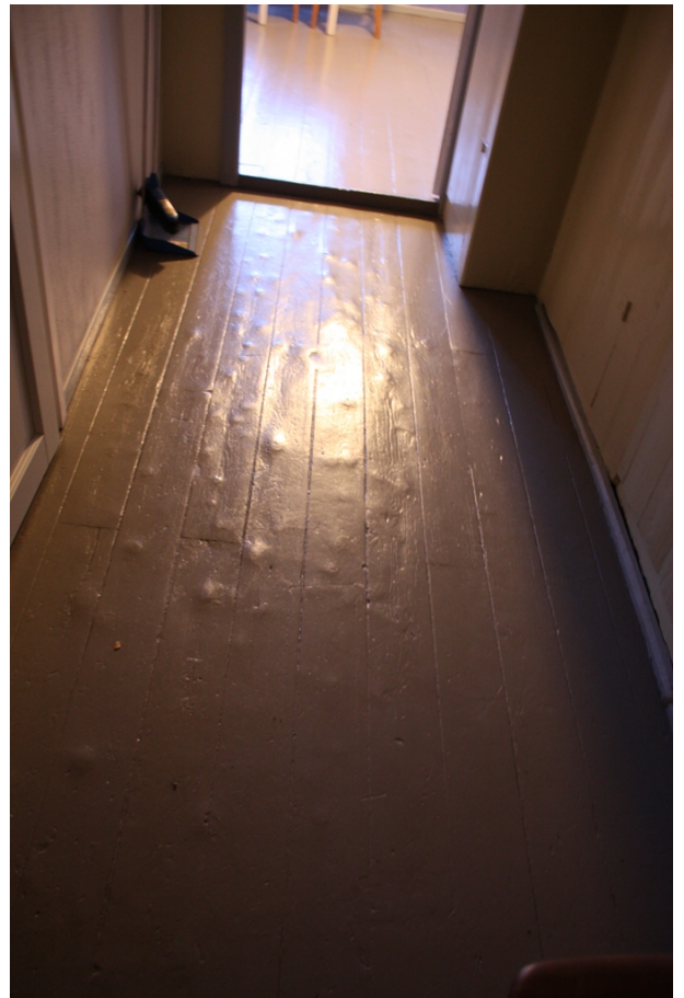
FIGUR 66 BYGNING NR. 1 HOVEDHUSET ROM 5.2 GANG. SLLITTE GOLVBORD.
