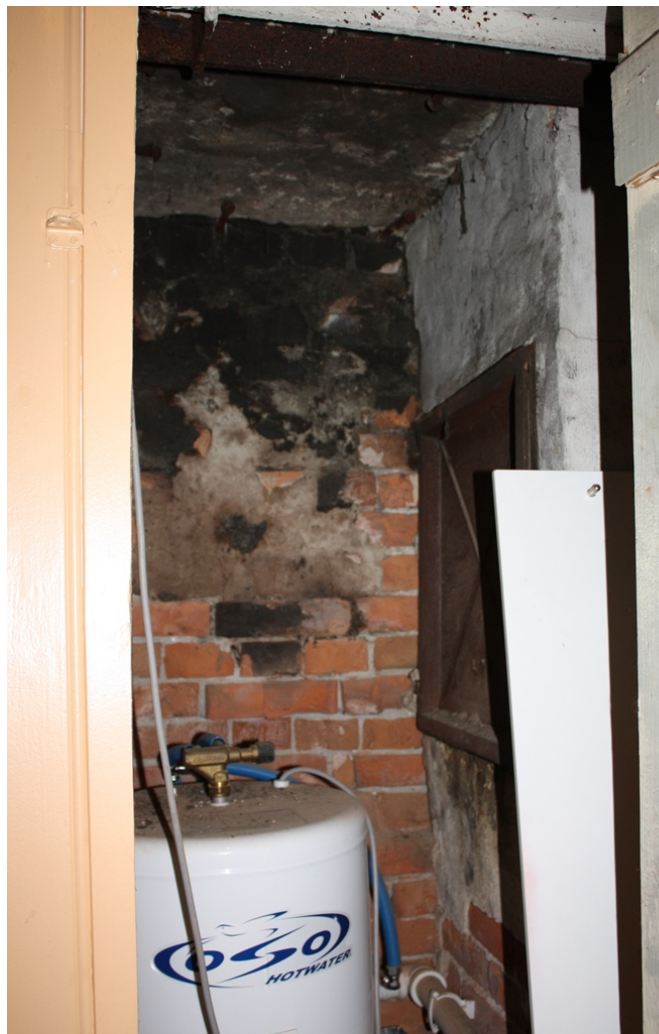
FIGUR 20 BYGNING NR. 1 HOVEDBYGNING. ROM 2.7 PIPEROM. PIPE FØRT NED I DEN GAMLE GRUEN. SOTETE PUSSRESTER.
