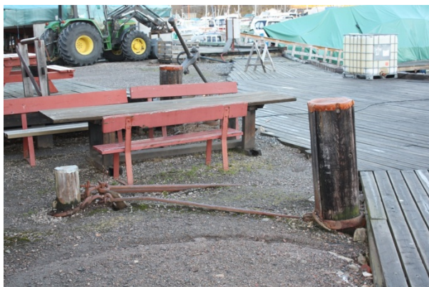
FIGUR 116 UTEAREAL NR. 7 MELLOMKAIA - FORTØYNINGSPÅLER. TO PÅLER SOM BETJENER HVER SIN HALVDEL AV MELLOMKAIA. KAI OG PÅLER FORANKRET VIA JERNSTAG TIL ET FORANKRINGSPOINT BAK.
