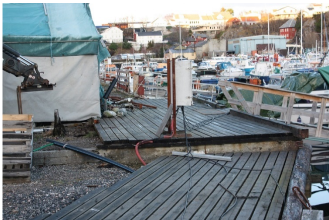
FIGUR 142 UTEAREAL NR. 17 KAI BEKHUSKAIA. BETONGKANT VISER DET SOM VAR KAIAS SØNDRE KANT MOT TØMMERDOKKEN.
