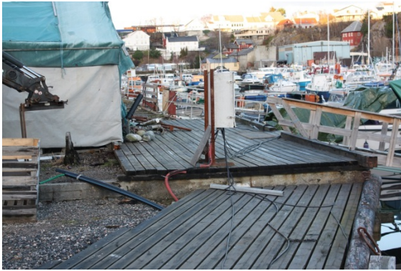
FIGUR 122 UTEAREAL NR. 9 TØMMERDOKK. TREKAI I FRAMKANT AV BILDET OVER YTTERSTE DEL AV DEN GJENFYLTE TØMMERDOKKEN. BEKHUSKAIA, UTEAREAL NR. 17, I BAKKANT DANNER NORDRE SIDE AV TØMMERDOKKEN.
