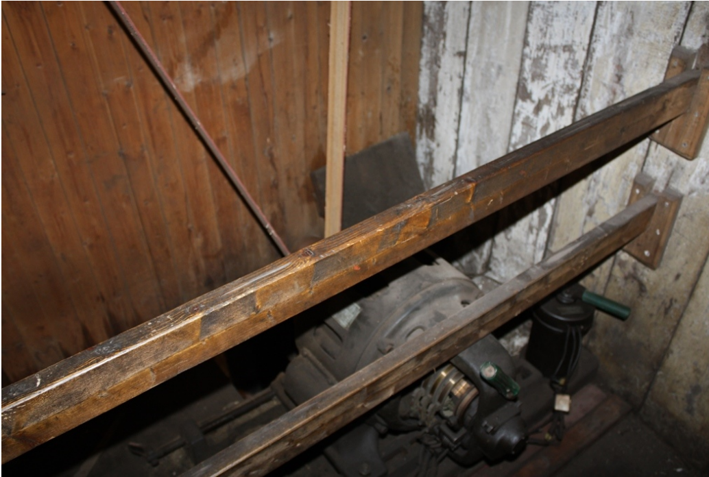
FIGUR 102 BYGNINGNR. 2 VERKSTEDBYGGET. ROM 2. 9 TRAPPEROM. ELEKTRISK MOTOR SOM DRIVER DET SENTRAL REIMSYSTEMET I MASKINVERKSTED, ROM 2.5.
