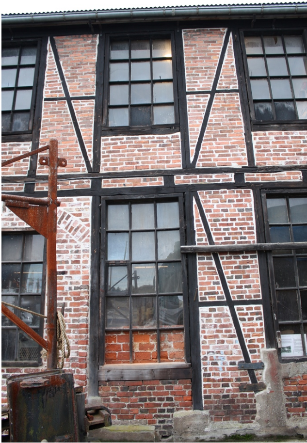
FIGUR 77 BYGNINGNR. 2 VERKSTEDBYGNINGEN. VINDUER I 1. OG 2. ETASJE VISER ENDRINGER FORÅRSAKET AV BRUKSFORHOLD PÅ INNSIDEN. HENGSLER LUKE I EN RUTE. RÅTESKADER I BINDINGSVERKET REPARERT MED BETONG. HODET TIL SLIPPEN "LITJHÆLING" I VENSTRE KANT.
