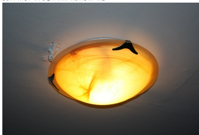
FIGUR 46 BYGNING NR. 1 HOVEDBYGNING ROM 4.4 SOVEROM. ELDRE TAKLAMPE.
