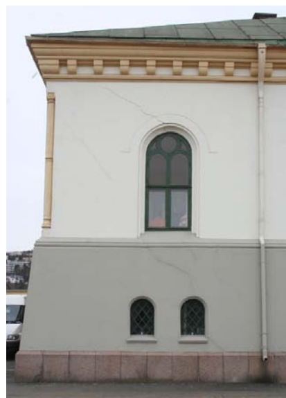
Nordre hjørne sett fra nordvest. Mange riss etter setningskader. Foto: J. Chr. Eldal, NIKU 2008.
