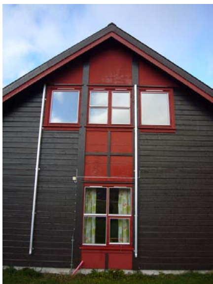
Bolig 2. Detalj vinduer. Opphavsrett: Statsbygg.
