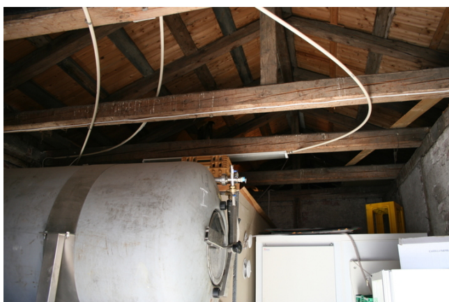
I den tidligere vedboden i søndre del er det installert tankanlegg for restaurantdriften. Sett mot nord.
