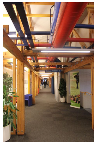
Gangarealet/korridor med ventilasjonsrør i sameflaggets farger. Foto: L.J. Hvinden-Haug, NIKU 2012.
