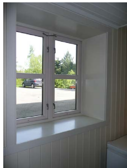
Kjellervindu i påbygd fløy fra 1925. Opphavsrett: Statsbygg.
