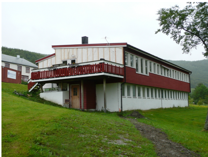
Skogly sett fra sørvest. Utskifting av panel på fasaden mot øst (2008). Opphavsrett: Statsbygg.
