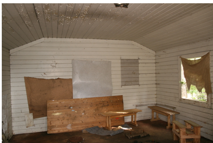
Interiør fra kraftstasjonen. Opphavsrett: Statsbygg.
