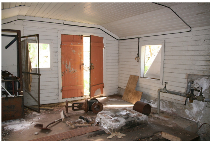
Interiør fra kraftstasjonen. Opphavsrett: Statsbygg.
