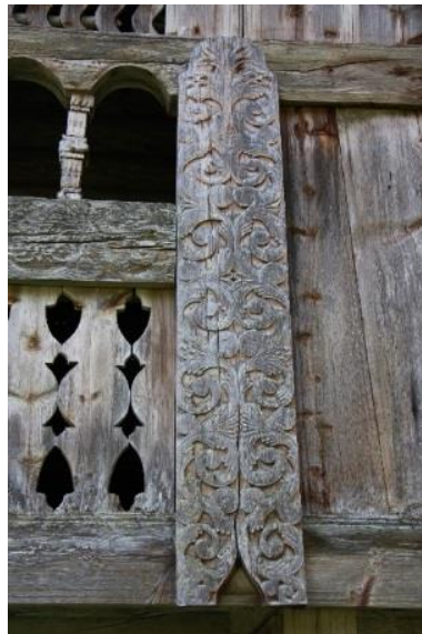
Figur 7. Svalstolpe på nord-vestfasaden
