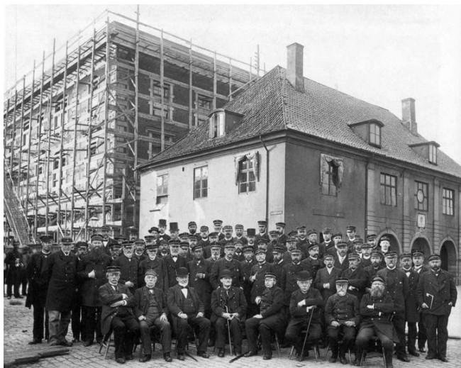
Tollboden under oppføring bakenfor den gamle fra 1790. Denne ble revet da den nye sto ferdig i 1896. Opphavsrett: Tollmuseet.
