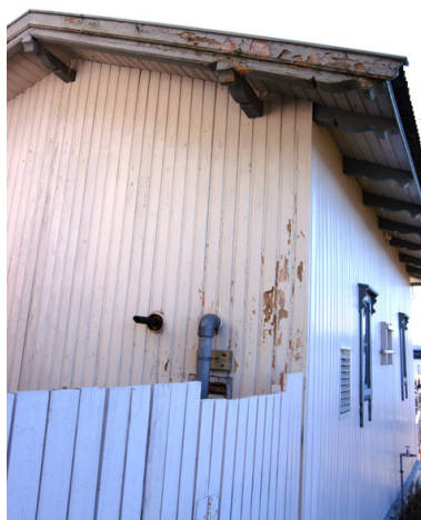
Fasade mot N, malingslitt med råteskadde vindskier Foto: Anne Sætren, NIKU 2008
