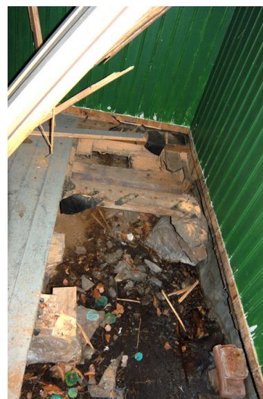
Innredet rom i uthuset, råteskader. Foto: Anne Sætren, NIKU 2008
