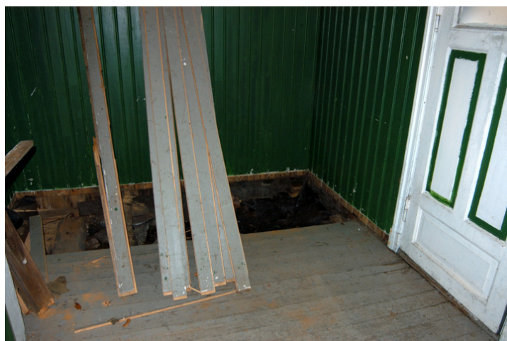
Innredet rom i uthuset, råteskader. Foto: Anne Sætren, NIKU 2008
