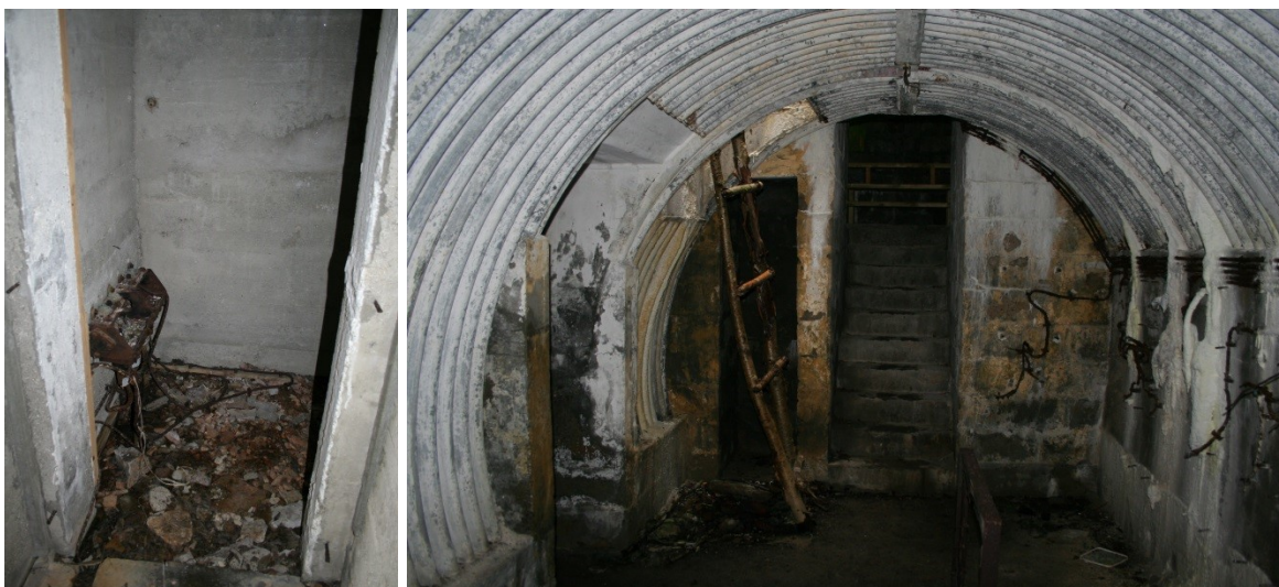
Eksempel på eksisterende koblingsboks(er). Inventar i kommandobunker/målestasjon.
