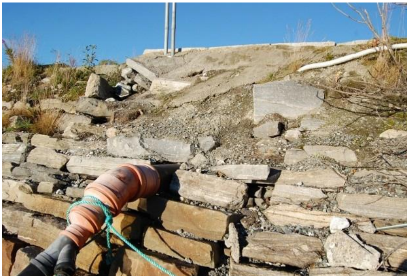
Skade på mur i forbindelse med avløpsrør. Foto: Troms fylkeskommune.
