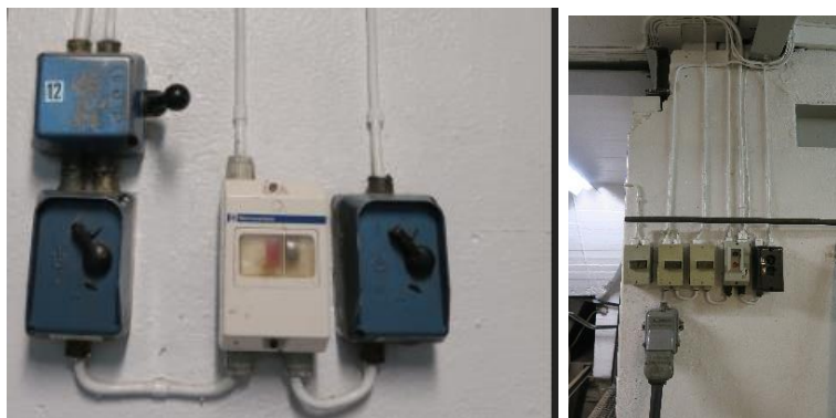
Tv. på veggen inn til maltlagerrommet er det montert styringsbrytere. Th. På veggen utenfor mottakskontoret er det også montert styringsbrytere.
