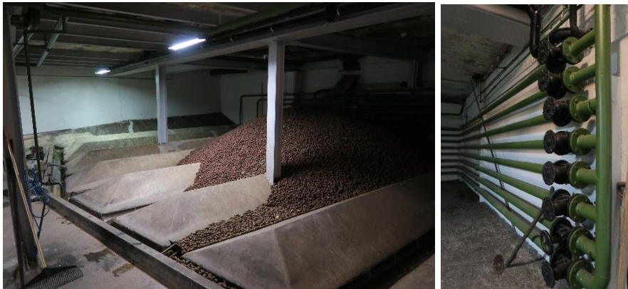
To. v-formede vannrenner i potetkjelleren. Th. vanntilførselsystemet til hver av rennene.
