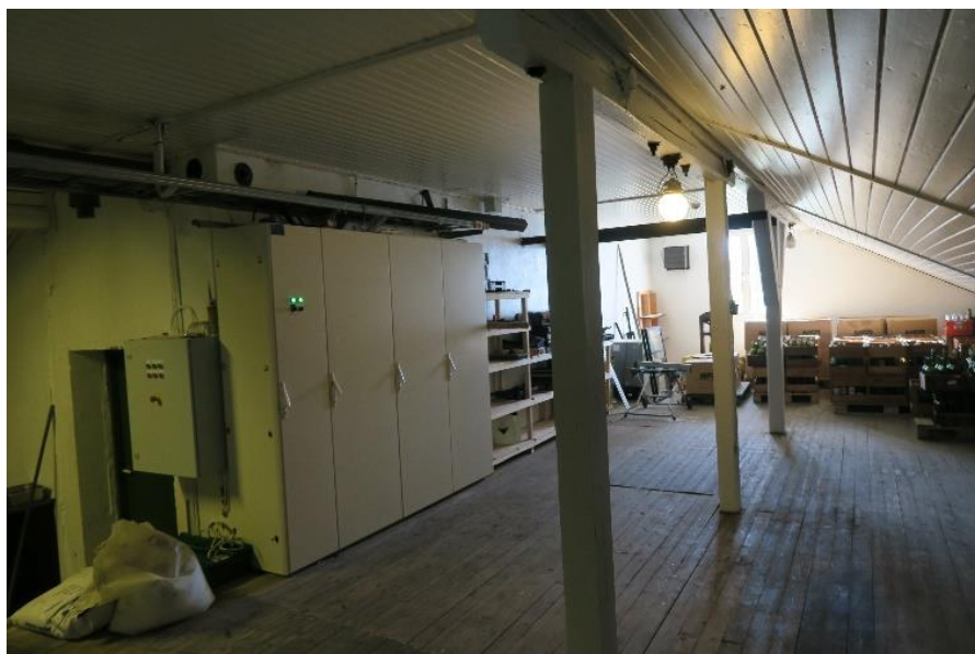
Tredje etasje, over Fyrhuset, med sikringskap.
