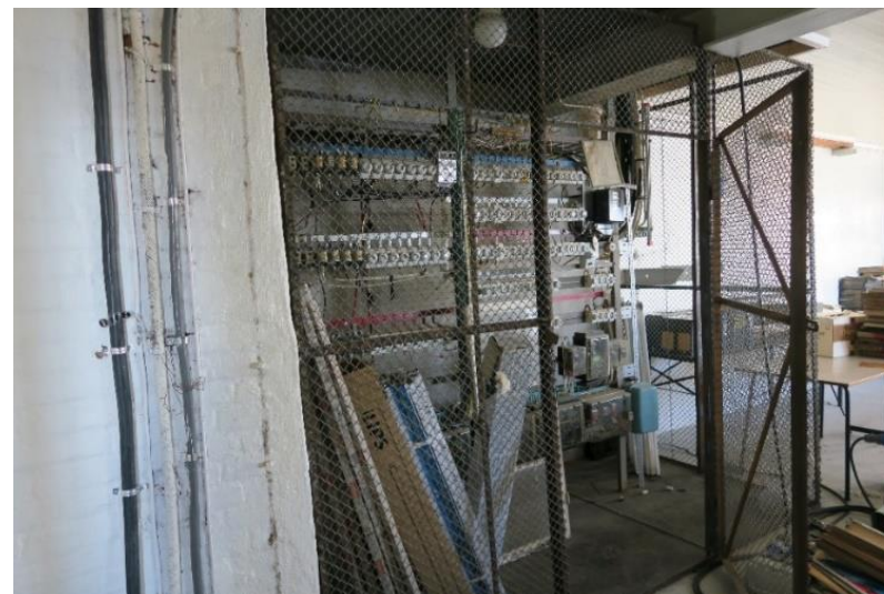
Sikringsskap på rommets østre vegg.
