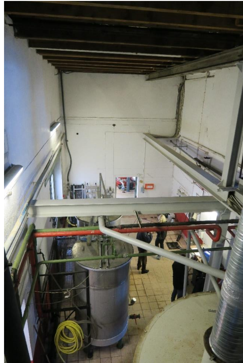
Gjæringsformeringsanlegget sett fra andre etasje og mot østre vegg.
