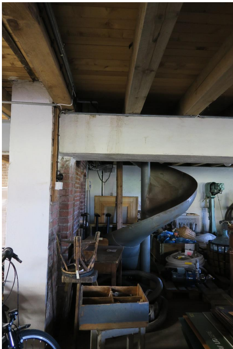
Sklie for kornsekker fra tredje etasje. Denne forbindes med sklien ned til første etasje. Teglsteinsveggen er tidligere yttervegg for bygget fra 1880.
