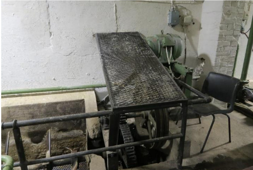
En utveksling overfører kraft fra motor til propellakslingen på vaskeren. Motoren overfører krefter til vaskeren via både reimer og tannhjul. Poenget med systemet: Det skjer en kraftig nedgiring av rotasjonshastigheten.
