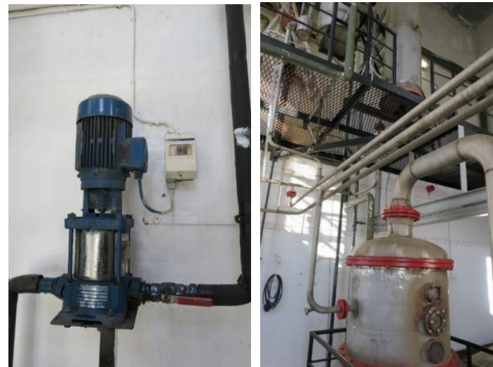
Tv. pumpe for kjølevann. Th. Detaljer av den minste av de to kolonnene.
