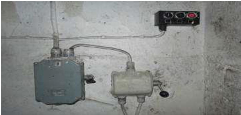
Detalj av brytere for å starte og stoppe potetvaskeren. Den svarte bryteren starter og stopper potetpumpa. Foto: Svein Arne Rudi, HFK
