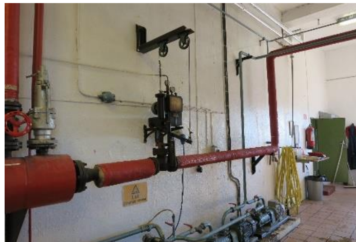
Dette er dampregulator for hoveddampen, svart instrument midt på veggen. Her reguleres damptrykket ned fra ti bar til seks bars trykk. Nederst på veggen, mot gulvet er pumpene for matevann som blir pumpet inn i fyrkjelen.
