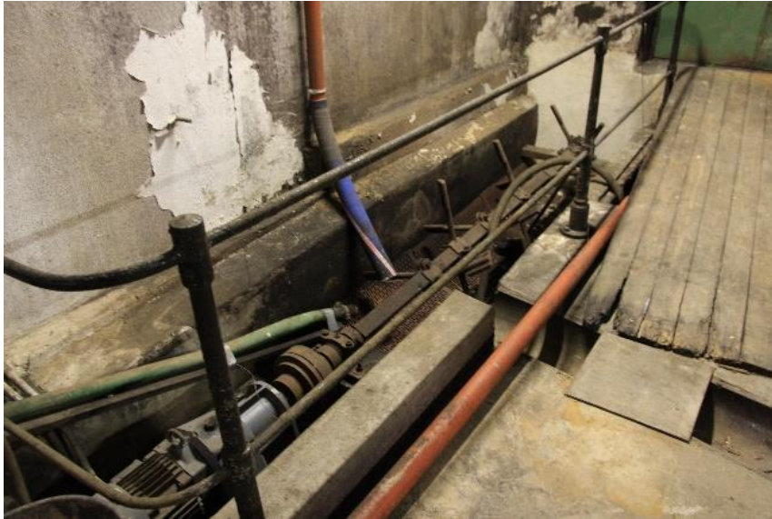
Vaskelinja for ensilering. I denne delen ble poteten som skulle ensileres vasket. Denne linjen er avstengt da produksjonen på Atlungstad ble rettet inn kun mot spritproduksjon. Vaskelinjen står fortsatt intakt. Ensileringskokerne er demontert og fjernet.
