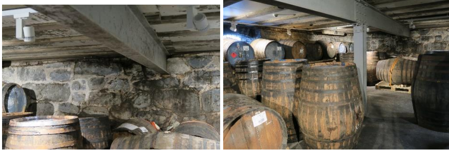
Bygg fra 1880. Fuktproblematikk også på nordre vegg.
