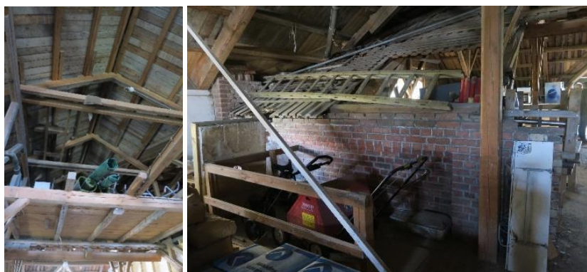
To. viser ny himling til bygget fra 1954. Th. tidligere yttervegg i teglstein til bygg fra 1880.
