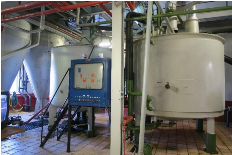
To kjeler til formesking. Kjele til venstre er fra 1960-tallet og kjele til høyre fra 1990-tallet.
