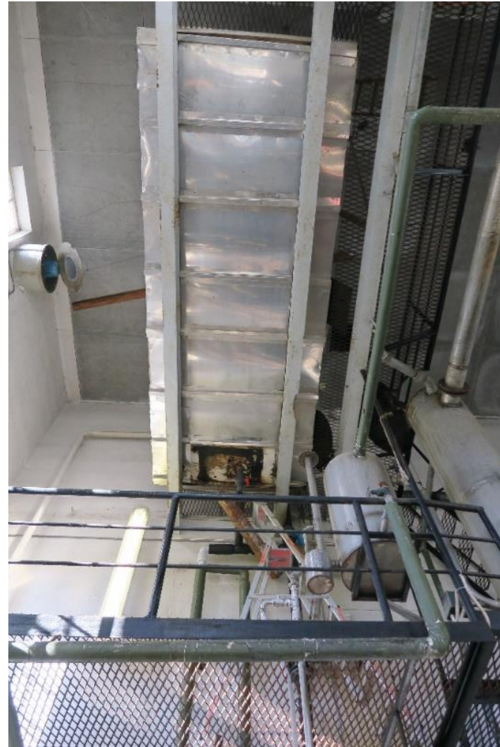
Sett opp mot øverste etasje. Der er det en tank for vann til kondensering og kjøling av spriten. Tanken hviler på to h-bjelker som er innstøpt i veggene.
