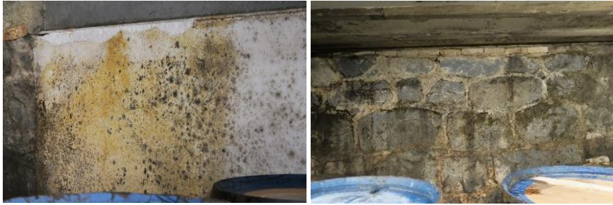
Fuktproblematikk i bygget fra 1880. Tv. vegg mot fyrrommet. Th. østre vegg.
