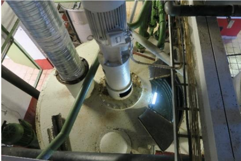
Kjele til formesking sett fra andre etasje.
