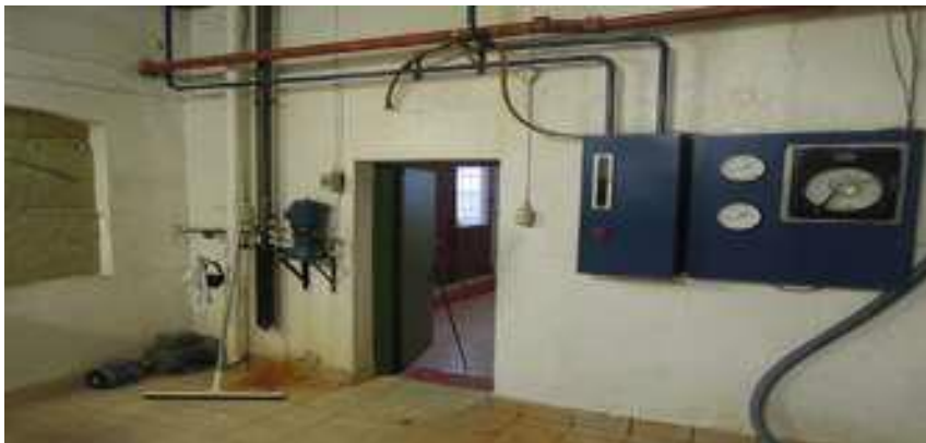
De blå boksene til høyre i bildet benyttes til avlesning av sprittemperatur. Pumpa til venstre for døråpningen ble tidligere benyttet til rengjøring. Denne er ikke lenger i bruk. Foto: Svein Arne Rudi, Hedmark Fylkeskommune
