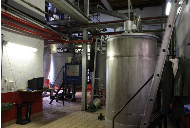
To plassert på fastmontert bord. To-en benyttes til overvåking av potetslipp til potetkoker i tredje etasje. Større løst inventar.
