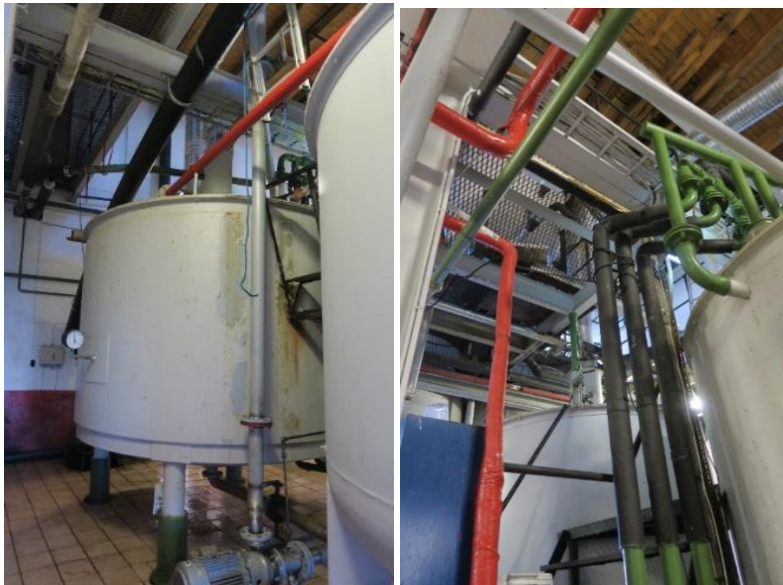
Detaljer fra kjeler og rørsystemer.
