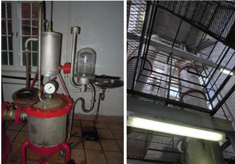
Tv. Kondensator for luttervoann. Th. Kolonnene stiger opp gjennom etasjene.
