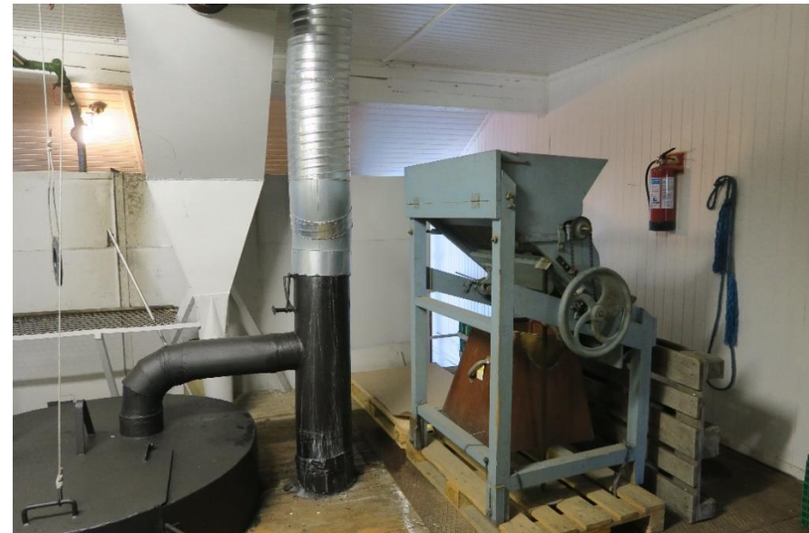
Toppen av Maarudkokeren/stivelseskokeren i tredje etasje.
