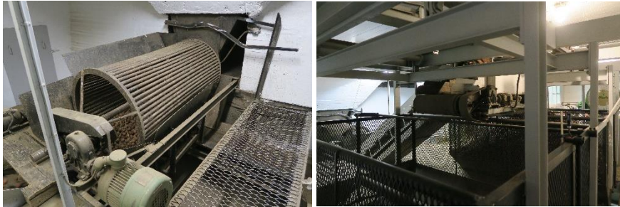
Tv. potetene kommer inn i et hull i veggen og tromles. Th. potetene transporteres videre på et samleband til vektkurvene.
