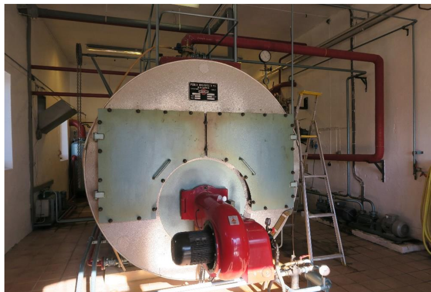
Fyrkjelens søndre vegg. Fyrkjelen er norskprodusert fra 1989 (Peder Halvorsen), og har en kapasitet på 4 tonn damp i timen. Den fyres med fyringsolje.
