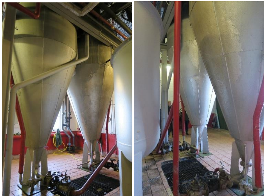
To potetkokere med ventiler under. De er plassert i formeskerommets søndre del.
