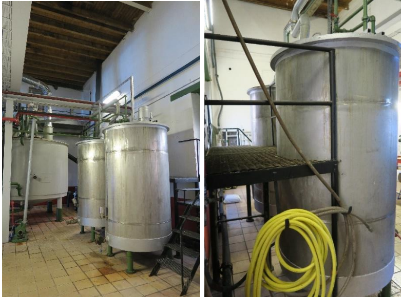
Det gamle gjæringsformeringsanlegget som står ved østre vegg. De to tankene er ikke i bruk. Bildet til høyre er sett fra nord.
