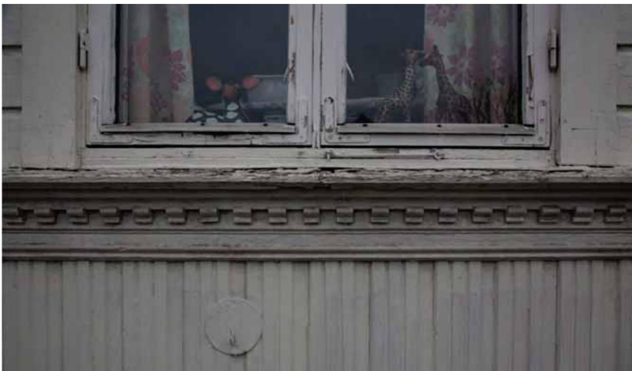
Klossebord på fasade i overgang mellom kledningstyper. Sanitetsgården, Sjøgata 14.
