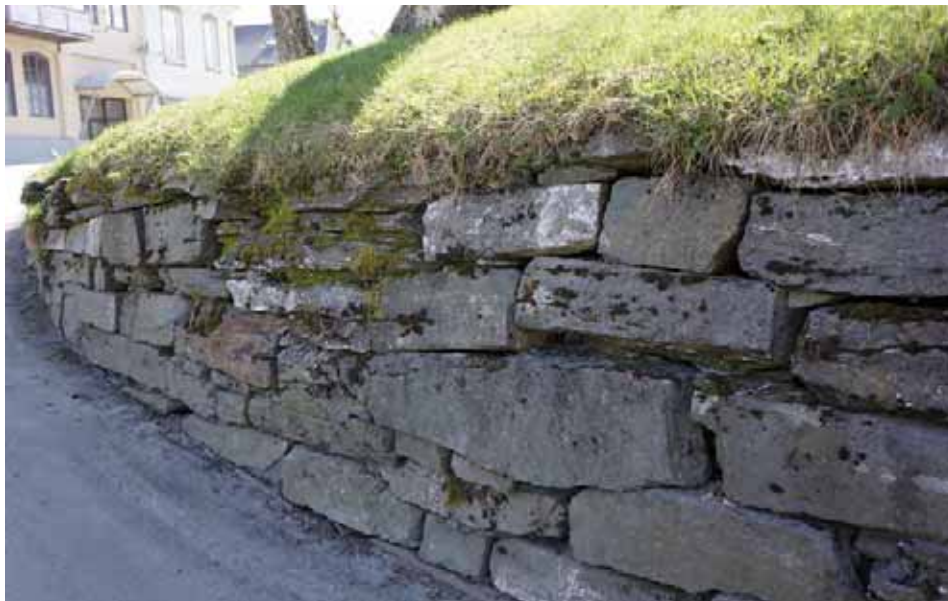
Mur av naturstein, gir et kvalitetstilskudd til uteområdene. Dette er kirkegårdsmuren i Levanger
