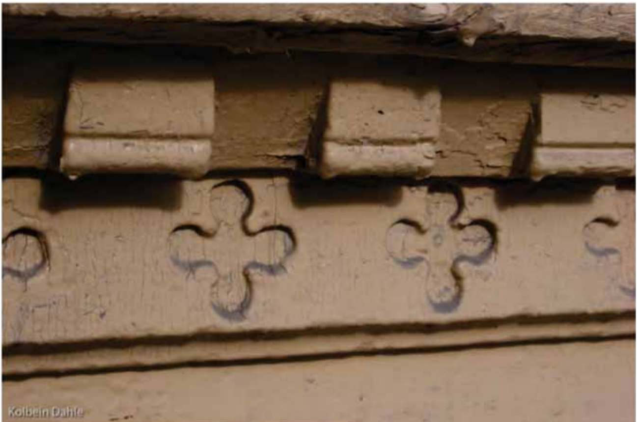
En original bygningsdetalj, avslutningslist på horisontalt bånd fra Kirkegata 11 med merker etter tidens tann er uerstattelig, fordi en ikke kan gi en kopi originalens alder, og merker etter skiftende tider.
