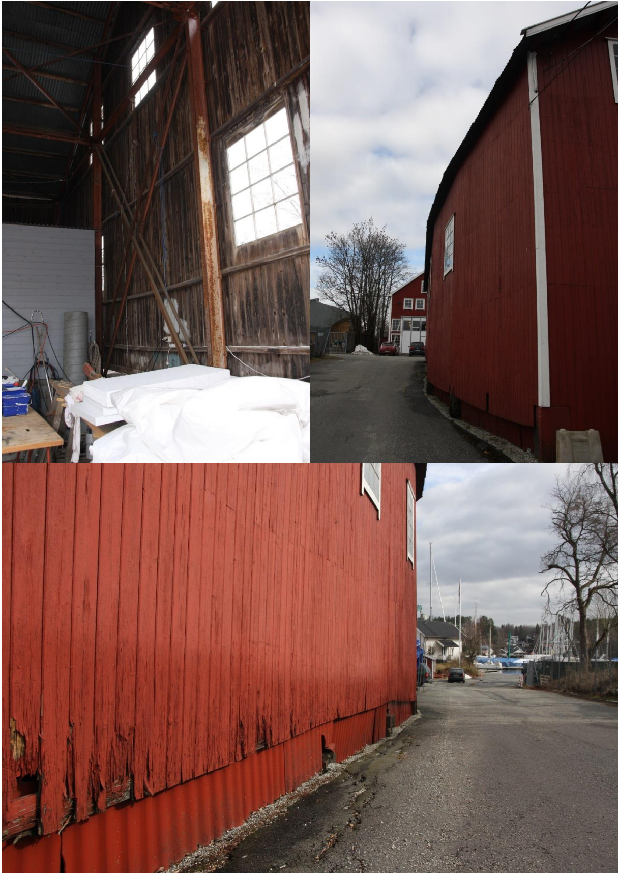
Båtskur 1/verkstedhall: Reisverk i stål, yttervegg mot sør er tomtetilpasset, råteskadet panel på yttervegg mot sør. Foto: HAG/RA
