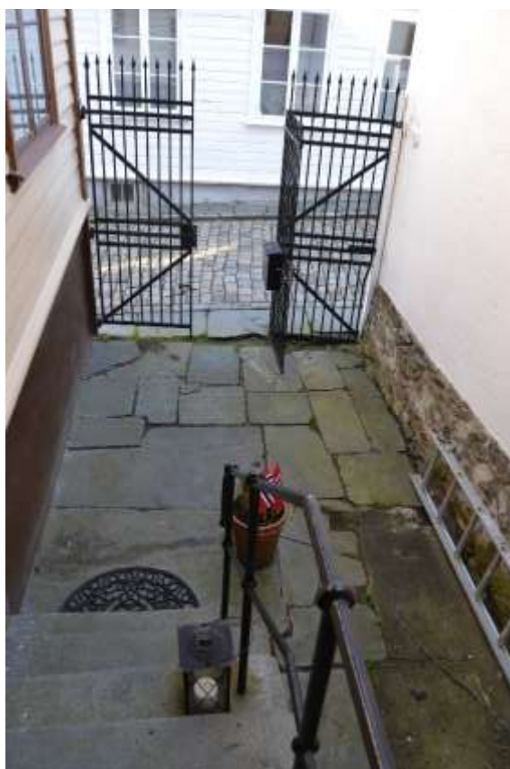
Foto fra hovedtrappa og ut mot Øvre Strandgate. Trappa og helleleggingen er original, men restaurert. Rekkverket på trappa er nytt fra restaureringen.
