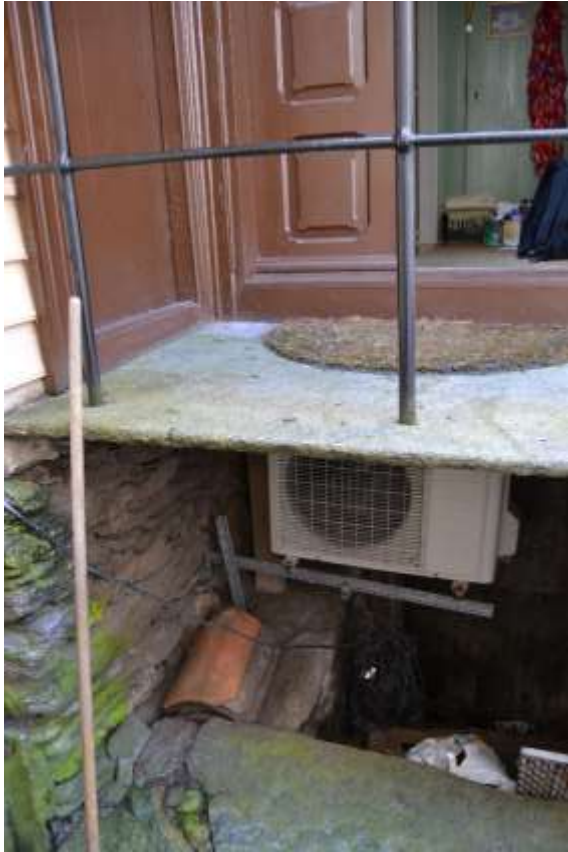
Hovedtrapp og dør til 1. etg/dør til uthus. Under trappa er det en kjellerhals, kanskje brukt for nedkast av brensel mm? Her er det satt inn en varmepumpe.
