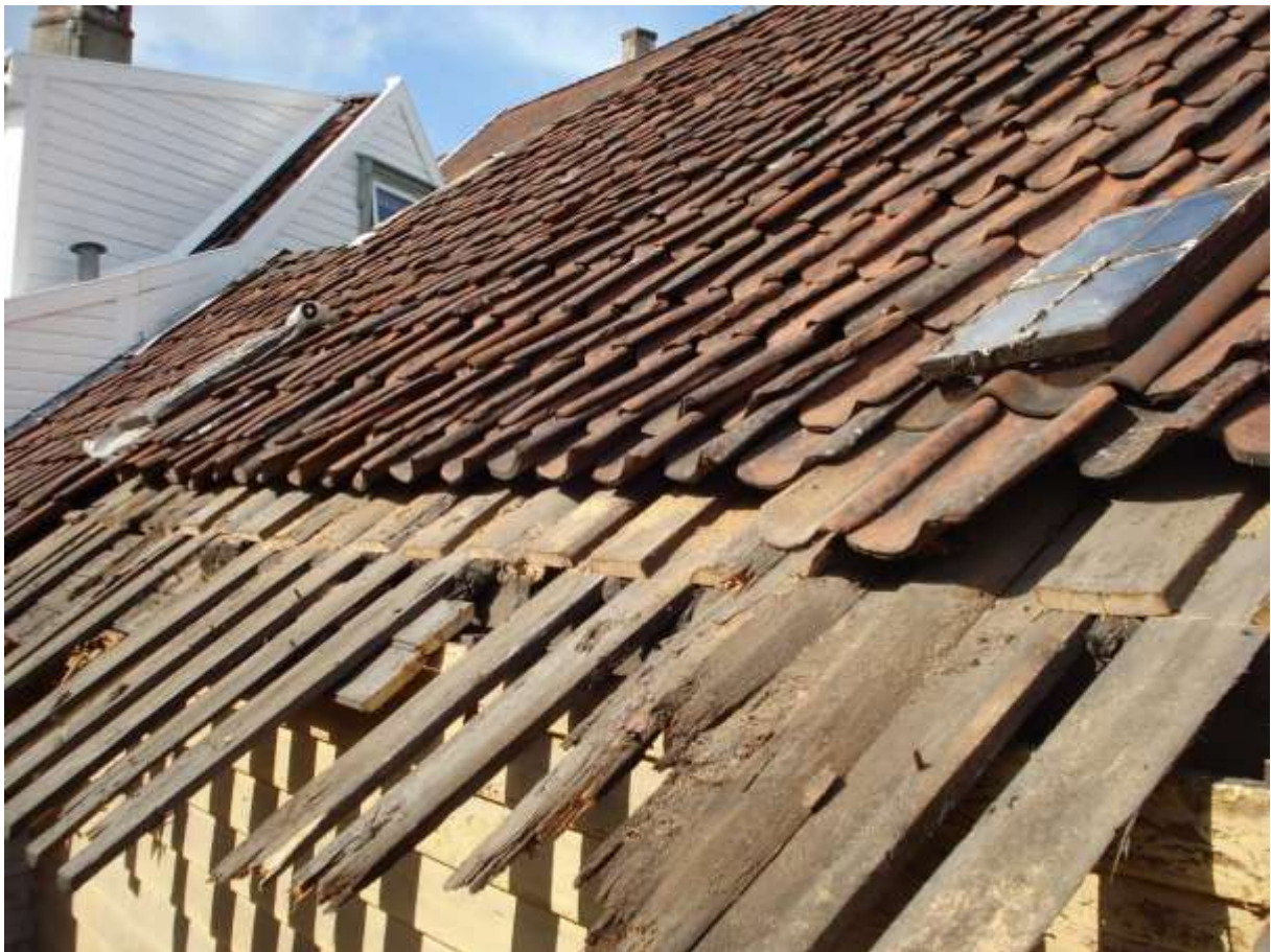
Taktrao og raftet med råteskader
