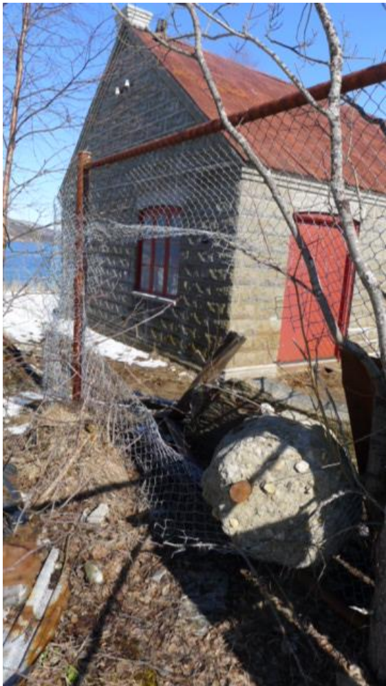
Deler av nettingen i den nordligste delen av gjerdet er ødelagt.
