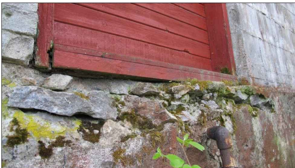
2012: Utfall i grunnmuren under døra på baksiden, trolig resultat av vann/frost.
