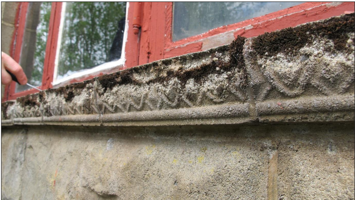
De støpte mønsterdetaljene på de støpte sålbenkene under vinduene bærer preg av slitasje.
