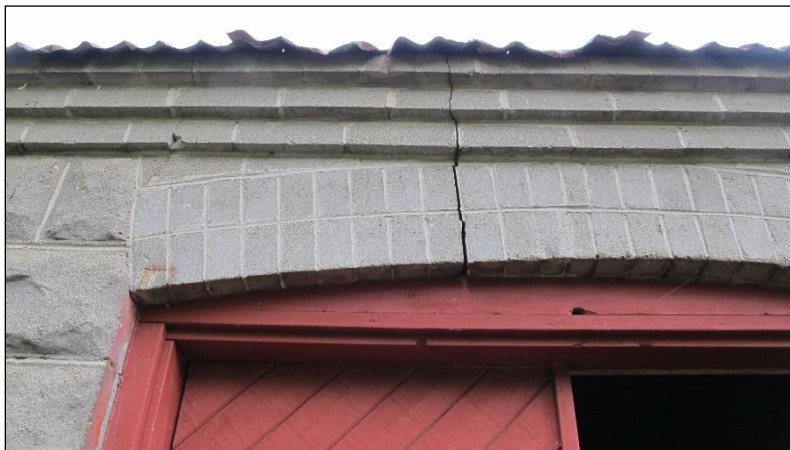
Sprekk over hovedinngangen.
