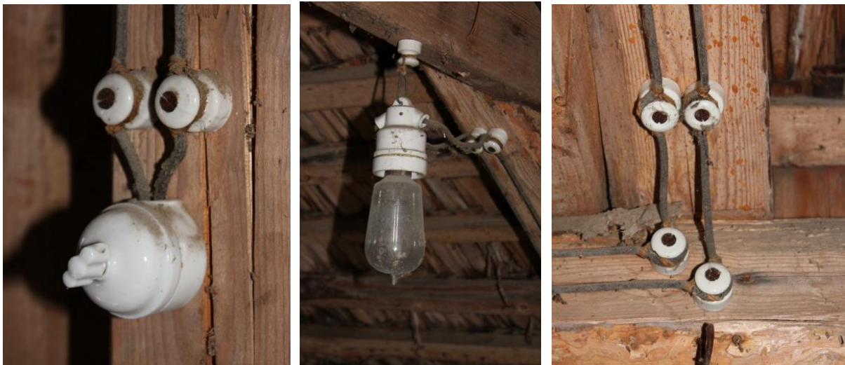
Elektrisk anlegg. Foto: Bård Langvandslien, Riksantikvaren
