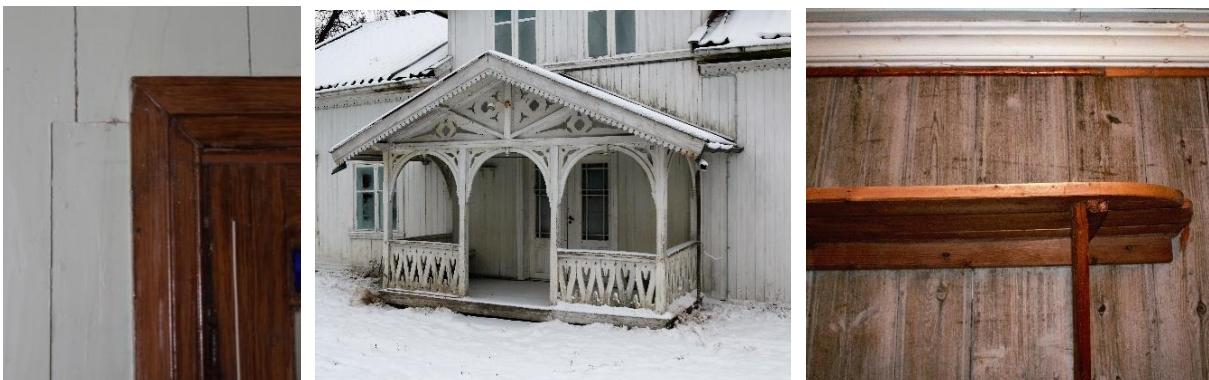
Panel i stuegang rundt verandadør, veranda og synlig ytterpanel i dagens spiskammers. Alle foto: Bård Langvandslien, Riksantikvaren
