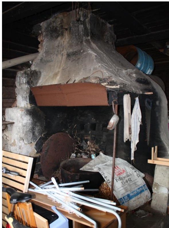
Grue i bryggerhus. Foto: Bård Langvandslien
