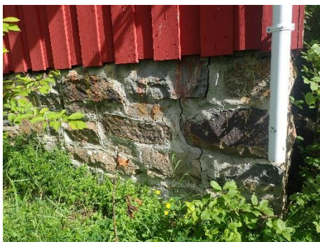
En sprekk i sørøstre hjørne som bør følges med på.
