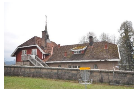
Nordfasaden. Trefagsvinduet er nyere, nyere gradrenner i kobber, mulig opprinnelig takopplett. OFK 18.05.17.
