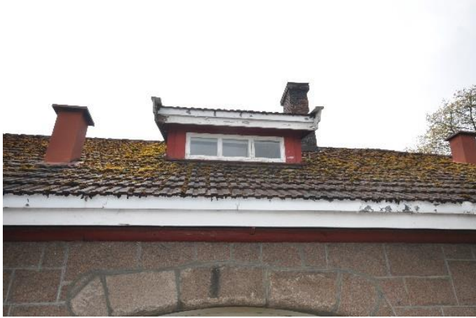
Her sees tydelig endringer i overdekningen og vitner om nyere vindusåpning i muren. OFK 18.05.17.
