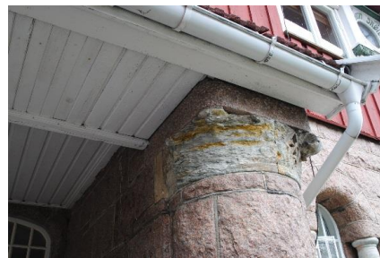
Kleberstein i kapitel forvitrer. Søndre fasade ved inngangsparti. OFK 18.05.17.
