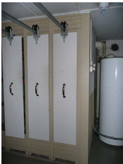
Tørkekeskap i kjeller. Opphavsrett: Statsbygg.
