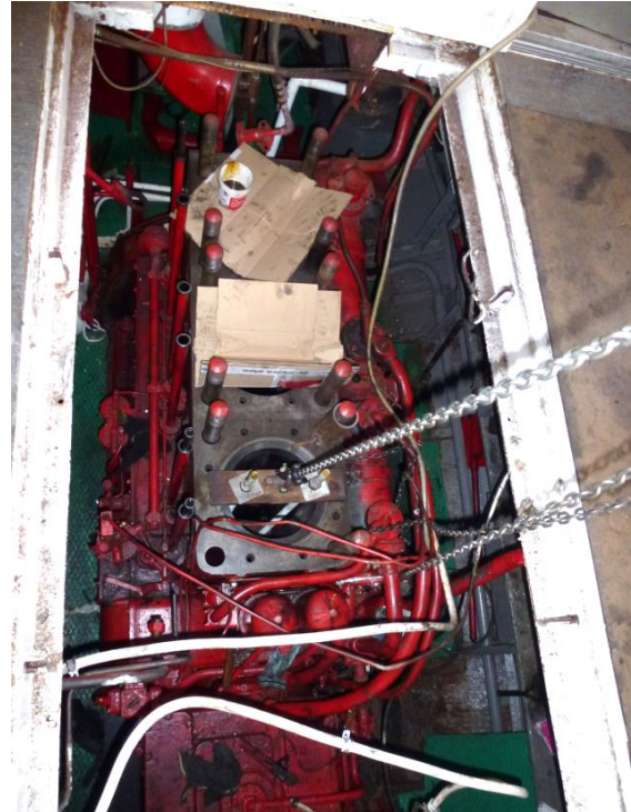
Maskintoppen må byttes på grunn av frostskaade. Foto Erik Småland, Riksantikvaren.
