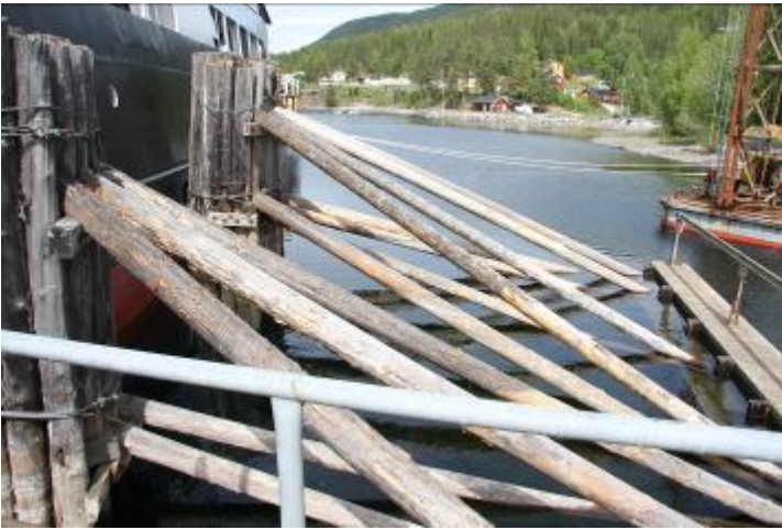
Fergeleie Tinnoset, trepæler i forlengelsen av østre fendervegg. De hviler mot et betongfundament under vann.
