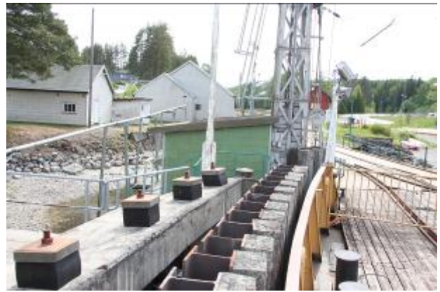
Fergeleie Tinnoset, nordre fendervegg i betong. Putene sett ovenfra.
