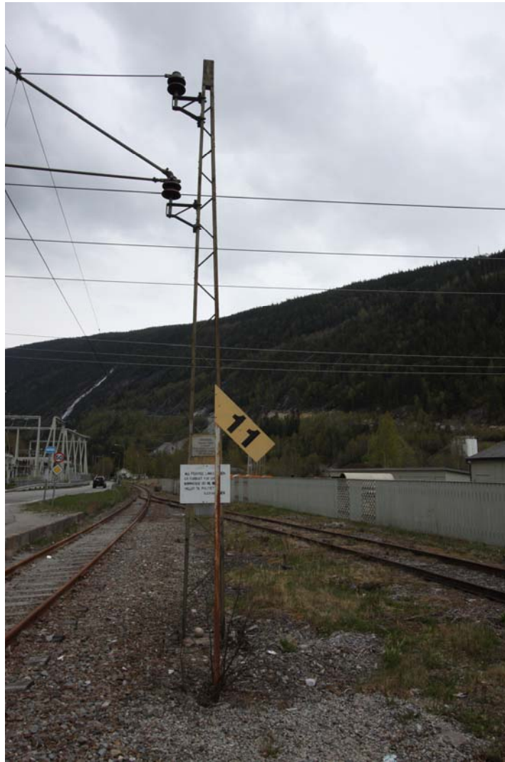
Mast for kjøreledning og skilt for hellings-/stigningsgrad.
