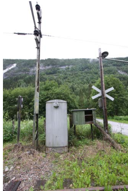
Koblingsstasjon for lys og bom.
