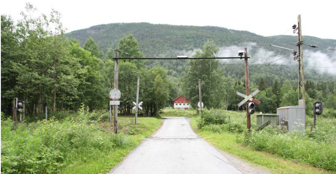
Planovergang med lyd- og lyssignal.
