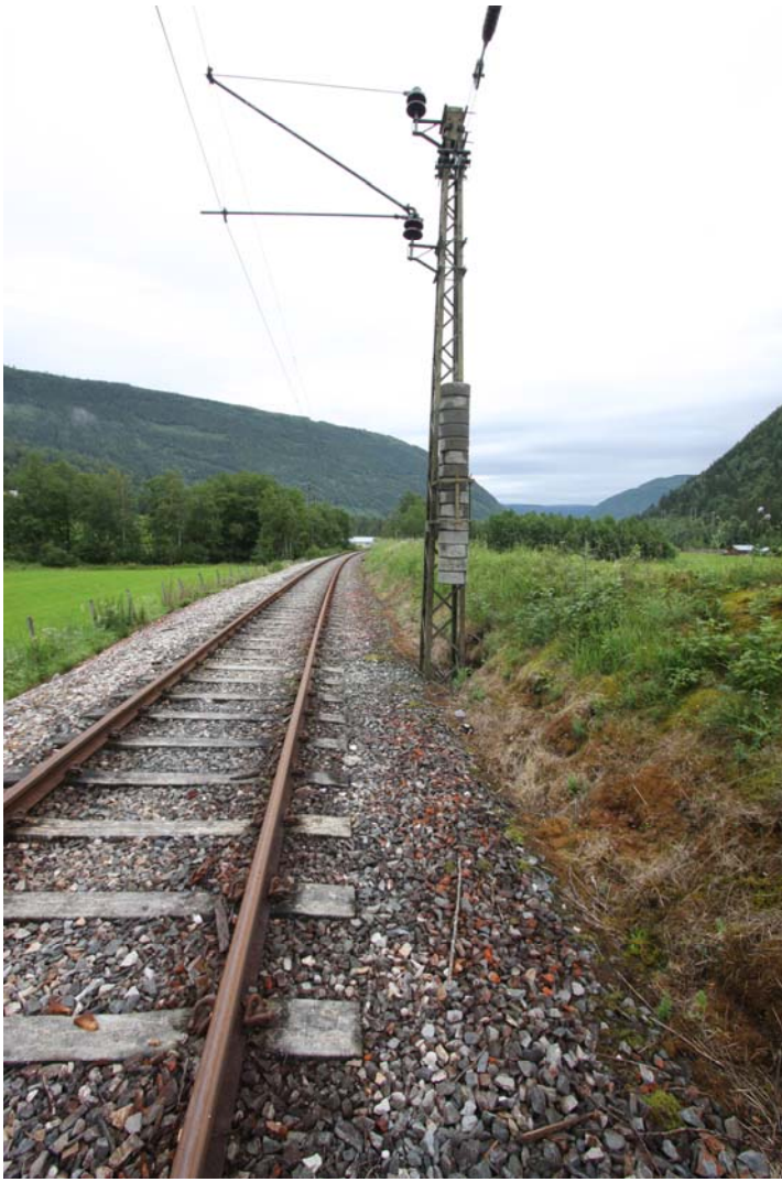
Parti med mast for kjøreledning og skinner med betongsviller.
