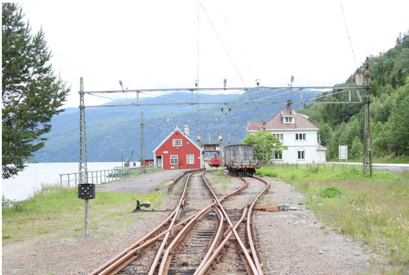
Innkjøring til Mæl stasjon med skinner og tresviller, sporvekselsignal for kryssveksel og sporveksel, master og åk for kjørelledning med lysarmatur.
