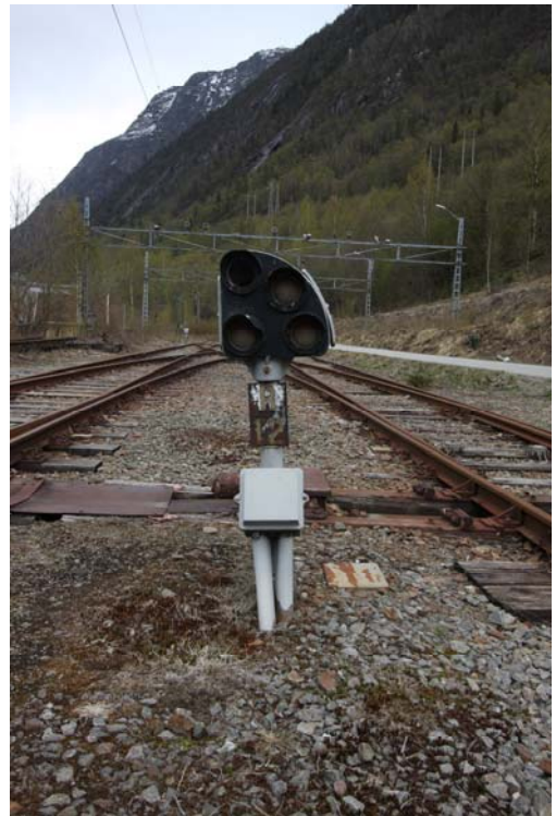
Dvergsignal, Rjukan stasjon.
