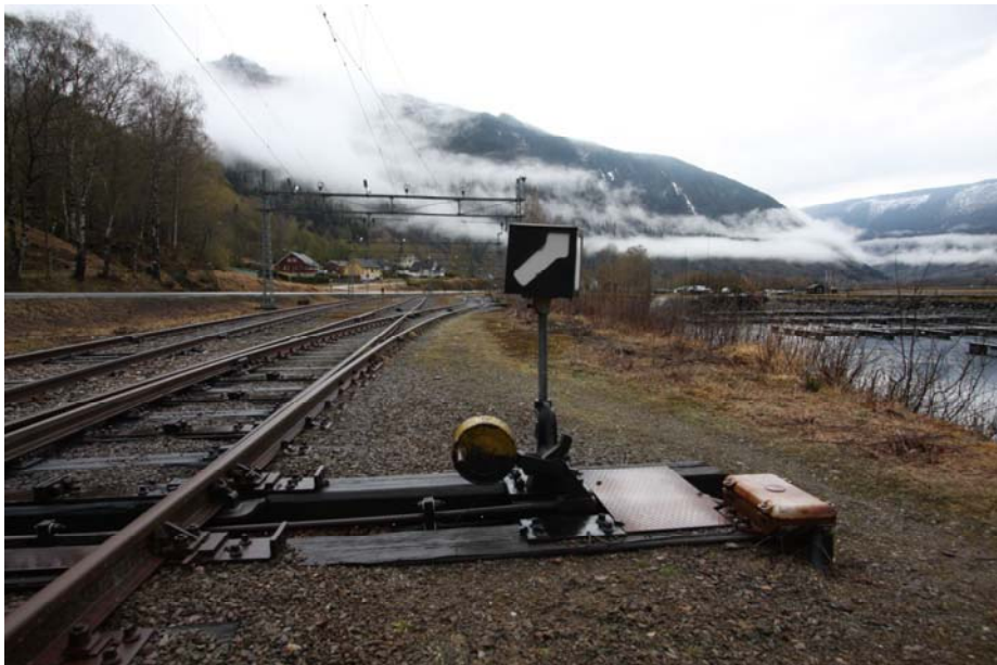
Sporvekselsignal (anviserkasse) og manuell pensetol med lodd ved Mæl stasjon.
