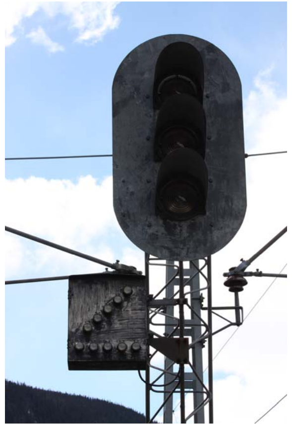
Hovedsignal med høyt skiftesignal ved Mæl stasjon.
