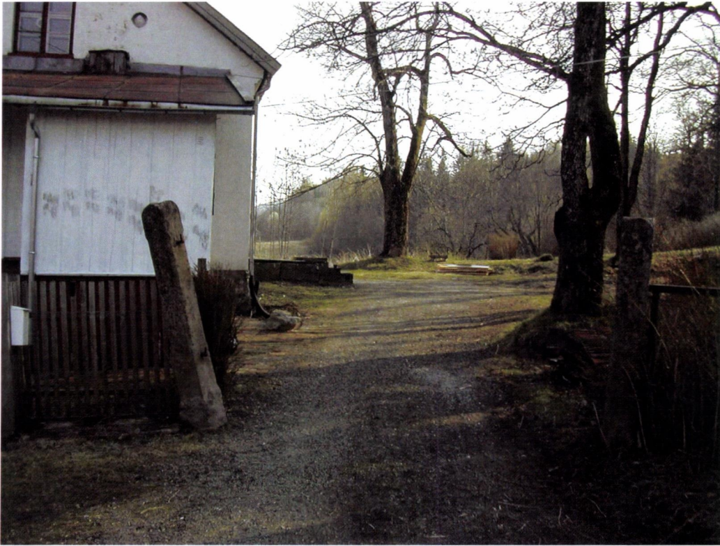
Utgangspunktet med skjeve stolper som telen har satt ut av posisjon.
