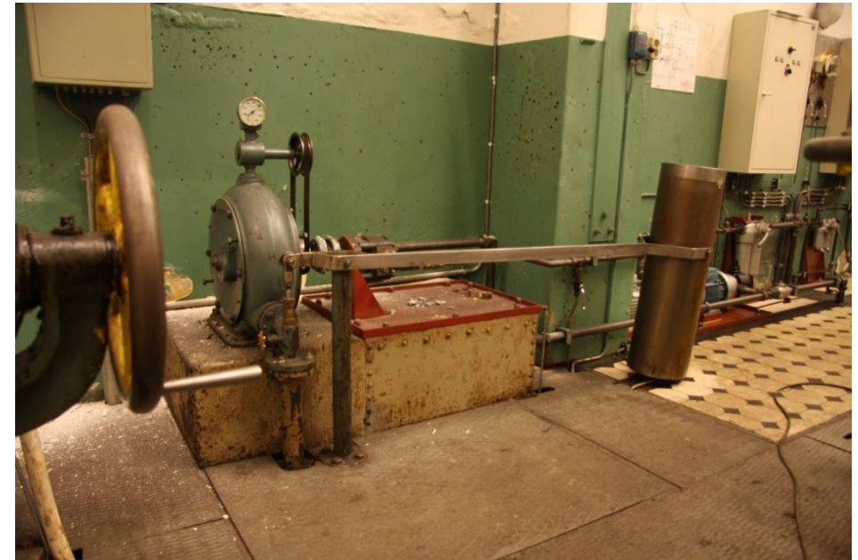
Liten vannturbin slår inn når oljetrykket blir for lavt.
