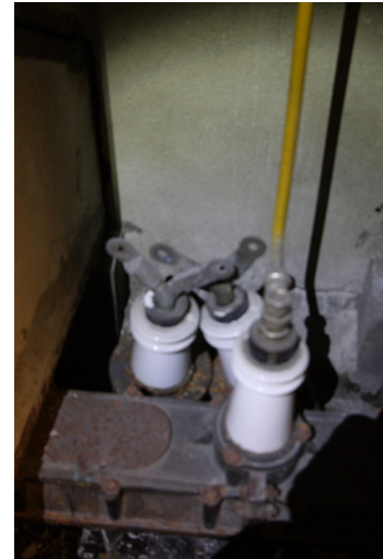
Spenningstransformatorer er demontert og ligger løse i en celle.
