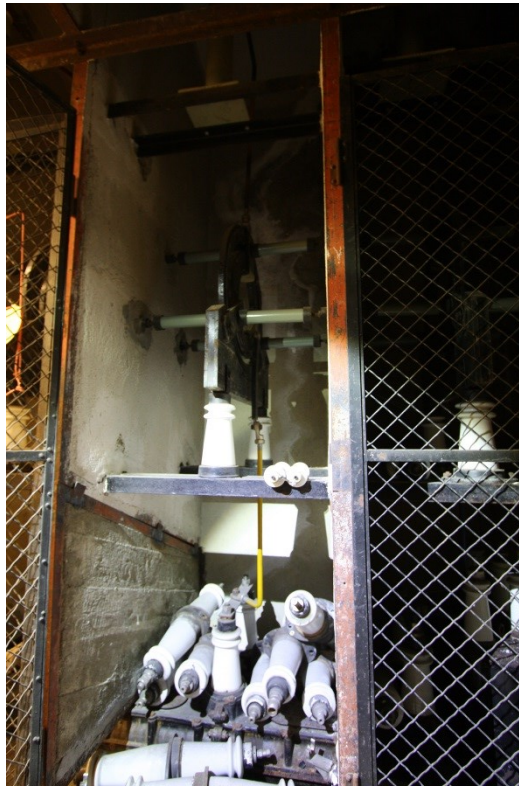
Celle med drosselspole og løse strømtransformatorer med porselensisolatorer.
