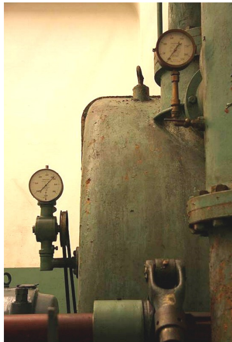
To målere som viser trykk og hastighet.
