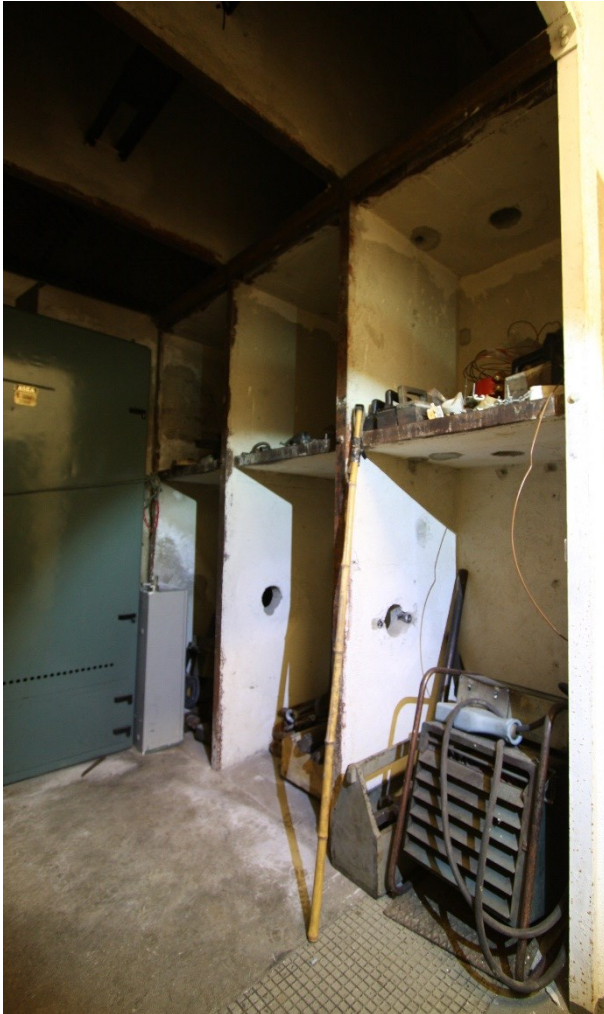
Tre tomme celler i midtseksjonen har vært for spenningstransformatorer som er bevart løse.
