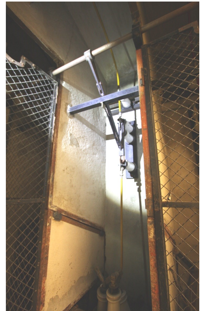
Celle med skillekniv på nordveggen. Muffer for overføring ligger i bunn.
