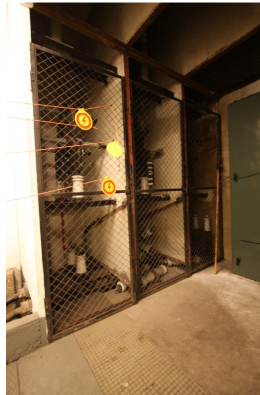
Tre celler for drosselspoler og strømtransformatorer.
