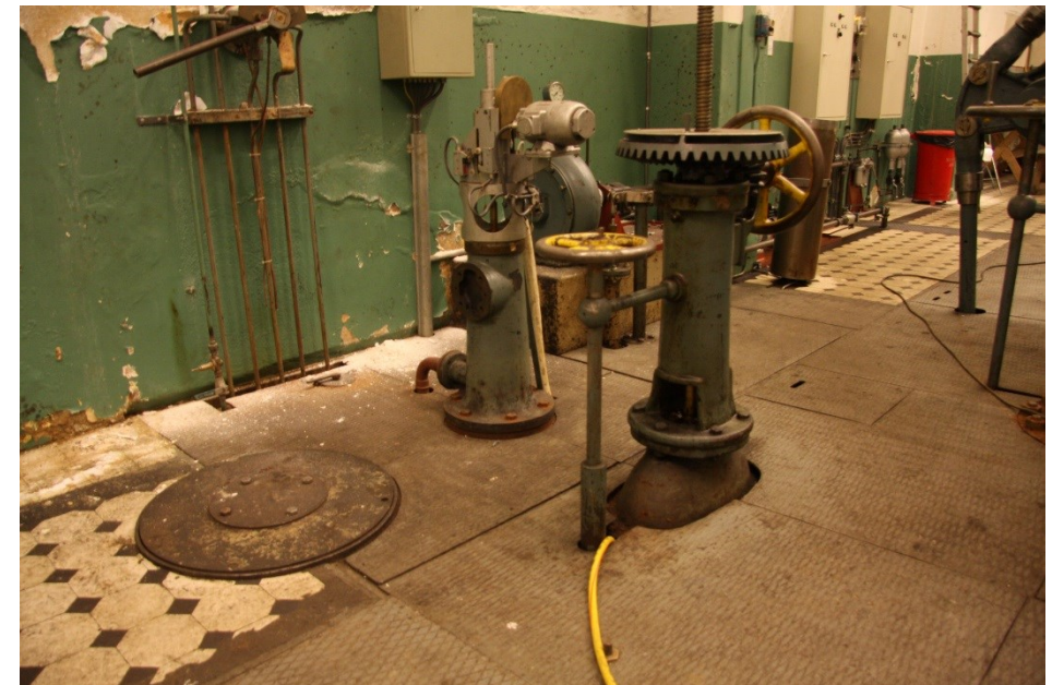
Storventil inn mot turbin.
