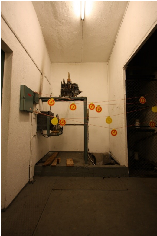
Muffe inn i instrumentrommet fra maskinhall.
