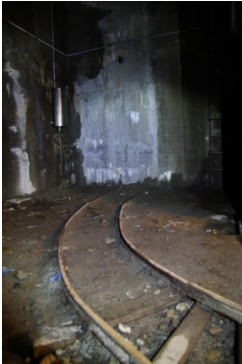
Trallebanen ender i heissjakten.
