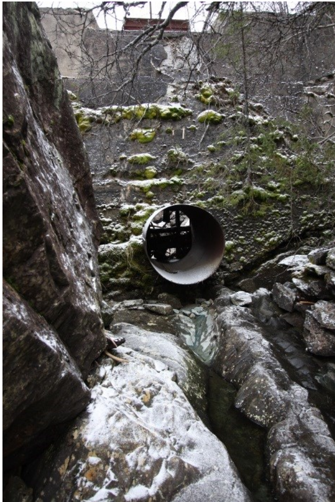
Inntaksdam, rest av klinket rør (16.3).
