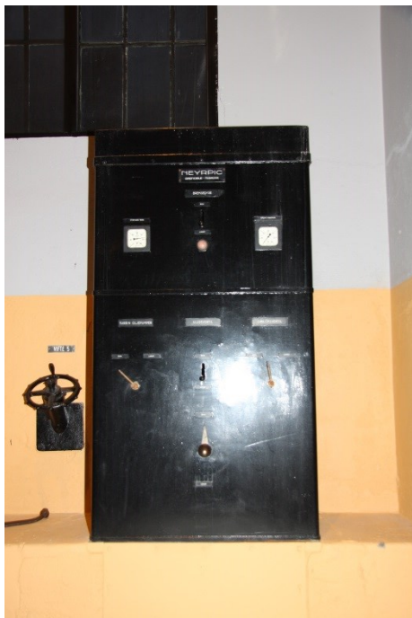
Tilhørende styrings- skap for Neypric- turbin nr. 5.
