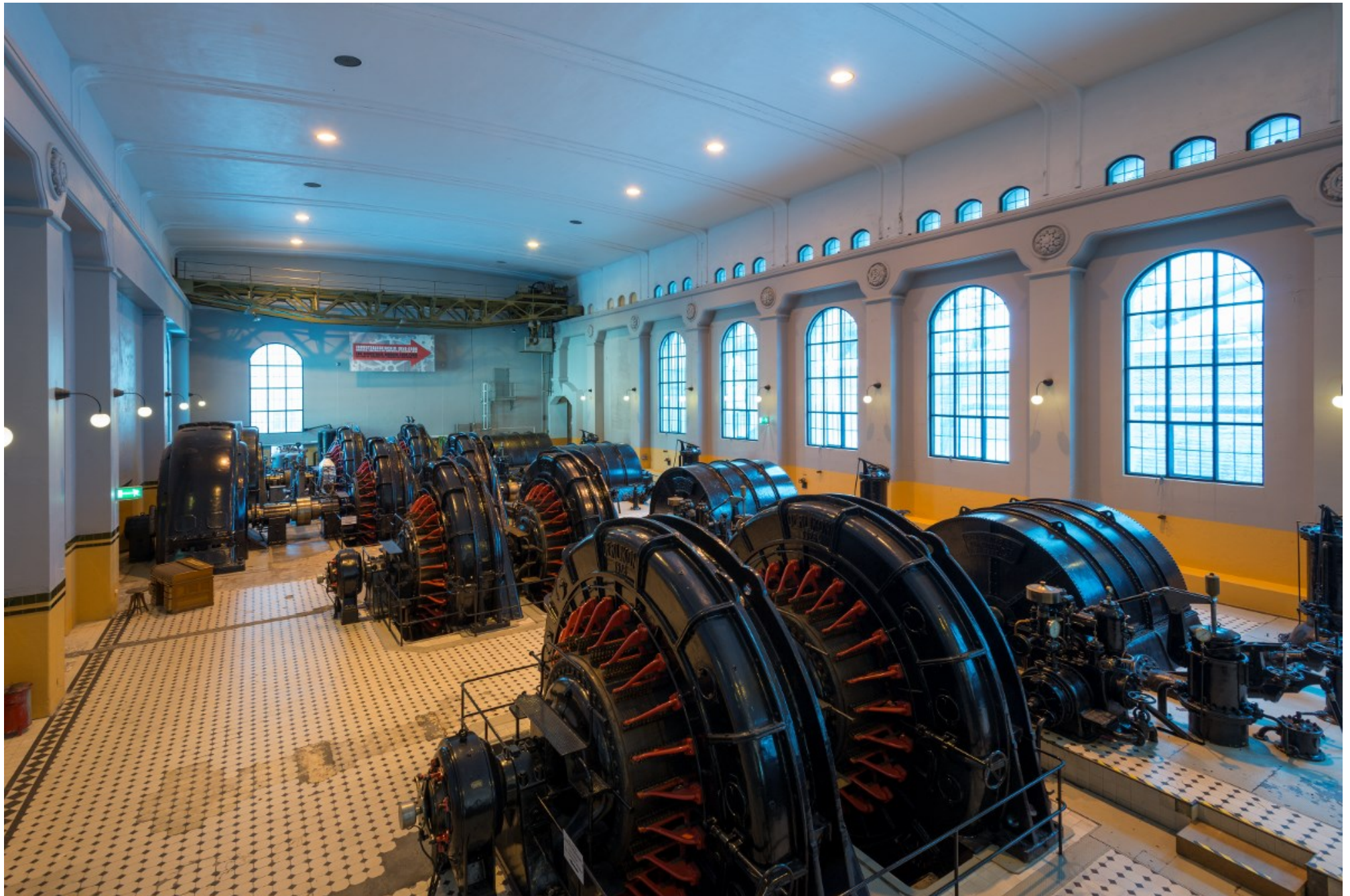
(12.3) Maskinhallen med aggregat 5-10. Traverskran ses opp mot taket lengst borte. Aggregat 9 og 10 ses lengst borte med en ekstra generator hver. Foto: Per Berntsen
