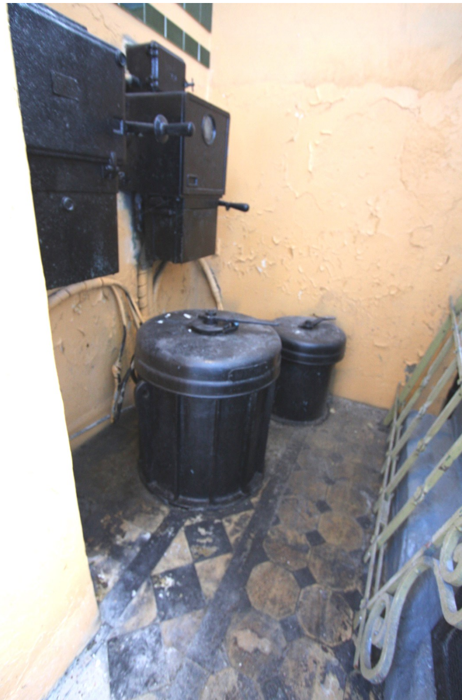
Strømskap ved østre endevegg.
