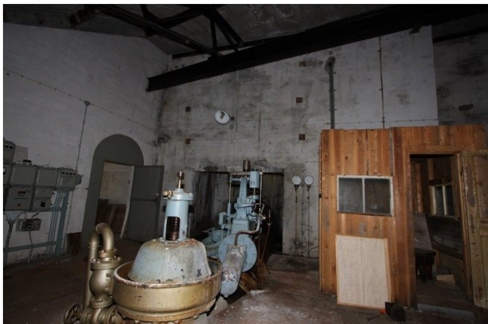
(10.2.) Ventil nr. 11 og vaktbu. Dør til inngangsrom bak.
