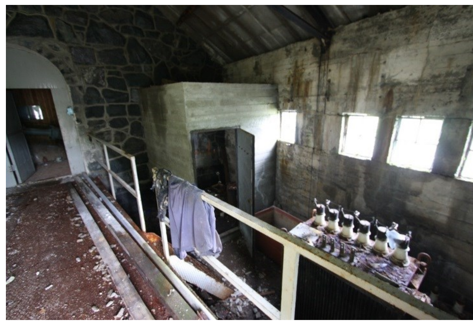
(10.1.) Inngangsrom i tilbygg fra 1912 med transformator og egen bod hvor den sto.
