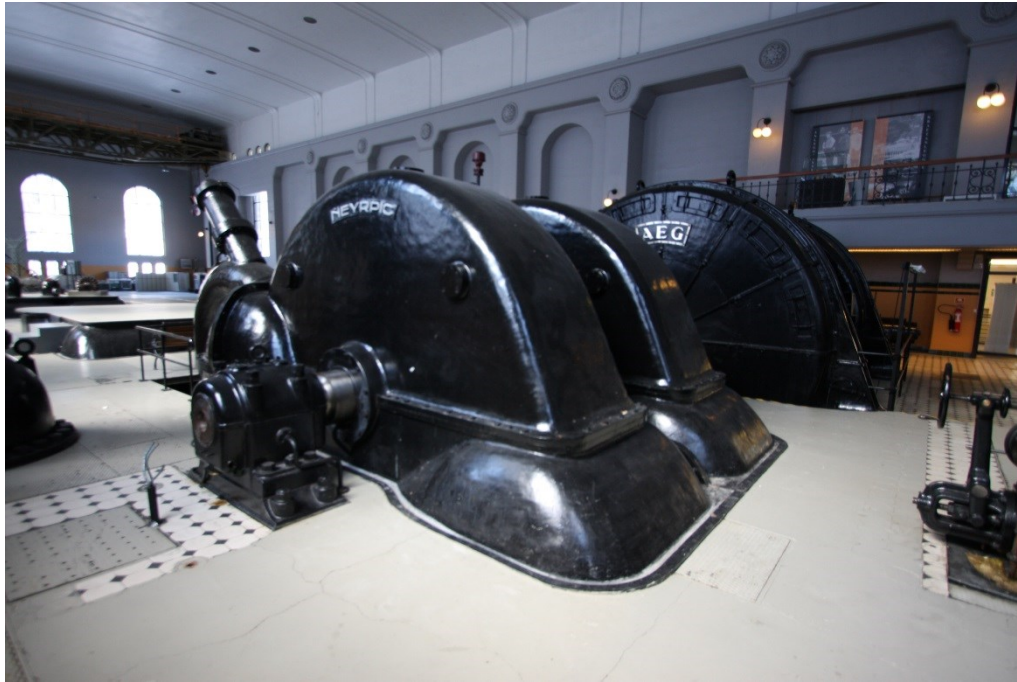
(12.3) Aggregat nr. 5 med turbin fra Neypric 1956 i front og generator fra AEG bak.
