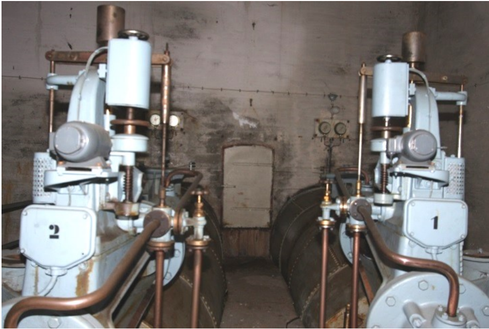
(10.3.) Ventil nr. 1 og 2 med motor (grå) på plass. Målerne ses på veggen bak.
