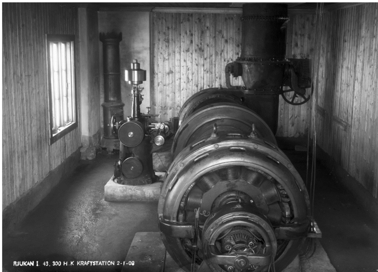
Interiøret i Kvernhusfossen kraftstasjon i 1908, straks før utvidelsen til to aggregat. Foto: Norsk Hydro
