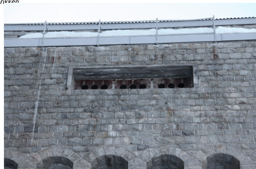
Hull i fasaden til kraftlinjer for overføring av strøm.
