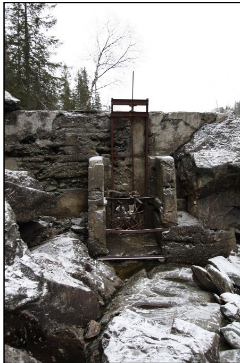
Inntaksluke med rør.
