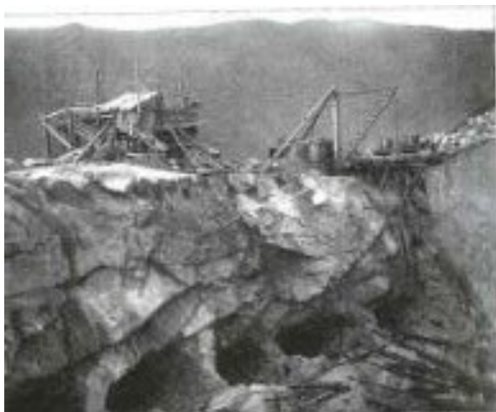
Fordelingsbassenget under bygging. Vi ser tunnelåpningene hvor to og to rør ble satt inn. Foto: Norsk Hydro
