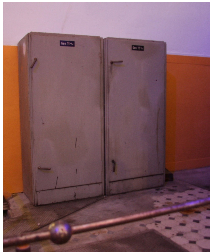
Skap for instrumentering til generatorene fra 1952.
