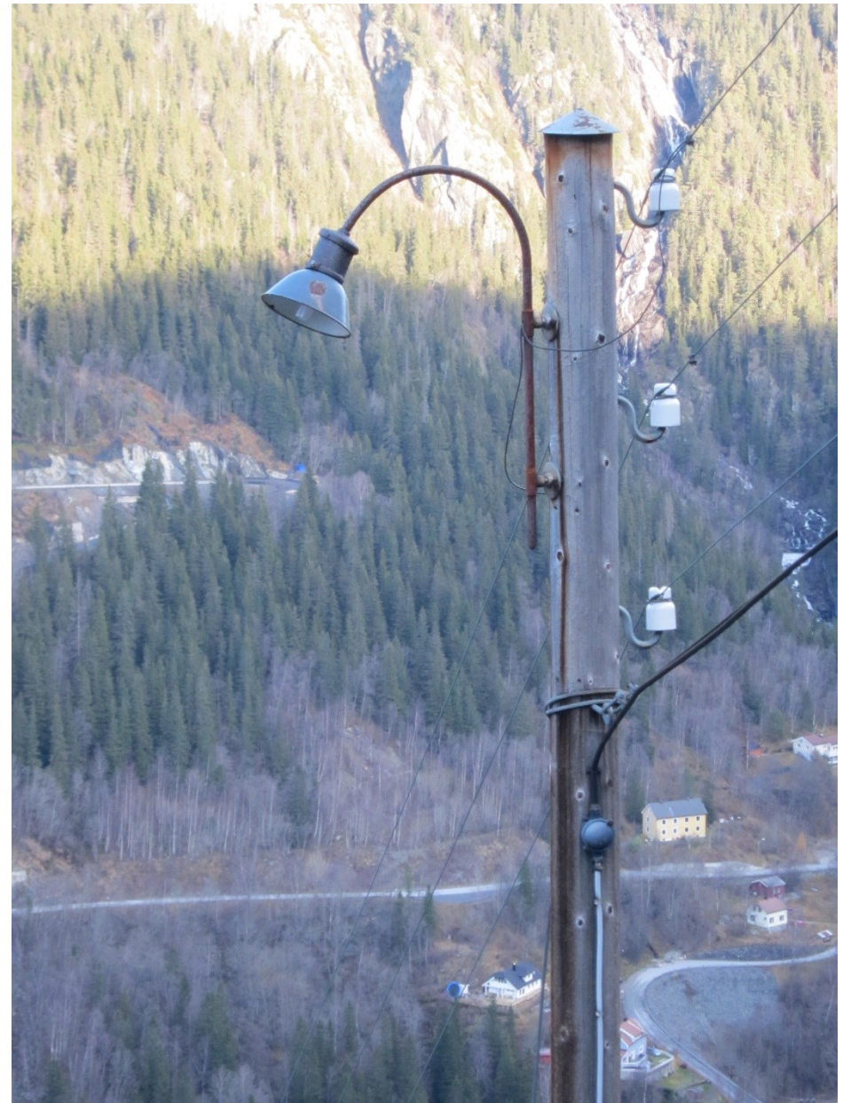
Lyktestolpe (11.5) ved rørgatas trapp og trallebane. Opprinnelig glasskuppel er knust på denne stolpen. Foto: Leif Ek.
