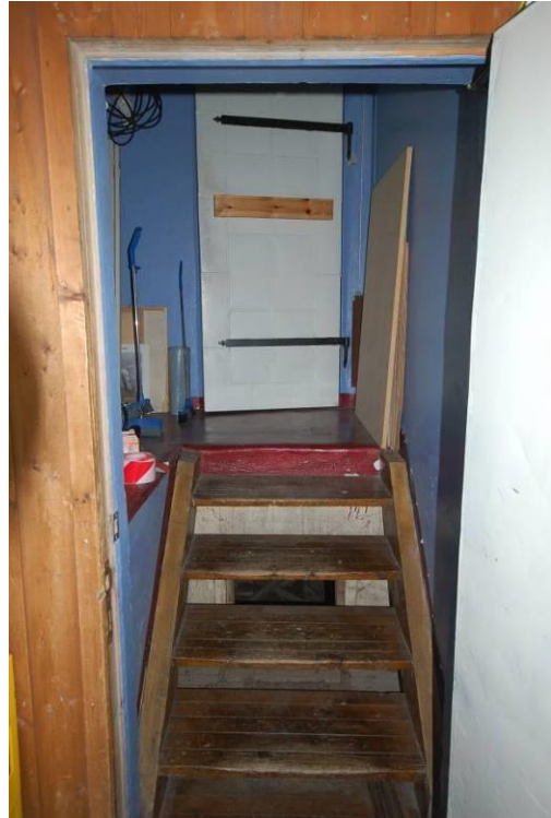
Figur 22 Dør og trapp opp til teknisk rom. Den innerste døren går inn til maskinrom. Foto: Magnhild Apeland
