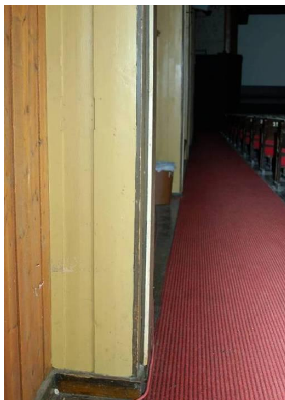
Figur 30 Synlig merke etter ringeklokke i panel. Foto: Monica A. Rusten
