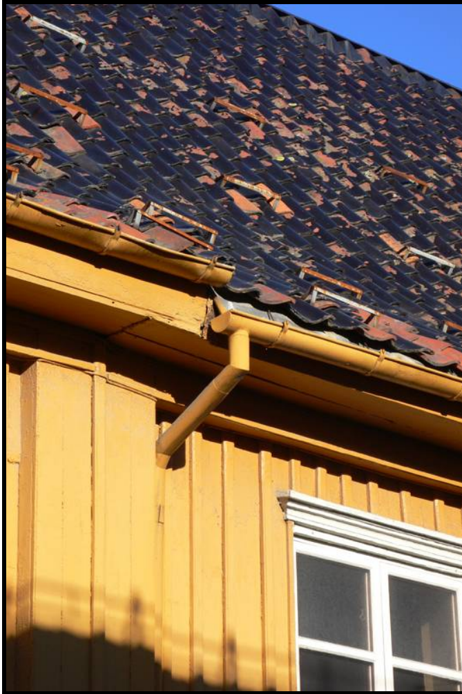
Knekk i taket ved overgangen mellom bygningsdelene
