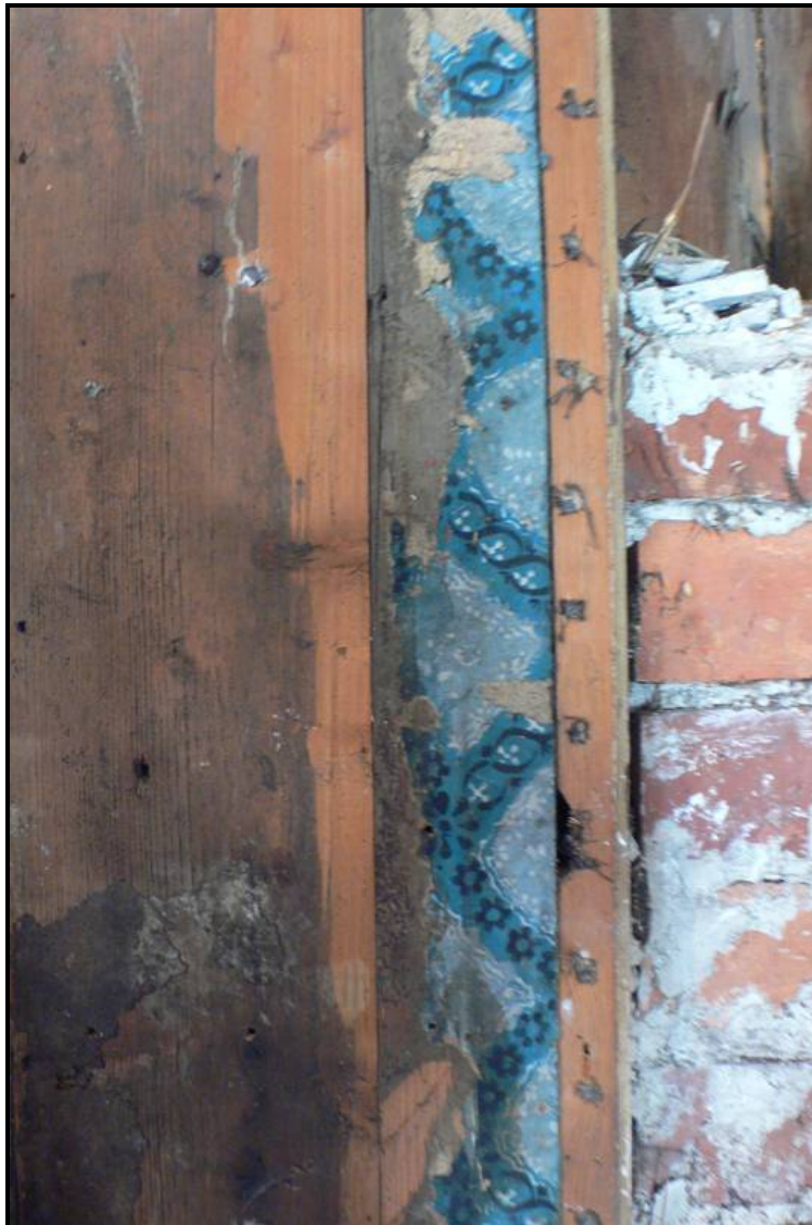
Tapetrester funnet ved siden av et skjult vindu i R108.
