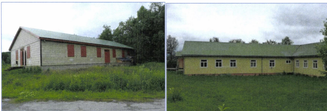
Både rundt isolatbrakka og hovedbygningen vokser gresset vilt.
