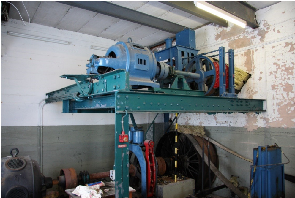
2.1 Maskinrommet med en 50 hestekrefters elektrisk vekselmotor fra Siemens (2.1.1) under og 22 hestekrefters reservemoter med eget reservedriftsmaskineri på stativ over (2.1.2). Opprinnelig ble banen driftet herfra med dette maskineriet, men ble avløst av en moderne motor på nedre stasjon i 1990-91.
