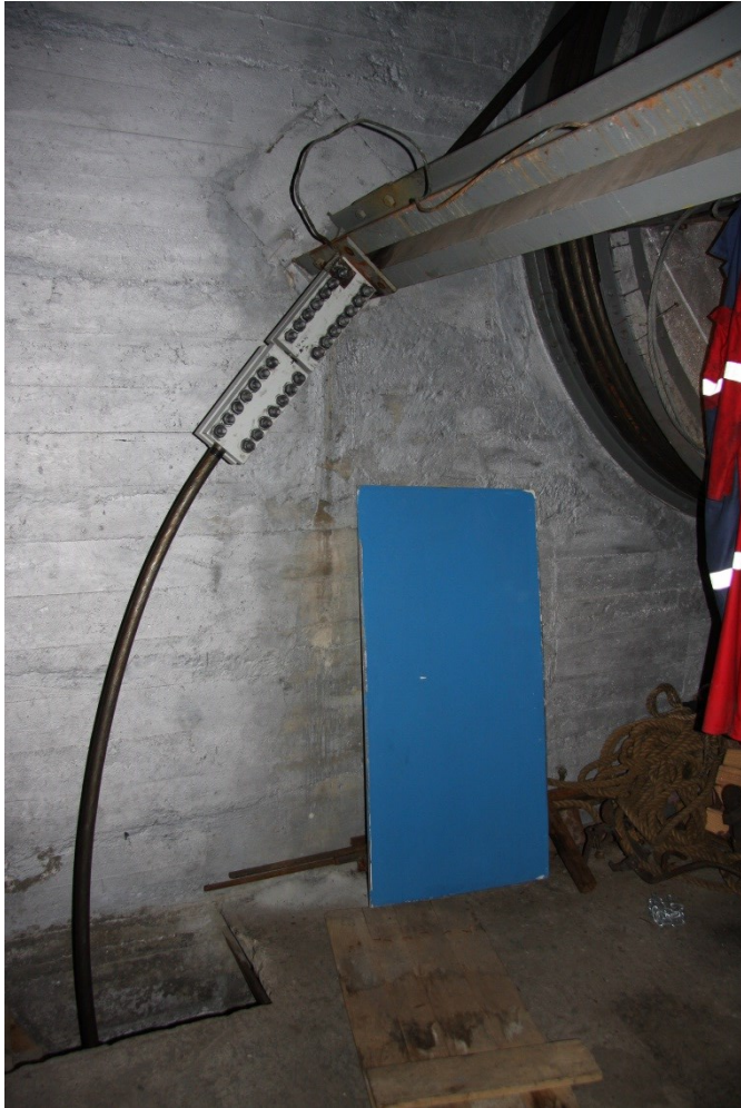
2.4 lagerrom med reservetau som går ned i hjul i eget underliggende rom.
