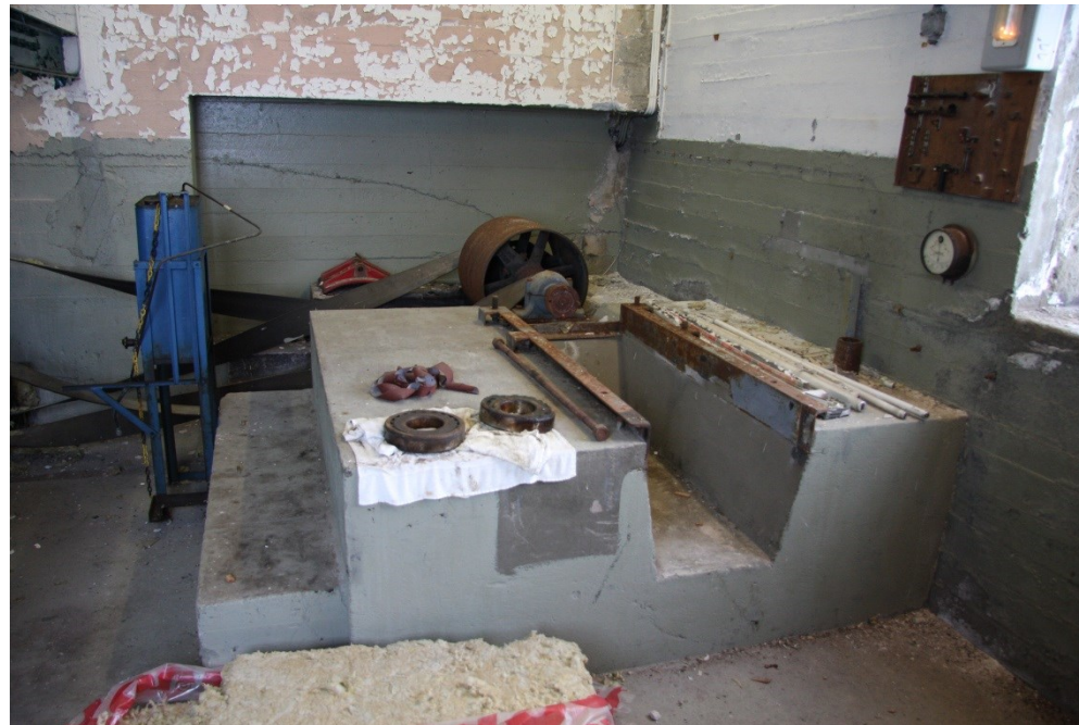
I maskinrommet sto også en dieselmotor (2.1.3.) som ved remdrift var tilkoblet hovedtrekket. Den ble brukt ved strømbrudd og ved revisjon. Motoren er borte i dag, men fundamentet og drivverket står igjen.
