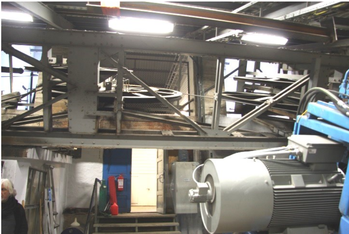
1.2.1 Drivverk med bærestativ over åpningen mot vognrommet. Ny motor skimtes i forgrunnen til høyre.
