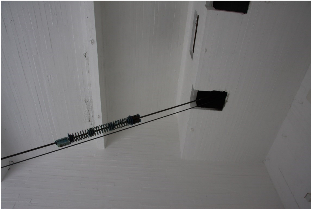
Over til venstre: 2.2.2 Tau med fjær fra hull til 2.2 drivverksrom.
