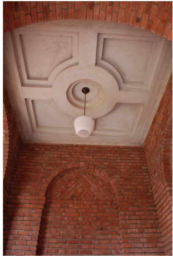
Opprinnelige pendellamper – skadete supplert i 2011
