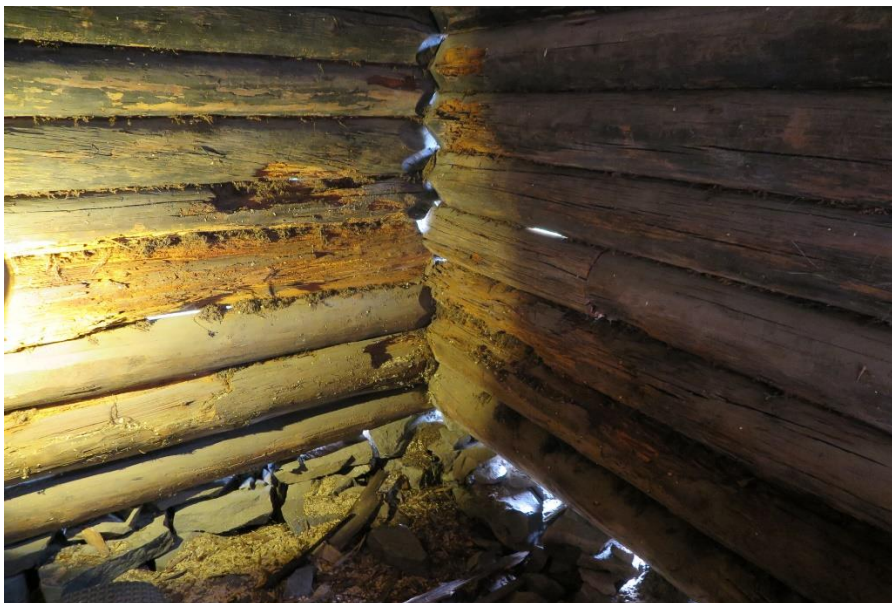
Figur 14. Rias sør-østre hjørne, med rester av ovn. Tømmeret er her skadet. Foto: Hedmark Fylkeskommune ved Agnethe Jovall, oktober 2019.
