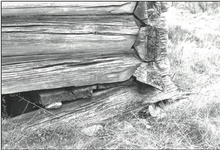
Figur 62. Vestre vegg, før rivning. Dokumentet med innlimte fotografier datert 1970, merket med Revholt, gnr. 113/, Grue, B0024/371, Glomdalsmuseets fotoarkiv.
