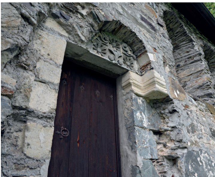
▲ Noen kirker er svært ombygde og virker ved første øyekast å ha store, aktive skader. Det er ikke alltid tilfelle. Her Logtun kirke
