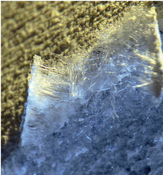
▲ Salt i murverk har nesten like stor kraft som is når det krystalliserer rett under overflaten og sprenger bort slemming – eller kalkmalerier. Her fra Rosenkrantzårnet i Bergen
