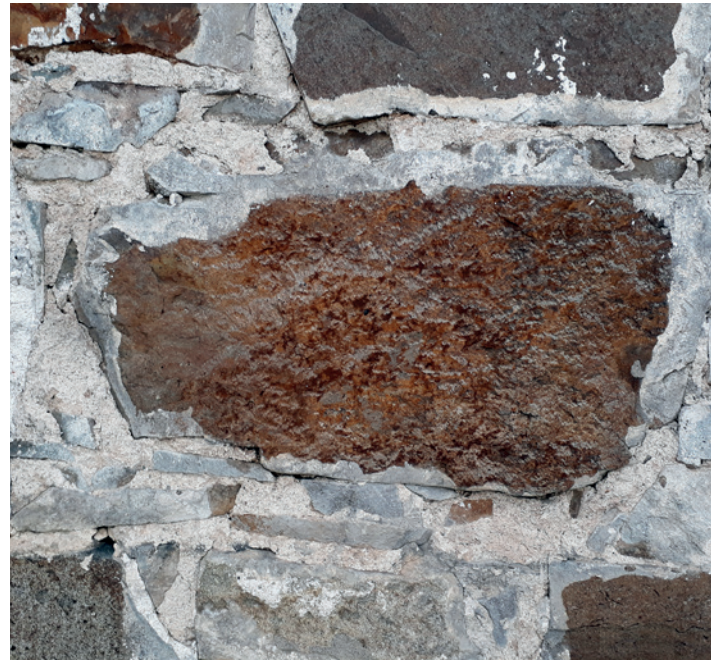
▲ Murene i mange kirker er preget av bruk av lokal stein, kalkmørtel og mye pinningstein i fugene. Tingelstad gamle kirke, etter meisling av tynn sementpuss over fugene.
