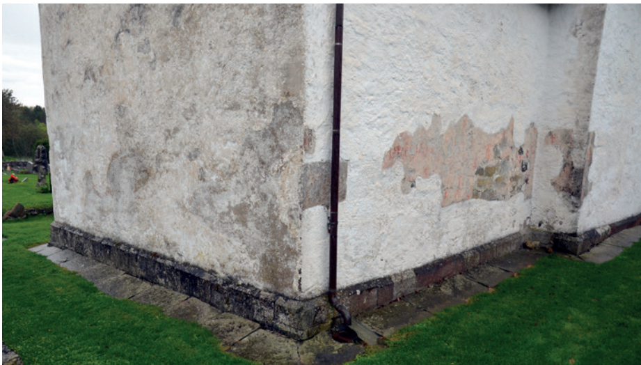
▲ Mange middelalderkirker har fått etablert ny drenering langs grunnmuren. Dreneringen krever jevnlig vedlikehold. Her den lukkede dreneringen omkring Moster gamle kirke
