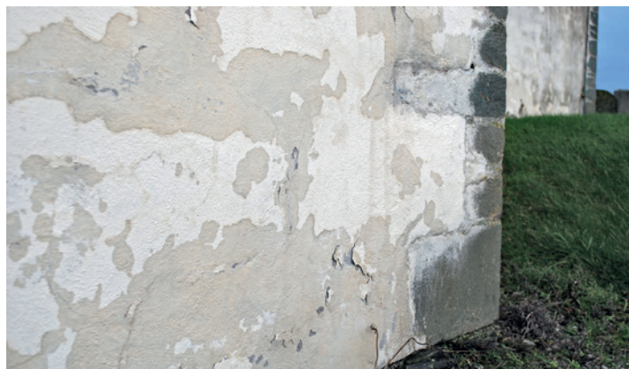
▲ Sørbø kirke har i dag store skader på sørfasaden. Hvorfor er det slik? Riksantikvarens arkiv gir ledetråder.
