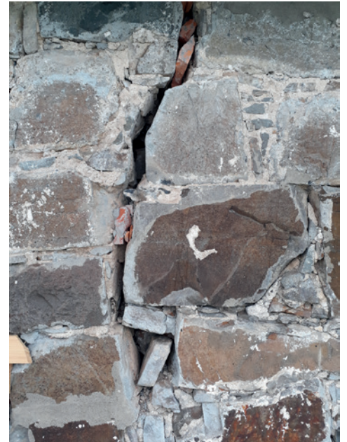
▲ En typisk sprekk i en gammel kirkemur. Sprekken følger minste motstands vei – gjennom et vindu og langs fugene. Tingelstad gamle kirke
