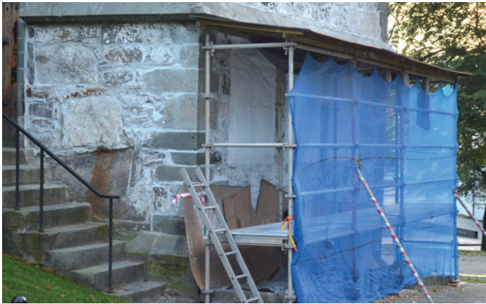
▲ Prøvefelt for kalkbehandling på Stavanger domkirke. Feltene er under tak til kalken har herdet, senere utsettes de for vær og vind for å teste holdbarhet
