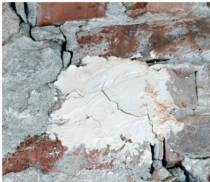
▲ Gipsplomber er en enkel og sikker metode for sprekkeovervåking. Men er plomben sprukket, får man ikke informasjon om videre utvikling. Da må man sette på en ny. Foto: Vegard Røhme, Fabrica
