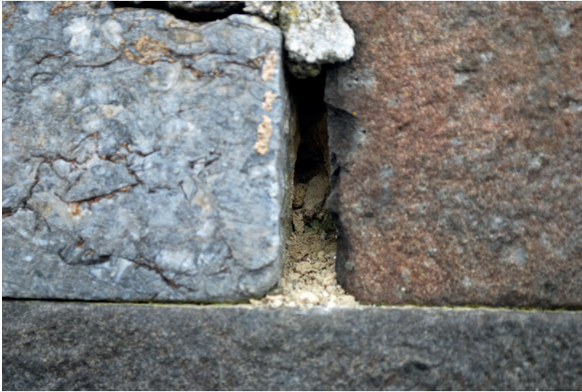
▲ Helt ødelagt fuge viser inn til tomrom i det indre av murverket. Her er skaden skjedd på grunn av lekkasjer, frost, stabilitetsproblemer og bruk av sement (bortmeislet). Nikolaikirken på Gran
