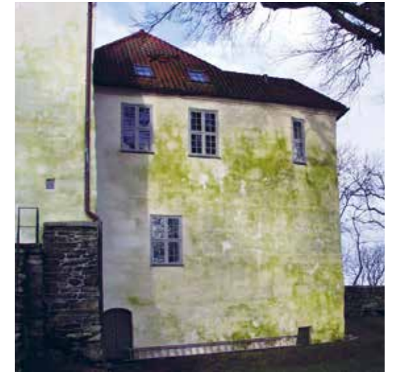
↑ ØKT VEKST AV GRØNSKE på fasader som stadig fuktes ned er et økende problem. Utstein kloster, Stavanger kommune. Foto: Johan Matsson, Mycoteam
