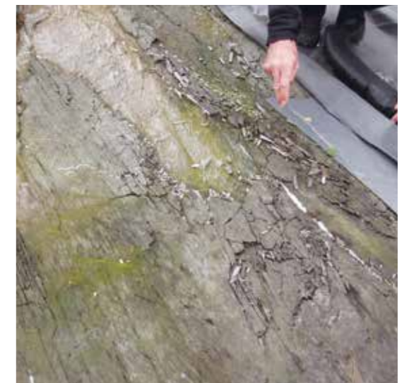
↑ FYSISK FORVITRING som følge av fryse- og tineprosesser kan gjøre stor skade på bergflater med bergkunst, som her på helleristningsfeltet Ausevik i Kinn kommune. Vintertildekking med isolerende matter bidrar til å begrense forvitringen. Foto: Eva Walderhaug, Riksantikvaren
