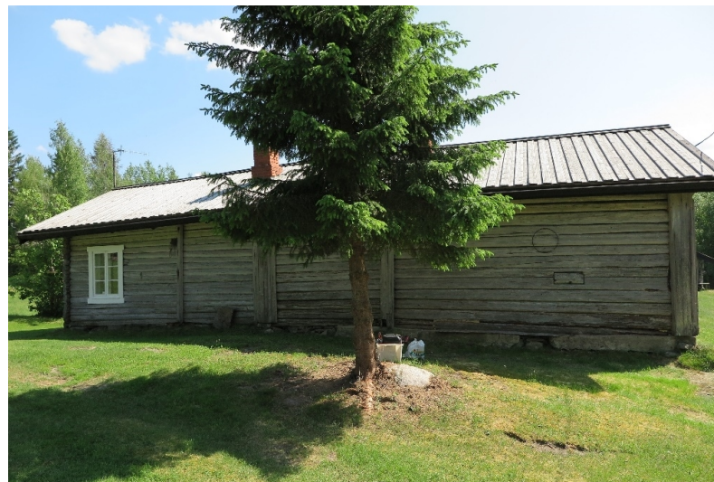
Nordfasaden. Igjentetta luftteglugge til røykstua midt på vegg.
