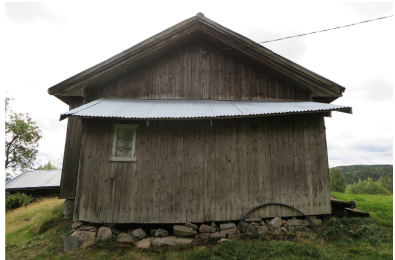
Inngangspartiet ved kjøkkenet på husets nordside. Tilbygget skal rettes opp.
