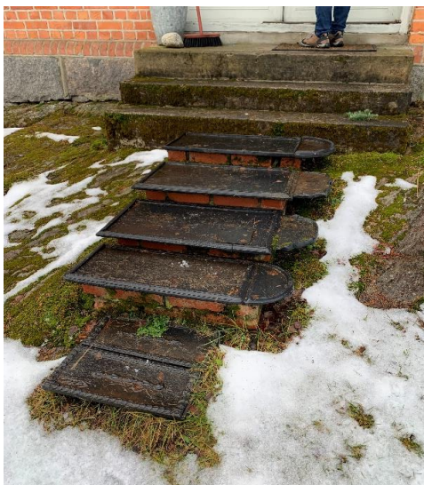
Gamle støpeovnsdeler er gjenbrukt som trapp på snekkerverkstedet. Foto: Linn Brox, Riksantikvaren, 2019.
