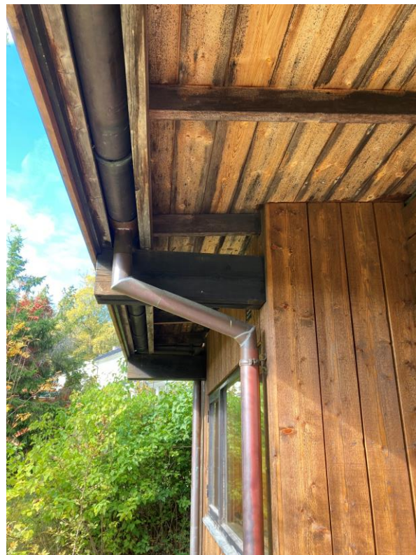
Takrenne og nedløp i kobber.
