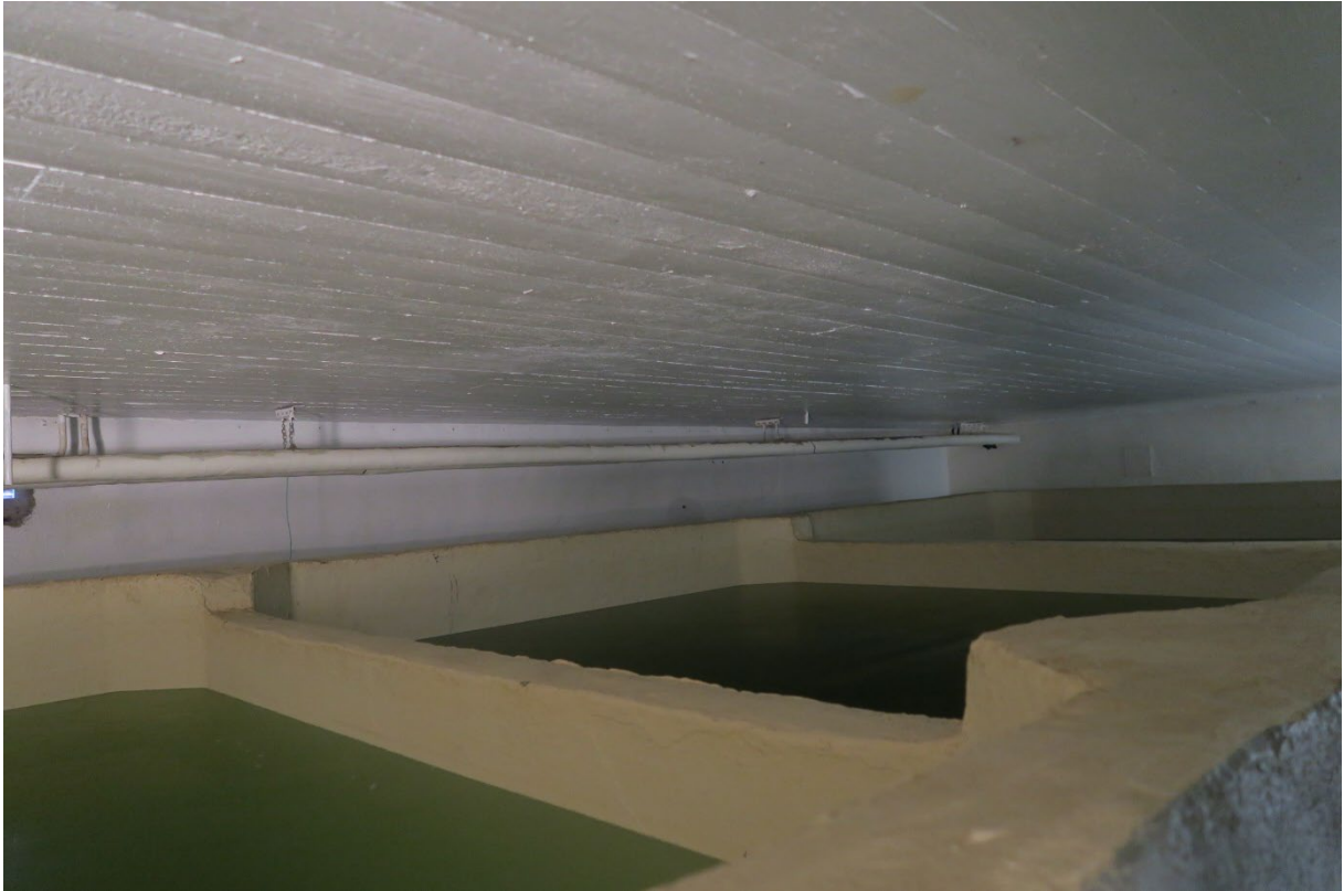
Figur 33: Vanntanker i kjeller, boligdel. Foto: Maria Lytomt, Riksantikvaren 2021.
