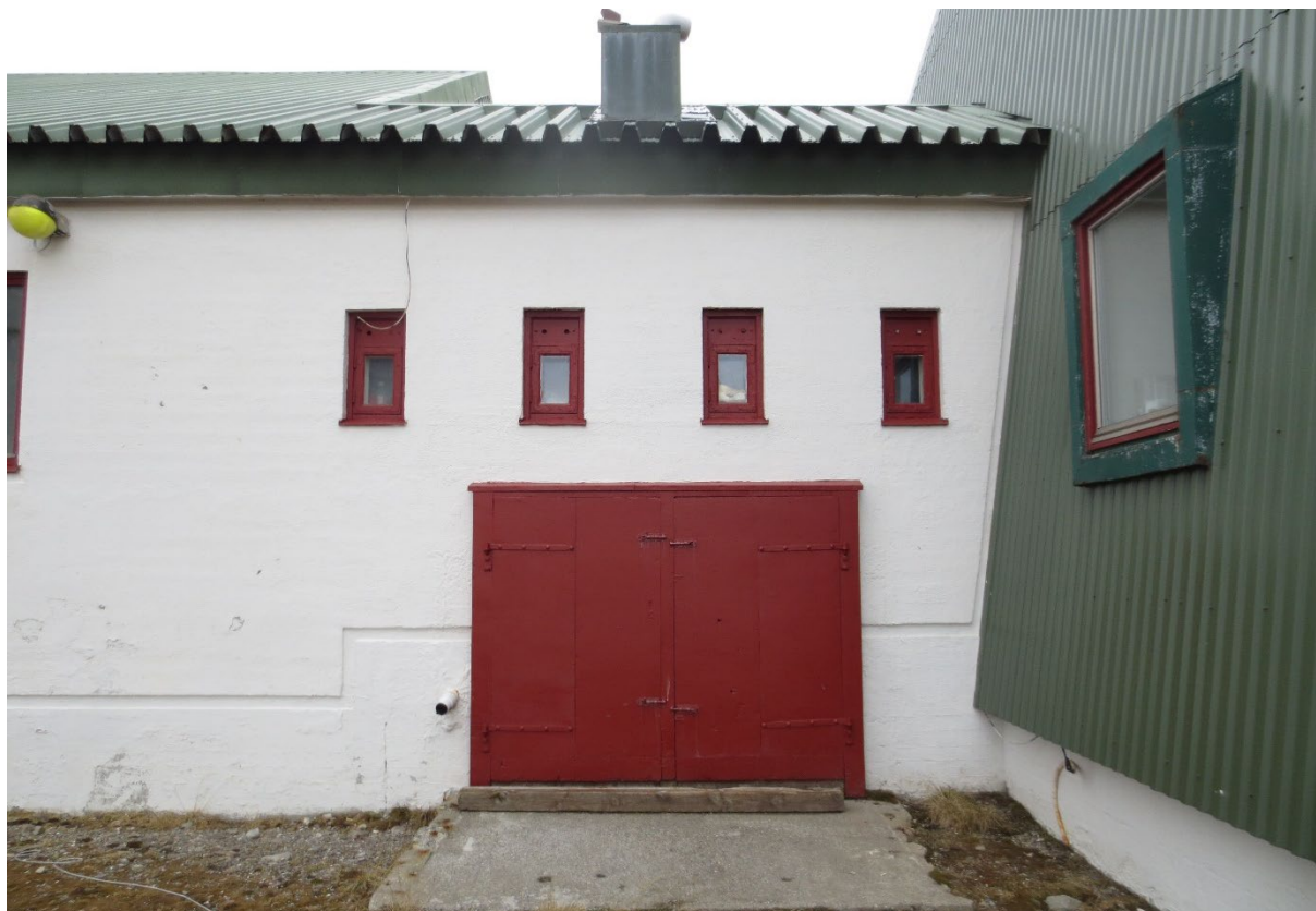
Figur 18: Del av fasade SV, med port i mellombygg. Foran port ses støpt rampe/inngangsparti. Over porten er originale vinduer med ventilasjonsluke i øvre del av ramme. Helt til venstre er lampe som inngår i fredningen. Til høyre ses vindu i utkraget boks i boligdel. Foto: Siri Hoem, Forsvarsbygg 2021.
