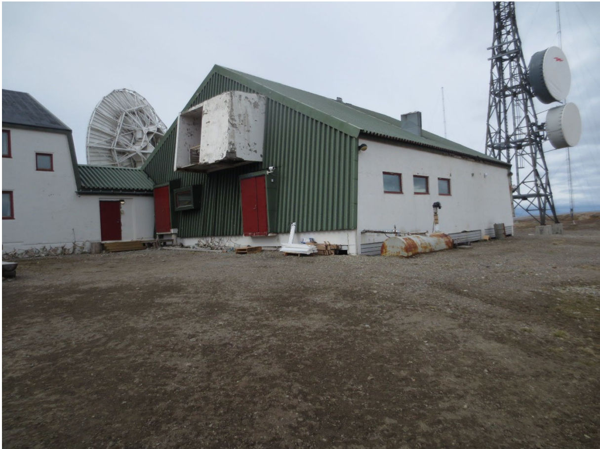
Figur 9: Hovedstasjonen, teknisk del. Inngangsparti, gavlvegg (SØ) og sidevegg (NØ). Foto mot NV. Foto: Siri Hoem, Forsvarsbygg 2021.
