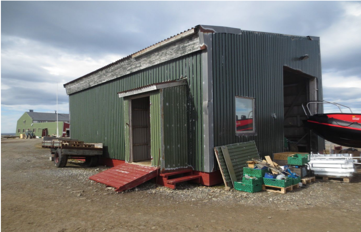
Figur 67: Båthuset, fra sjøsiden. Foto: Siri Hoem, Forsvarsbygg 2021. Løs dør til bislag lagret under vinduet.
