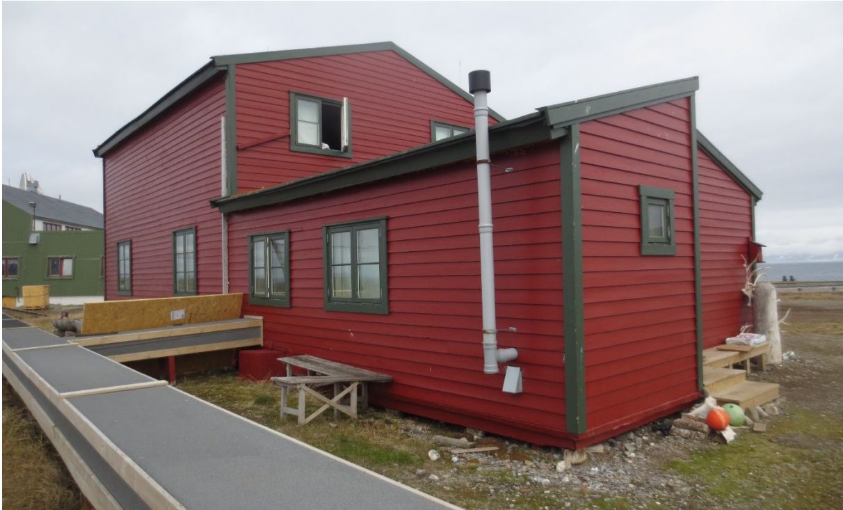
Figur 50: Gammelstasjonen. Rørgate for vann fra Hovedstasjonen. Foto mot NV. Foto: Siri Hoem, Forsvarsbygg 2021.
