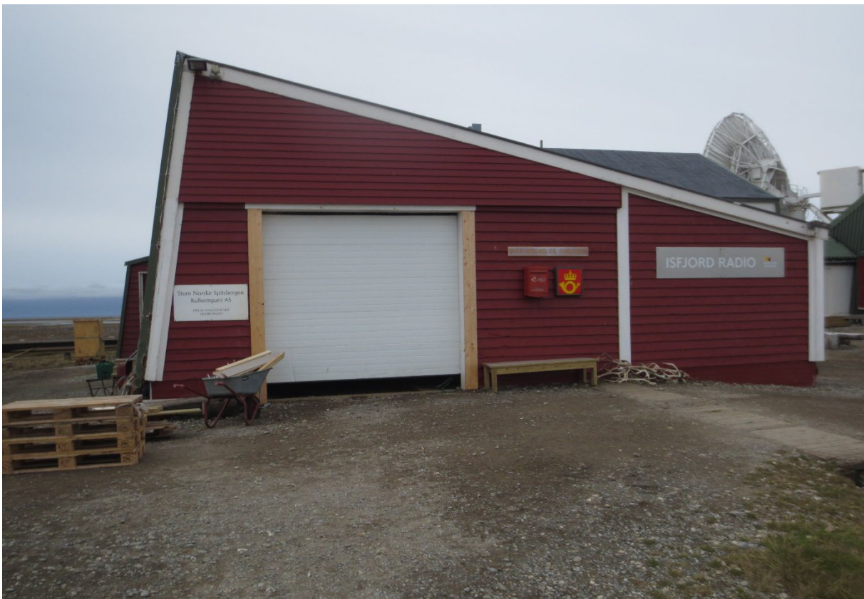
Figur 36: Fasade mot NØ, med garasjeport. Over garasjeporten har det opprinnelig vært vindusfelt. Til høyre i bildet, inn mot hvit loddrett list som skiller garasjejedel fra tekniske rom, ses overbygd grøft for dieslrør fra tanken ved havna. Foto: Siri Hoem, Forsvarsbygg 2021.
