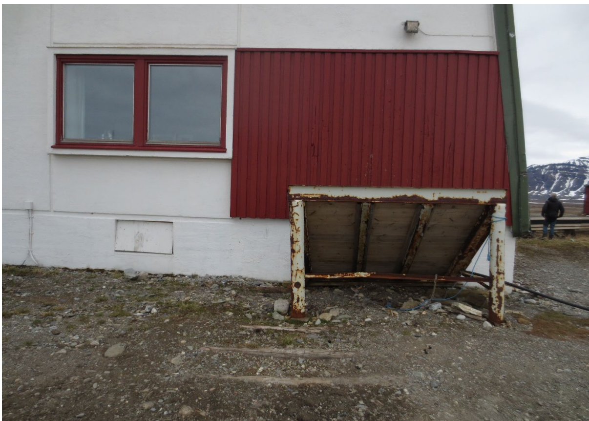
Figur 25: Hovedstasjonen, boligdel. Fasade SV. Snøtippen med felt med tømmermannskledning over. Foto: Siri Hoem, Forsvarsbygg 2021.
