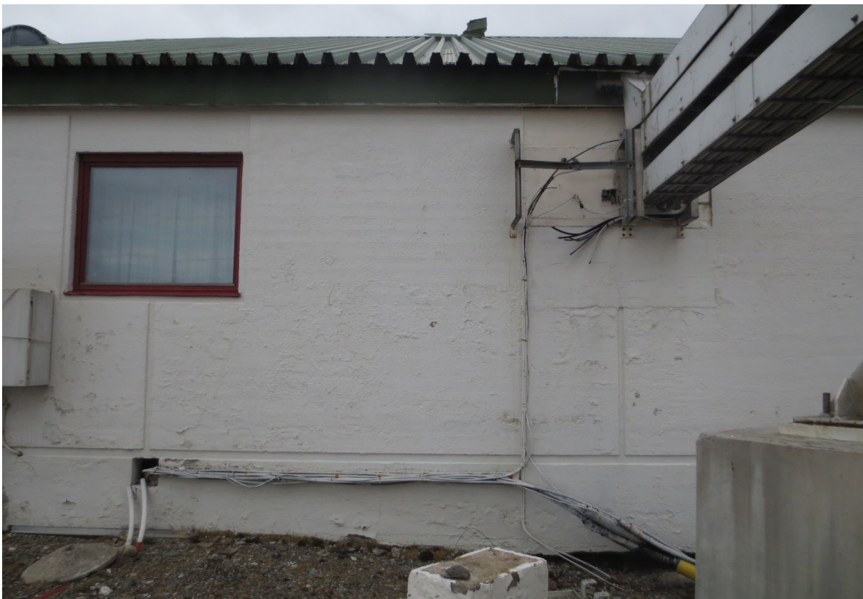
Figur 17: Del av fasade SV. Innfesting av støtte for parabolantenne i eldre gjenstøpt vindusåpning. Foto: Siri Hoem, Forsvarsbygg 2021.
