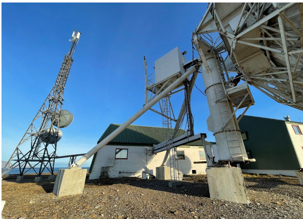
Figur 116: Fundamentene til parabolantenna på Isfjord radio, og tilkobling til Hovedstasjonen. Foto: Syssemesteren på Svalbard, 2022.
