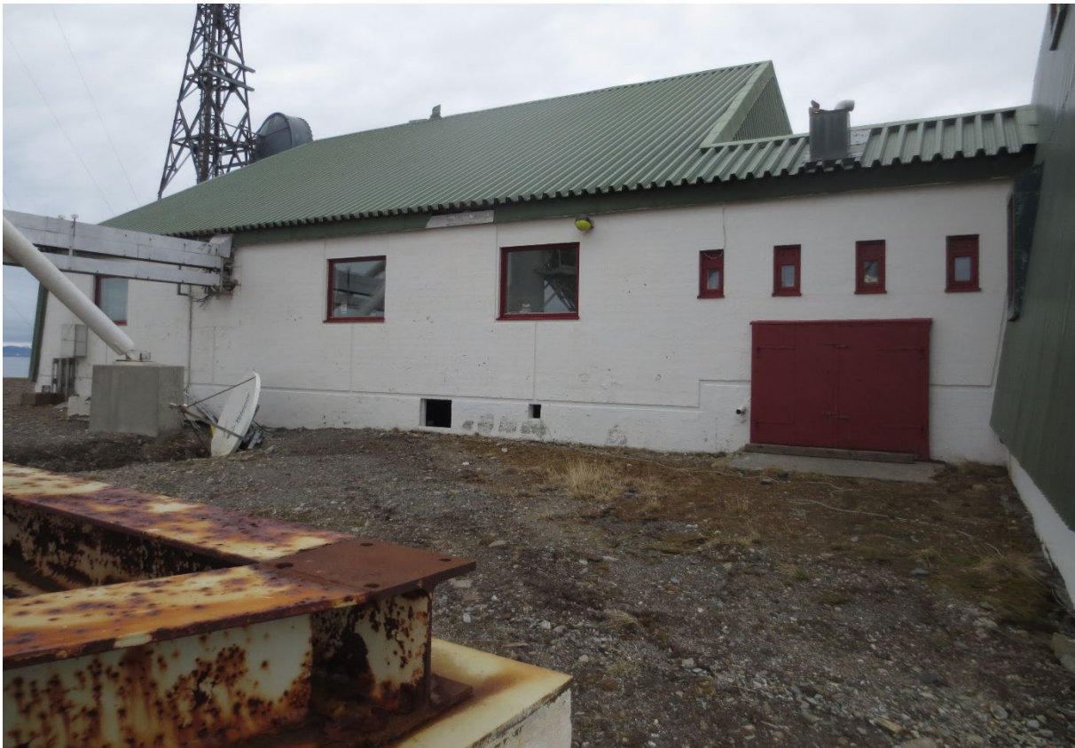
Figur 16: Fasade SV. Lampe som inngår i fredningen over vindu. Foto: Siri Hoem, Forsvarsbygg 2021.
