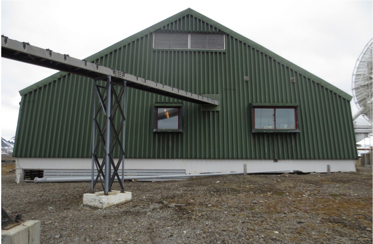
Figur 14: Gavlvegg NV, med kabelgate til antennetårn. Øverst mot mønet er ventilasjonsåpning fra loft. Opprinnelig bygningsvolum har mur mellom støpte fundamentpilarer (ikke grunnmur), mens utvidelsen fra 1979 har treskjørt mellom pilarene, med luke til tilkomst under bygget. Foto: Siri Hoem, Forsvarsbygg 2021.
