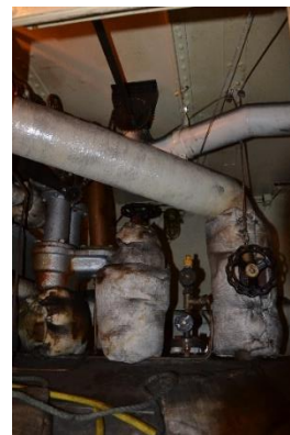
Rørsystem over dampkjelen.
