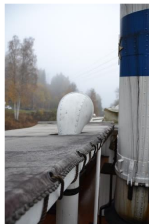
Luftelyr – topp – babord. Seilduk baldakintak Skorstein – øvre og nedre del lett synlig.
