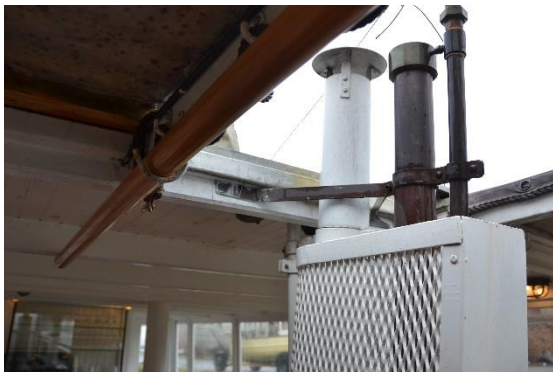
Lufting maskin – rør til skipsfløyte.
