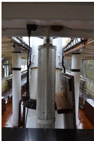
Svanehalsen luftelyr, og beskyttelse av rørsystem for fløyte.
