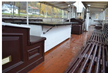
Bord, kasse for redningsutstyr, benker og deler av nedgangskappe – salong.
