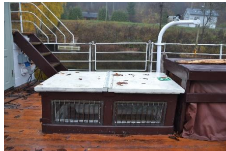
Lysventiler – nedgangskappe mannskapslugar.
