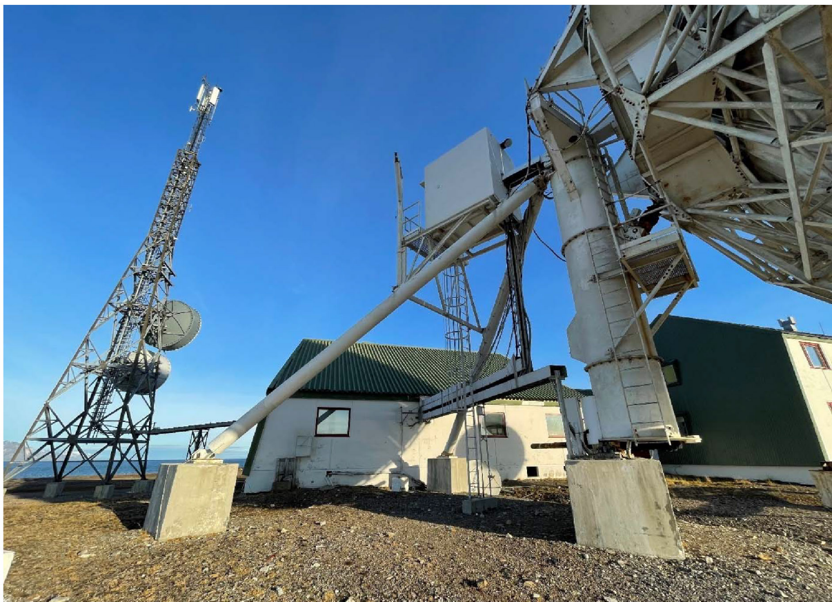
Figur 158: Fundamentene til parabolantenna på Isfjord radio, og tilkobling til Hovedstasjonen. Foto: Syssemesteren på Svalbard, 2022.
