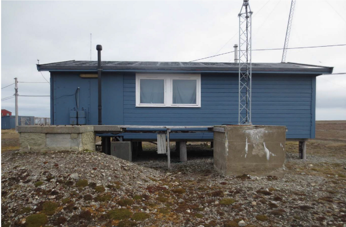
Figur 129: Telenorhytta. Fasade mot S. Teknisk rom med plateledning til venstre. Lufting fra toalett i svart rør langs vegg (ikke omfattet av fredningen). Foto: Siri Hoem, Forsvarsbygg 2021.
