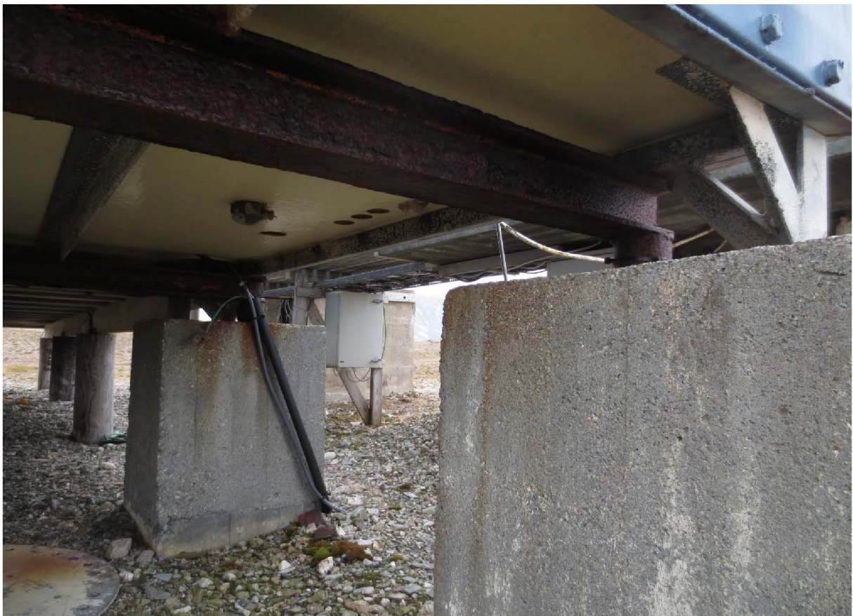
Figur 132: Detalj av fundamenter for teknisk rom. Lukk for antennefeste under bygningen. Foto: Siri Hoem, Forsvarsbygg 2021.
