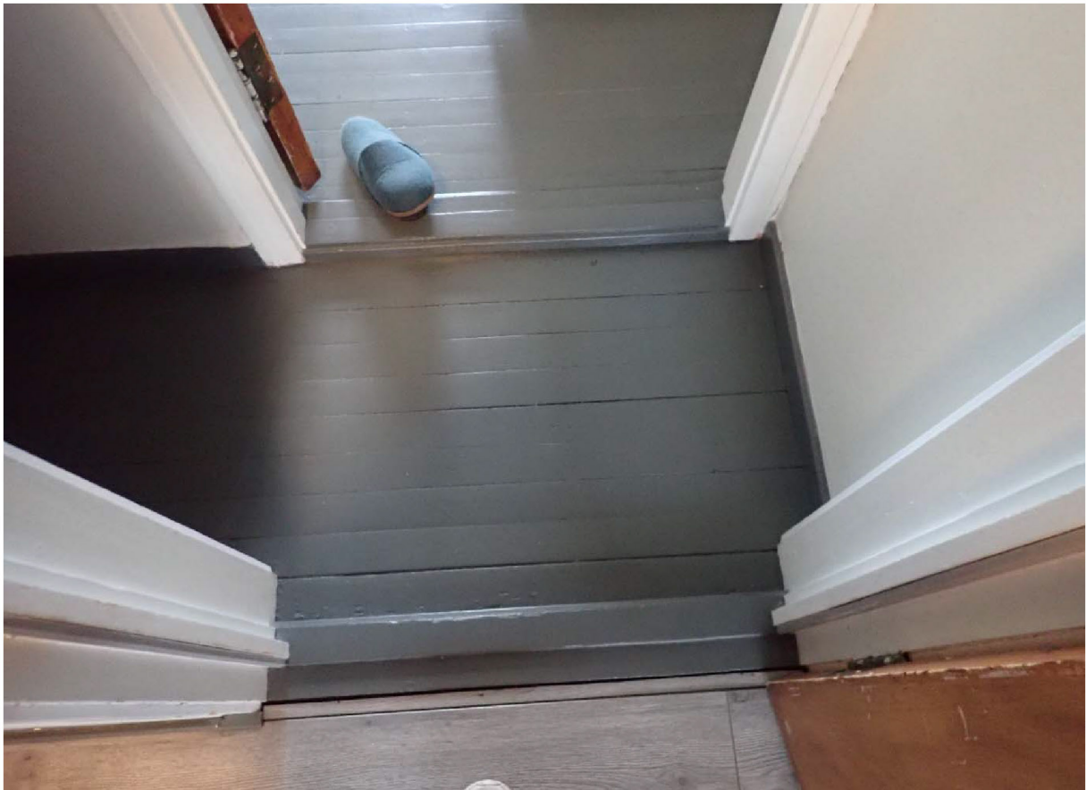
Figur 52: Gulv i mellomgang, rom 202. Foto: Syssemesteren på Svalbard, 2023.
