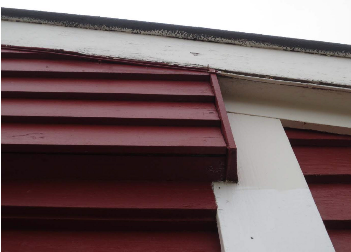
Figur 77: Detalj over garasjeport. Igjenbygd tidligere vindusfelt. Vindusfeltene er bevart bak gjenbyggingen. Foto: Siri Hoem, Forsvarsbygg 2021.
