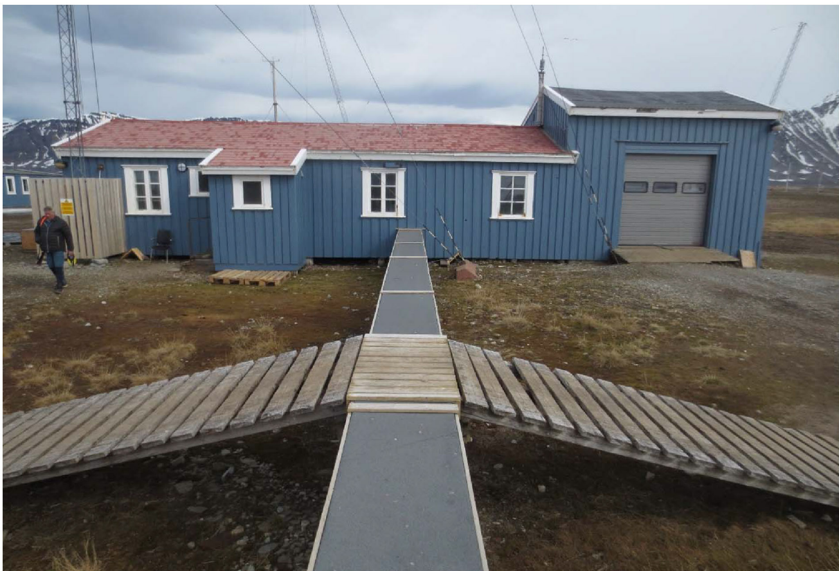
Figur 117: Sondebrakka. Fasade mot V. Rørgate for vannforsyning fra hovedstasjonen, med «rampe» for kryssing. Første
