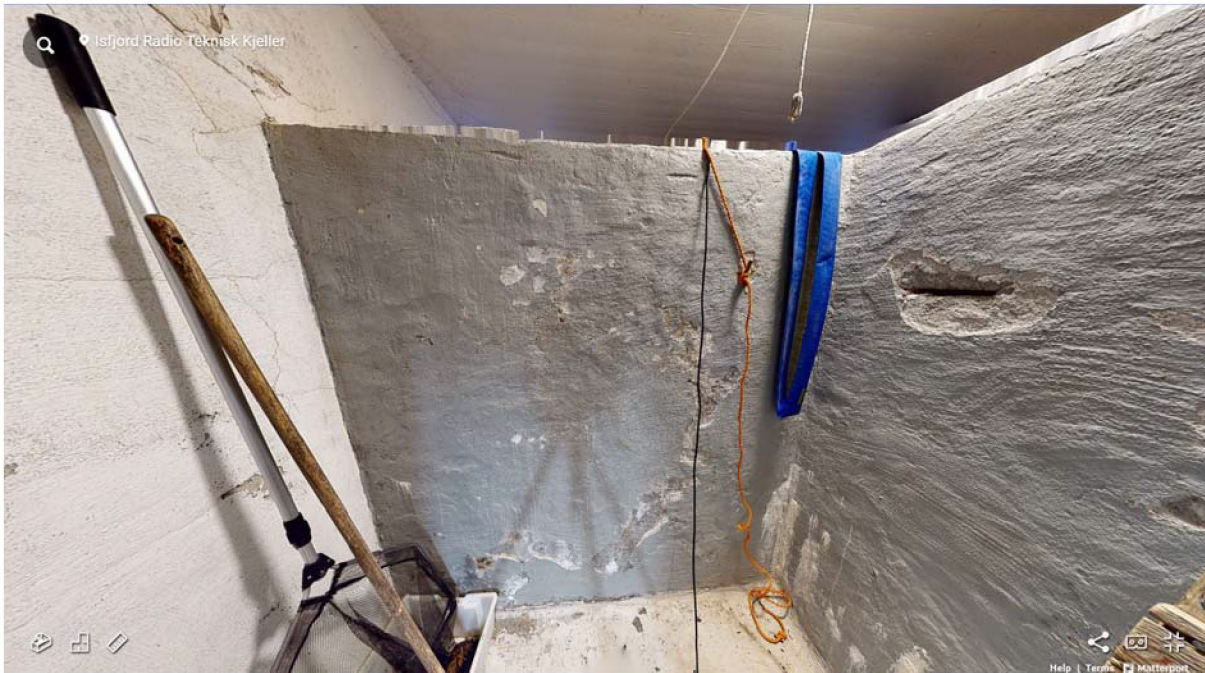
Figur 42: Rom med vanntanker for snøsmelting. Skjermdump fra 3D-modell, Store Norske/Matterport 2023. Faktisk utførelse avviker fra plantegning.
