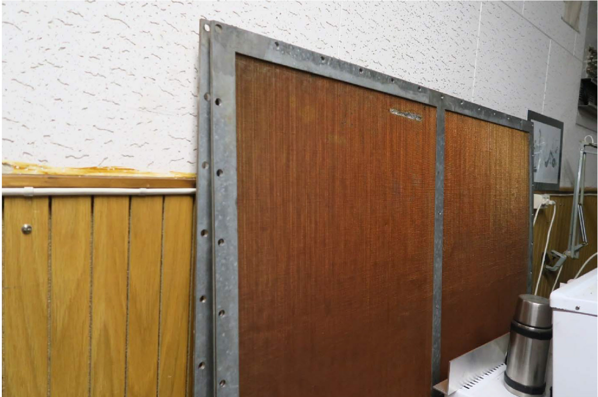
Figur 28: Satellittrom. Innvendige vinduslemmer for elektronisk skjerming (Faradays bur-konstruksjon). Foto: Maria Lytomt, Riksantikvaren 2021.
