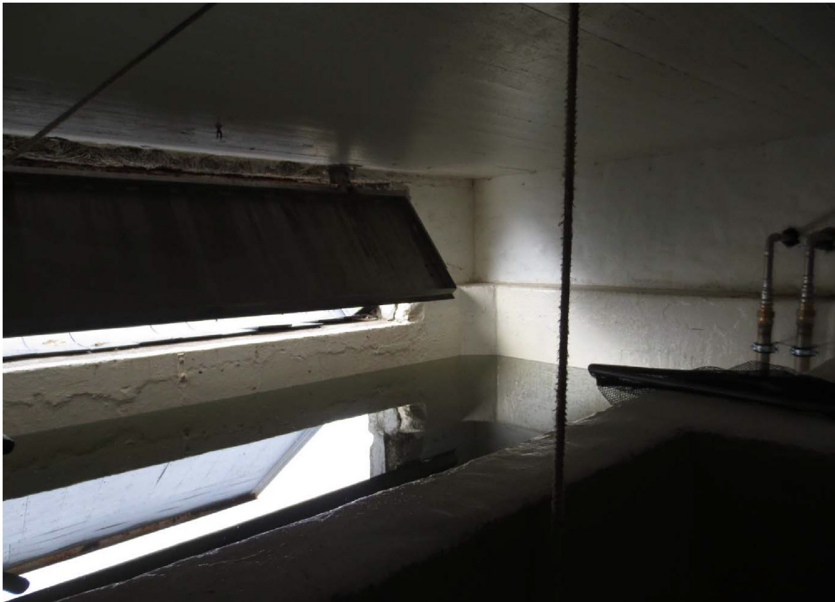
Figur 44: Full vanntank for snøsmelting. Åpen luke mot snøtipp. Foto: Siri Hoem, Forsvarsbygg 2021.
