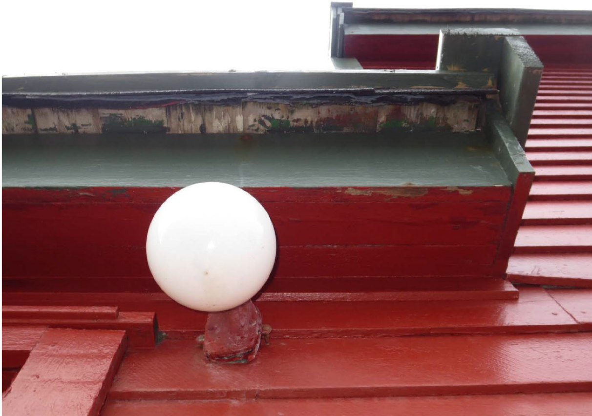
Figur 90: Gammelstasjonen. Lampe ved dør i sidebygning, fasade N. Foto: Siri Hoem, Forsvarsbygg 2021.
