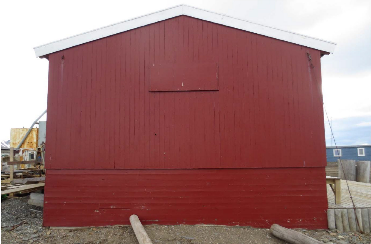
Figur 112: Naustet. Fasade mot NV. Blendet vindu under mønet. Stående bordkledning i opprinnelig del, liggende bordkledning på tilbygd del. Foto: Siri Hoem, Forsvarsbygg 2021.
