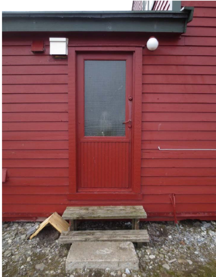
Figur 88: Gammelstasjonen. Dør i sidebygg, fasade N, med eldre betongtrinn foran. Foto: Siri Hoem, Forsvarsbygg 2021.
