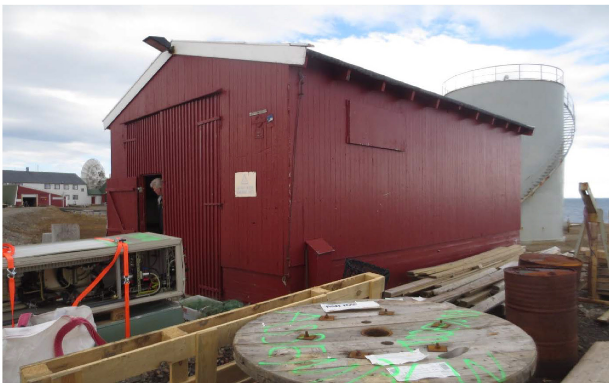
Figur 111: Naustet, fasade mot SØ (gavl) og NØ (langvegg, mot sjøen). Blendet vindu høyt opp på vegg. Foto: Siri Hoem, Forsvarsbygg 2021.
