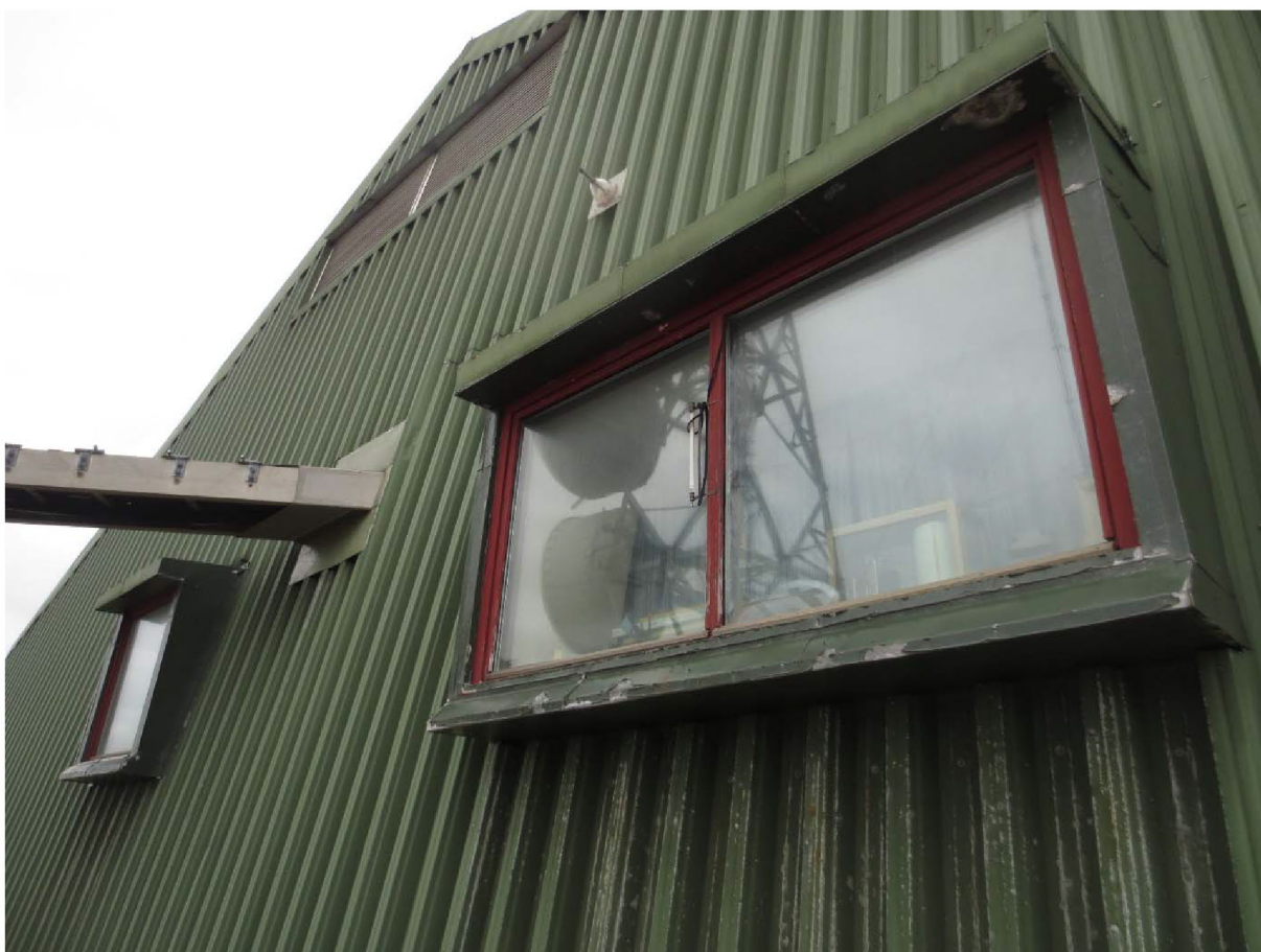
Figur 15: Detalj av gavlvegg NV, med vinduer i utkragede blikklede kasser/bokser. Foto: Siri Hoem, Forsvarsbygg 2021.
