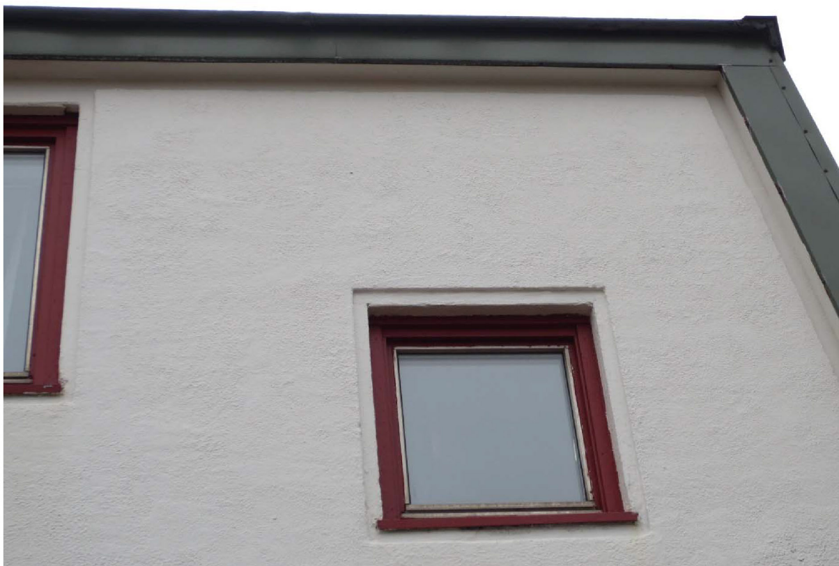
Figur 35: Hovedstasjonen, boligdel. Fasade mot gårdsrom (NØ), vindu i trappegang og dekor rundt vinduer og veggfelt. Foto: Siri Hoem, Forsvarsbygg 2021.
