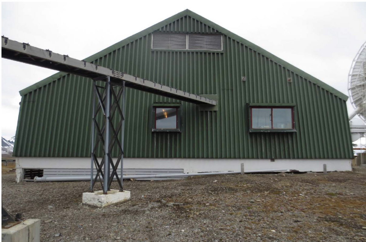
Figur 14: Gavlvegg NV, med kabelgate til antennenårn. Øverst mot mønet er ventilasjonsåpning fra loft. Opprinnelig bygningsvolum har mur mellom støpte fundamentpilarer (ikke grunnmur), mens utvidelsen fra 1979 har treskjørt mellom pilarene, med luke til tilkomst under bygget. Foto: Siri Hoem, Forsvarsbygg 2021.
