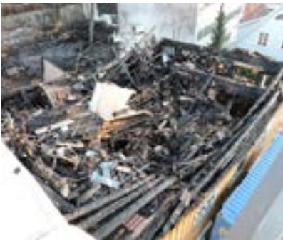
Figur 27: Utbrent takverk og 2. etasje, på Telegrafan i Drøbak som brant i 2015. Foto: Per-Willy Færgestad.
