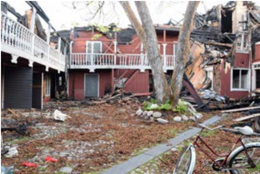
Figur 30: Gårdsrommet før rivingsarbeidene startet. For å beskytte stenleggingen ble det lagt markduk og et relativt tykt bærelag av grus. Foto: Jönköpings Läns Museum
