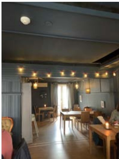
Figur 17: Detektor i himling, kafelokale i Gamlebyen. Foto: Sverre Støle, Fredrikstad kommune.
