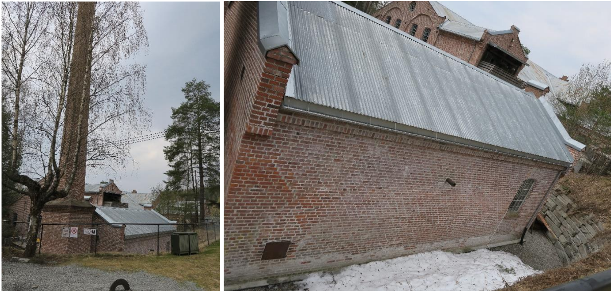
Tv. Fyrhuset sett mot vest med tresliperiet i bakgrunnen. Th. langvegg mot nord.
