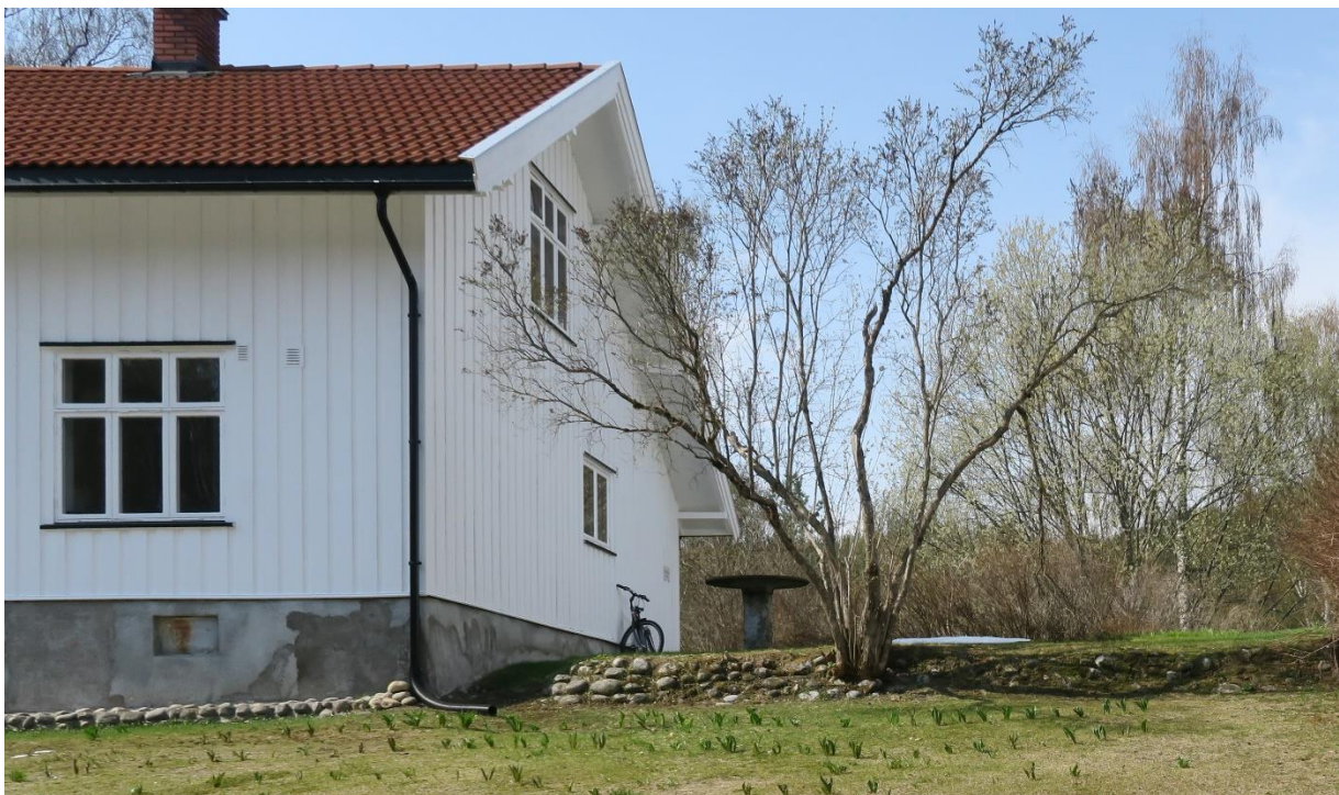
Reparatørboligens nordre gavlvegg og litt av vegg mot øst. Foto: Cathrine Arnesen, Riksantikvaren 2019.
