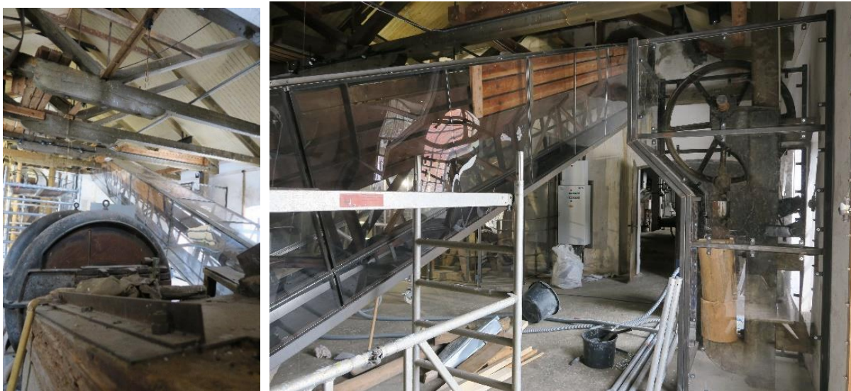
Tv. kubbtransportøren for kubber til Sliperiet. Th. detalj av kubbtransportøren og kubbkløyveren, også den beskyttet med plexiglass, til høyre i bildet. I bakgrunnen er det en dobbel dør i metall som fører til Sliperisalen.
