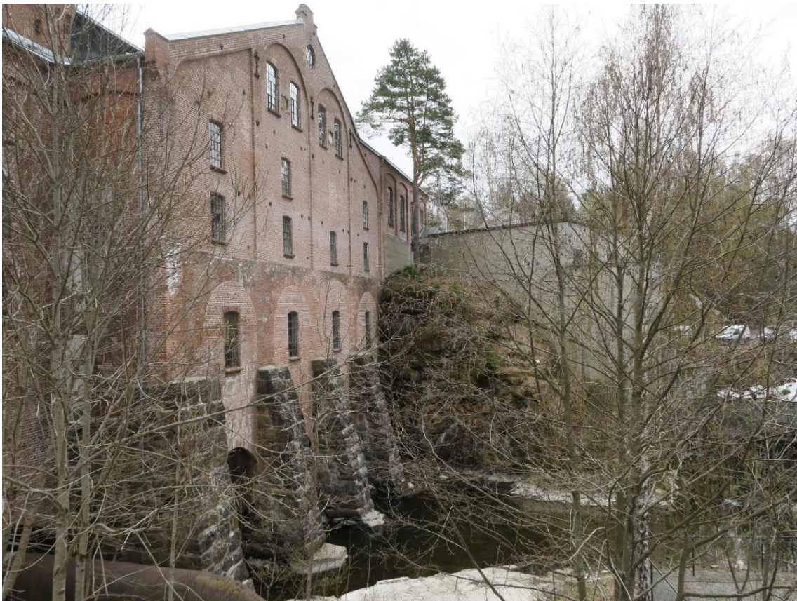
Tresliperiets vestre vegg. I bunnen mot vannet, hvelvede åpninger for spillvannsrør fra turbinene.
