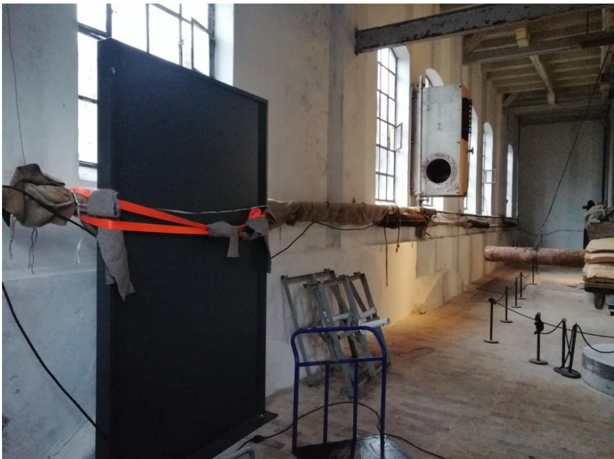
Rør for sentralvarmesystemet i Produksjonshallen langs gavlveggen mot øst ved inntakskanalen til turbinene. Sett mot sørøstre hjørne.
