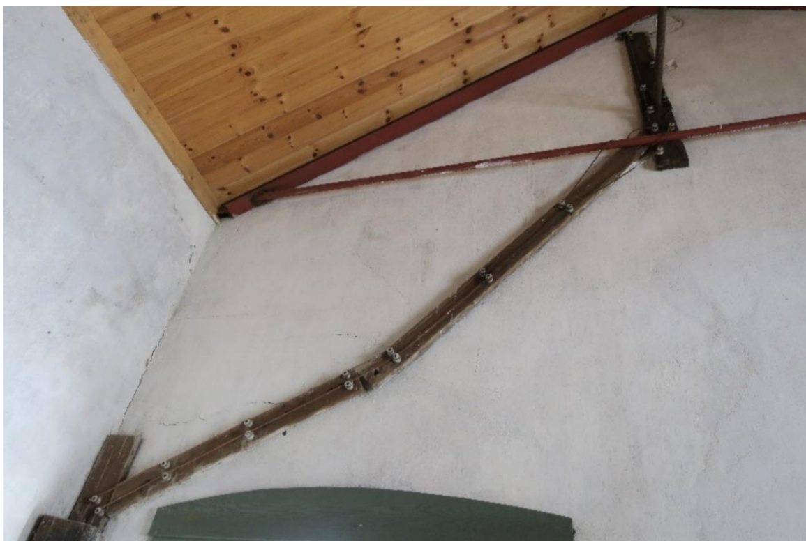
Elektrisk anlegg over døra på vestre gavlvegg.
