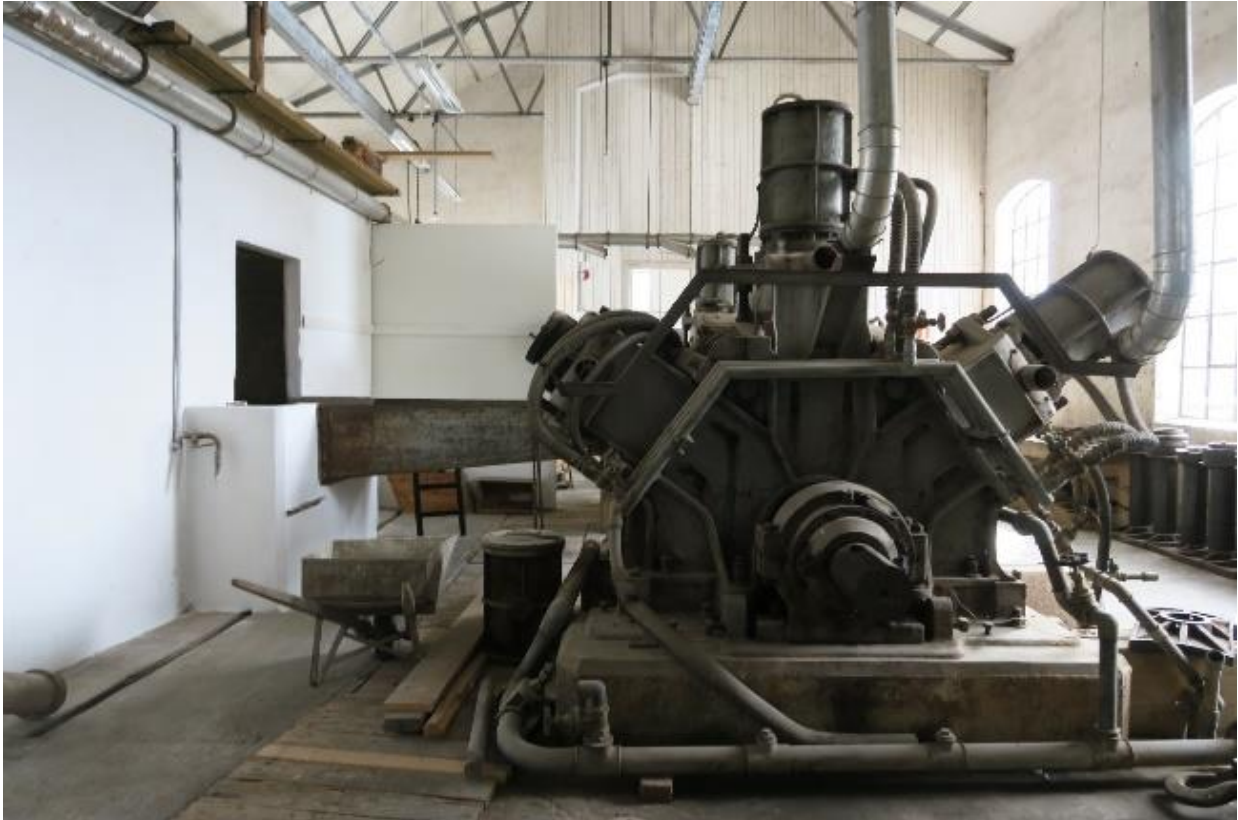
De to vertikale treslipemaskinene, som kom til Kistefos i 1946, med en transportrenne i midten. Denne er koblet til den hvitmalte kubbsiloen til venstre i bildet.
