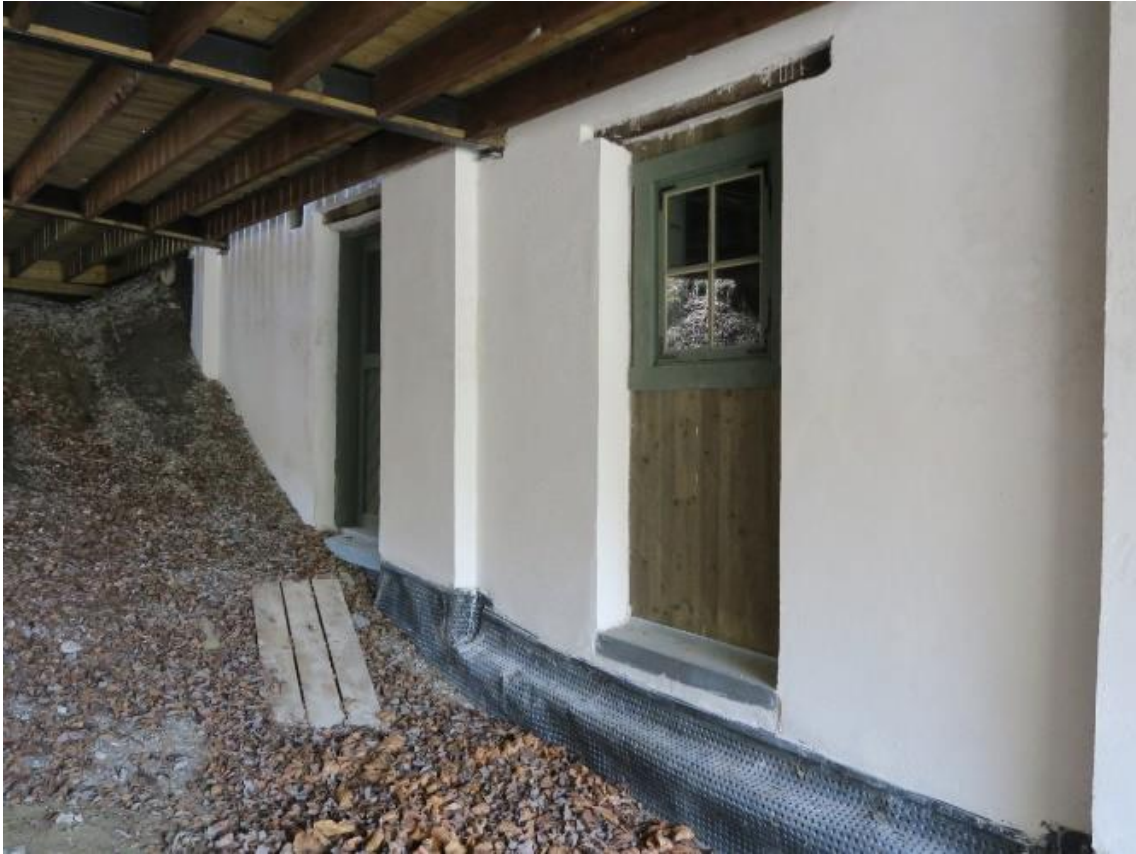
Detalj av inngangen under broa som igjen er under passasjen for kubtransportøren, se foto forrige side av en person som er på vei inn. Under restaureringsarbeidet noen år før fredningen ble disse avbildede åpningene oppdaget, en dør og et vindu.
