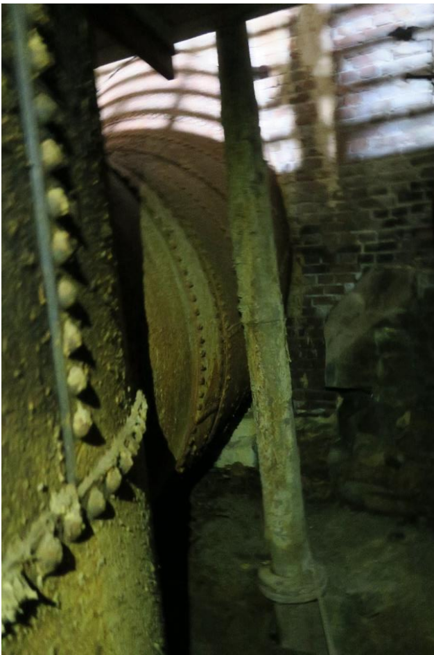
Detalj av turbinrør på nivå 4.
