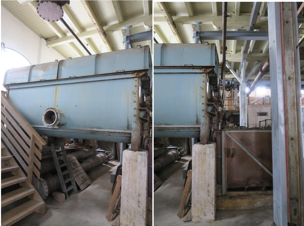
Fortykkerne står på betongfundamenter.
