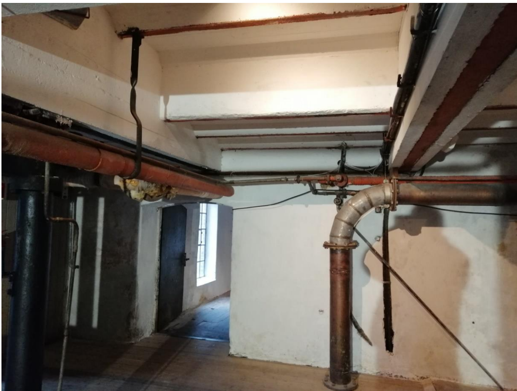
Sentralvarmerør i området ved Akslingsrommet.
