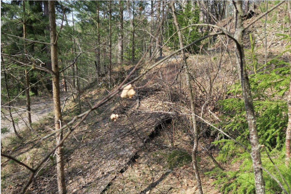
Bølgeblikk som kan være rester av taktekket til Holterhusets uthus. Foto: Cathrine Arnesen, Riksantikvaren 2019
