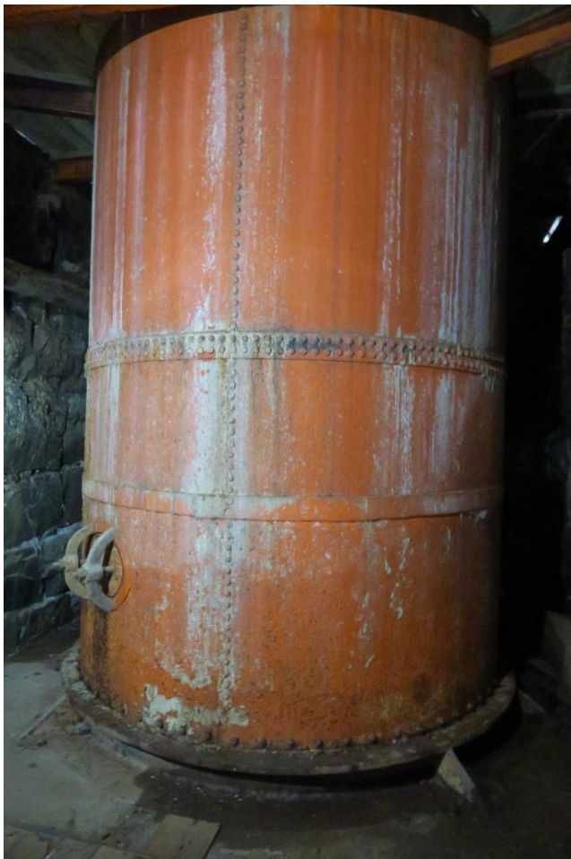
Selve turbinen på nivå 4.
