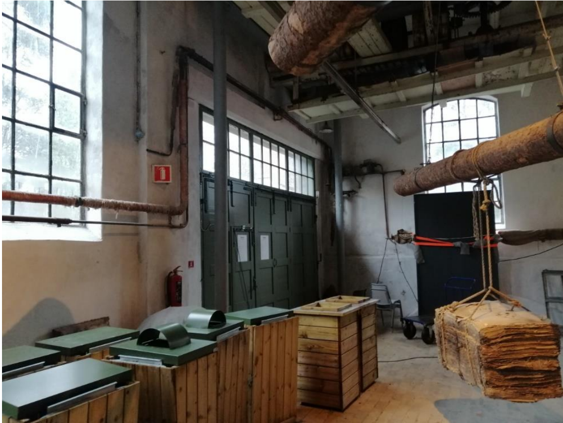
Rør for sentralvarmesystemet i Produksjonshallen langs, sett mot nordøstre hjørne. Sett mot nordøstre hjørne. Noen meter nordøst herfra ligger Fyrhuset der varmen til anlegget produseres.
