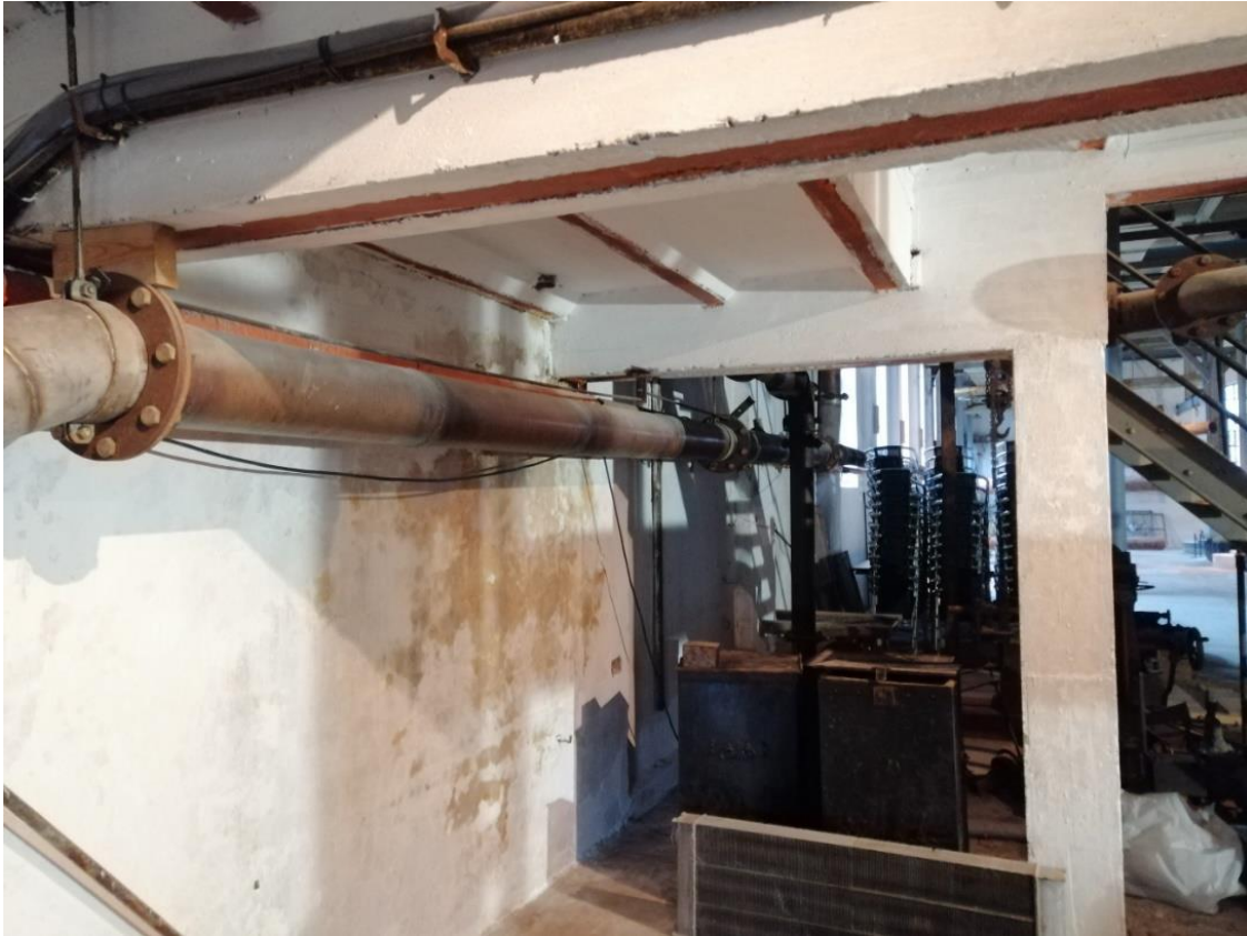
Rør for sentralvarmesystemet i Produksjonshallen langs langveggen mot nord. Sett mot nordøstre hjørne.
