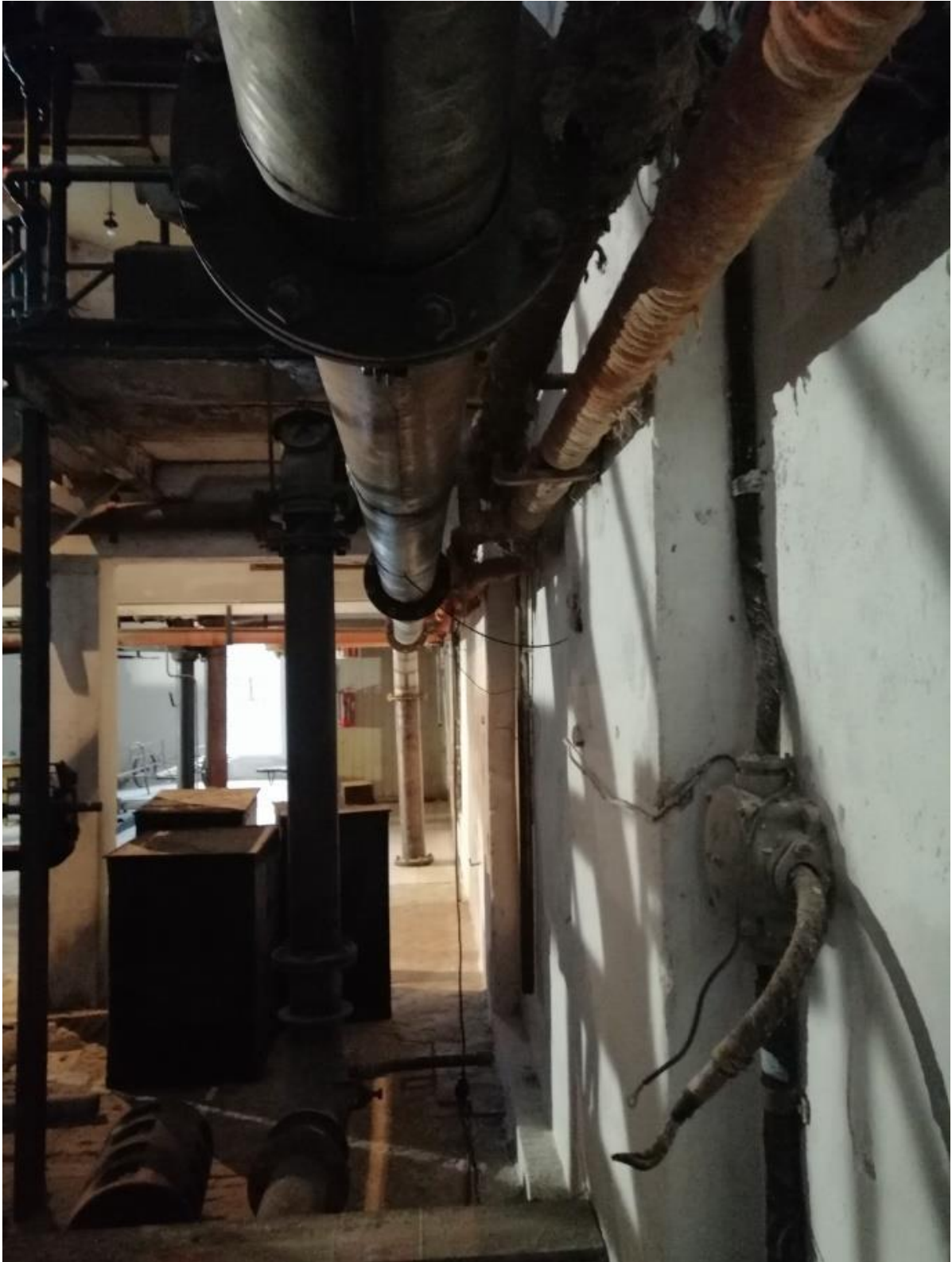
Rør for sentralvarmesystemet i Produksjonshallen langs langveggen mot nord. Sett mot toalettene i nordvestre hjørne.
