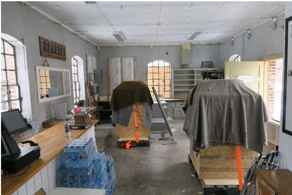
Mekanisk verksted med plassbygd benk med skap og skuffer langs søndre vegg.
