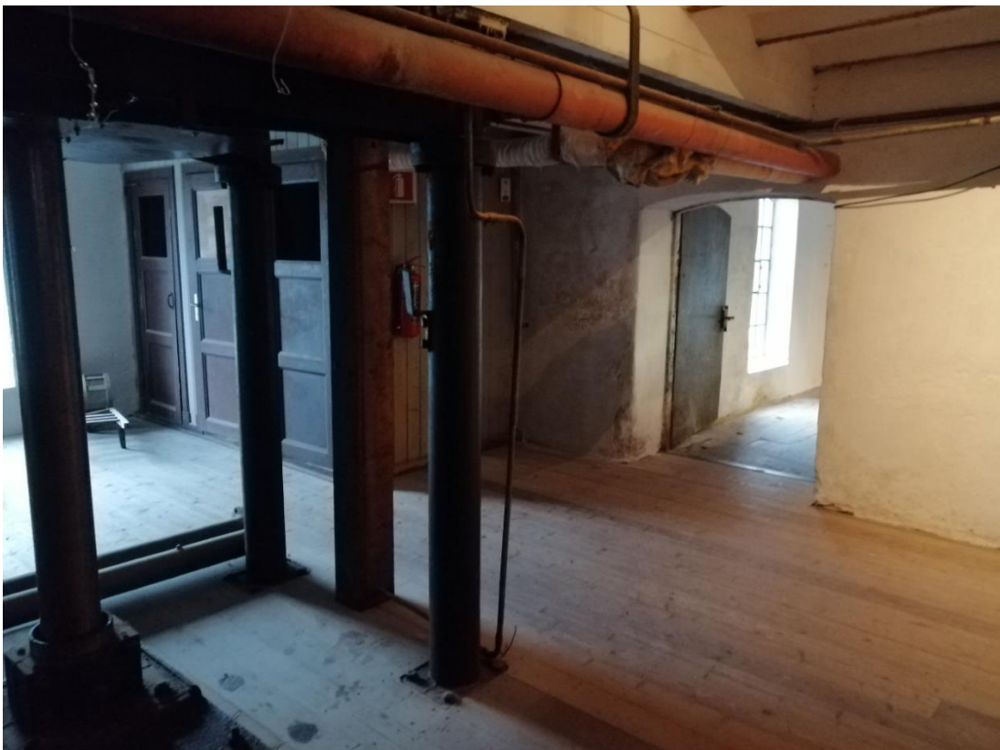
Sentralvarmerør i området ved Akslingsrommet.
