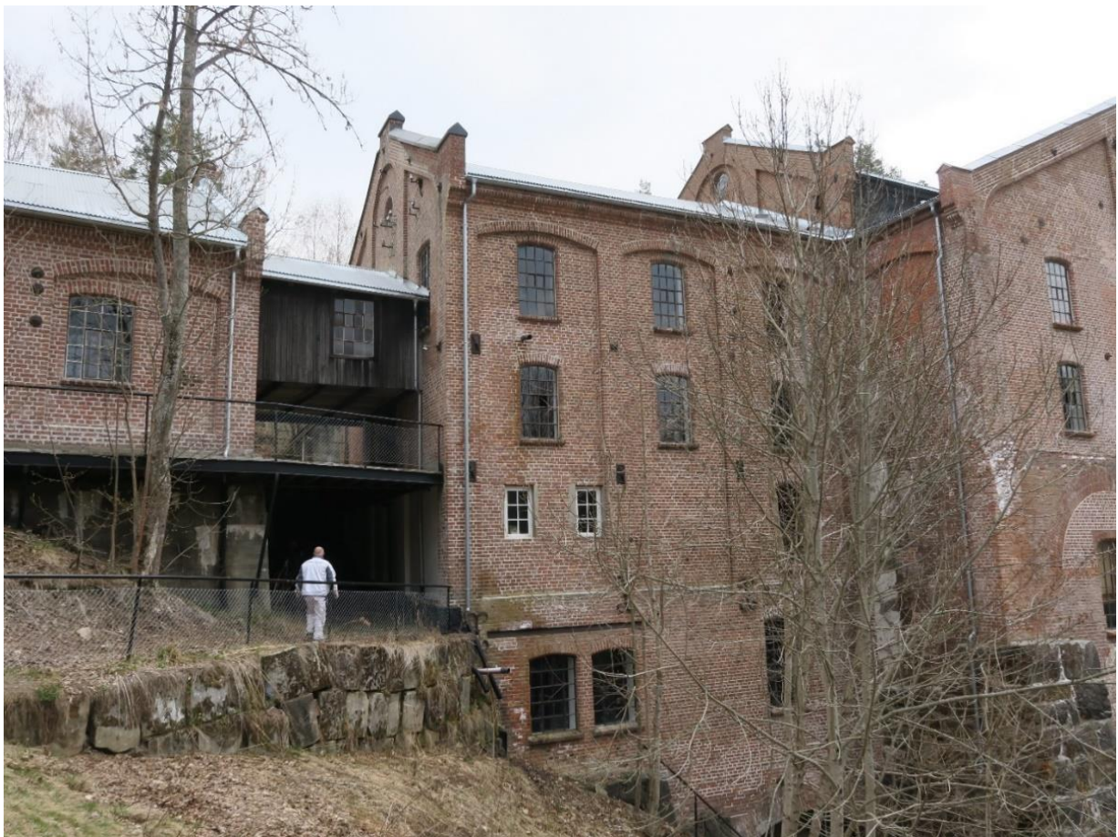
Tresliperiets vestre fasade. Fra venstre er Renseriet, passasjen for kubbtransportøren, Kapphuset og selve bygningen der treslipingen foregikk med turbiner i bunnen.
