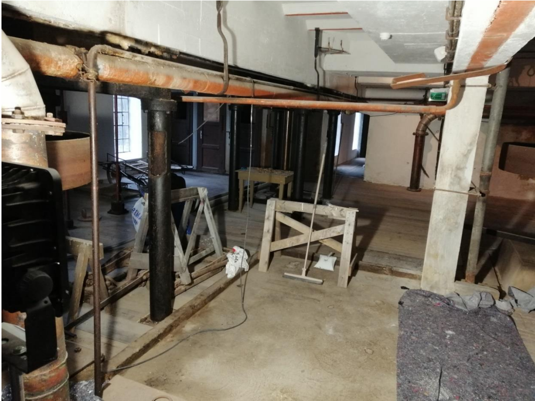
Sentralvarmerør i området ved Akslingsrommet. Toalettene er i bakkant til venstre.
