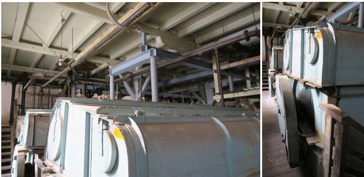
De tre fortykkerne sett mot sliperiet.
