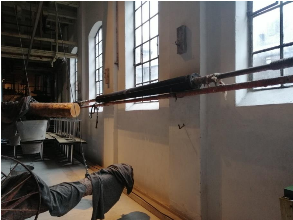
Rør for sentralvarmesystemet i Produksjonshallen langs langveggen mot nord. Sett mot nordøstre hjørne.
