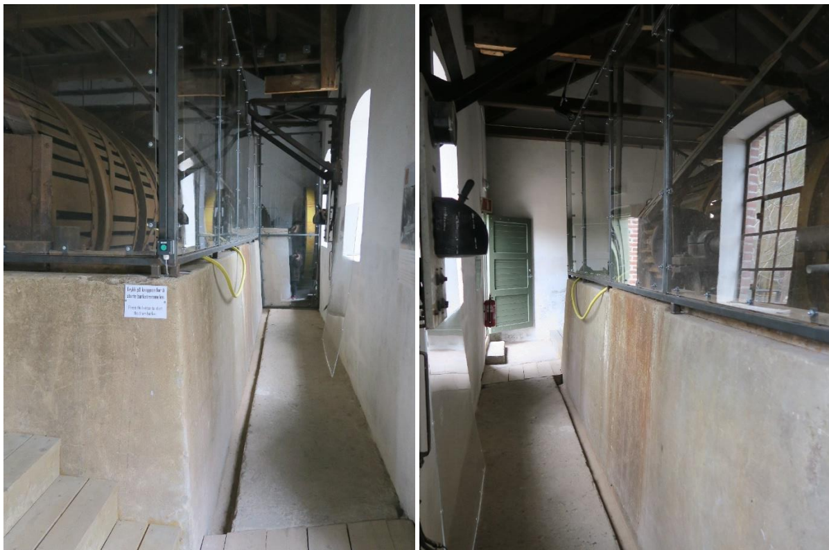
Tv. den vestre trommelen. Tromlene er beskyttet med plexiglass. Th. vestre vegg med kontrollpanel.
