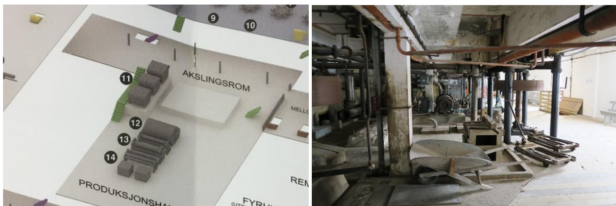
Plan over akslingsrommet og foto sett fra nord. Trappen med gelender til høyre i bildet, er gangveien mot turbinene.
