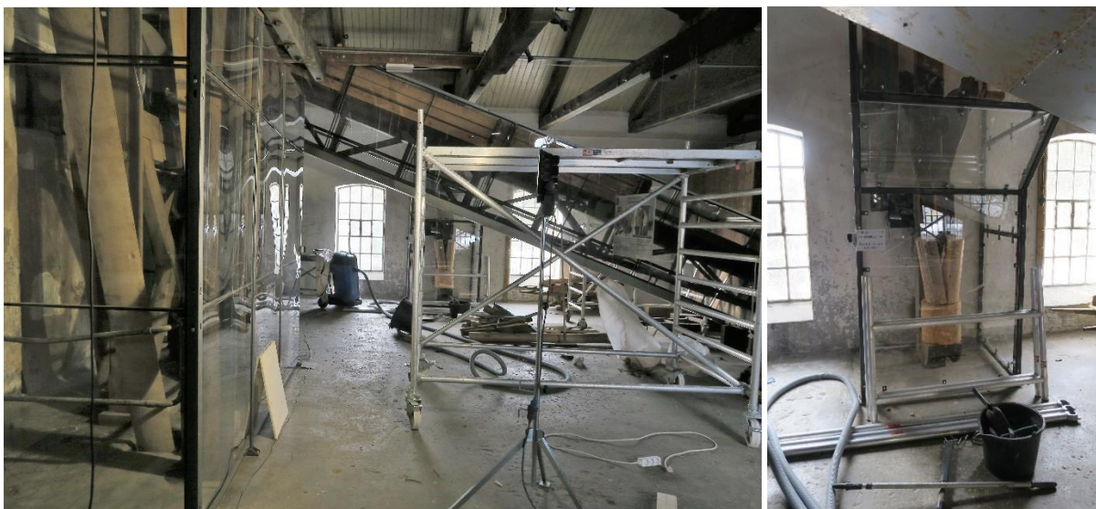
Tv. lengst til venstre ved søndre vegg ses reimverket for drift av maskineriet. Det er beskyttet med plexiglass. Reimverket går tre-fire etasjer ned og er koblet til en driftsturbin. I senter under kubbtransportøren og i bakgrunnen ses kubbkløyveren. Th. detalj av kubbkløyveren ved vestre vegg, også den beskyttet med plexiglass..
