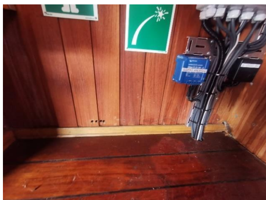
Gulvlister og elanlegg til brannslukningsanlegget.
