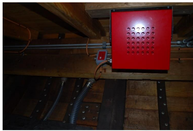
Brannslukkeranlegg - røyk- og pulverbasert.
