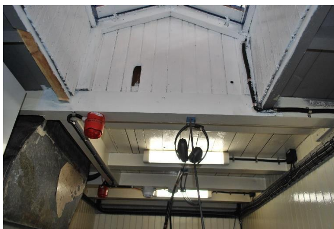
Innside casing og skylight.
