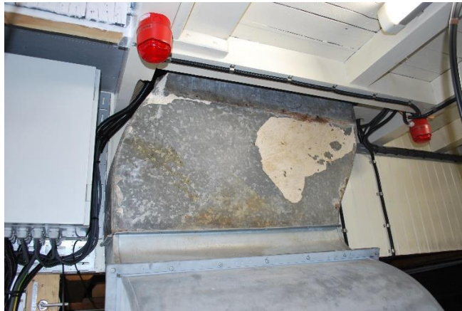
Eksos/kjøleluftkanal til motor ved casing.
