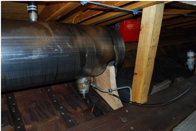
Dieseltank - dieselryr. Tanken er bunkers. Kopi i form av den opprinnelige, men laget i syrefast og i tykkere gods i forbindelse med restaureringen 2015-2023.
