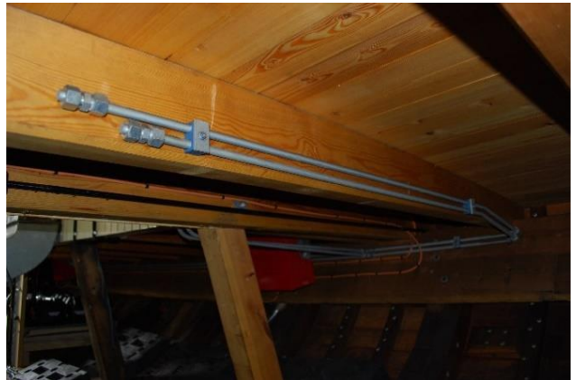
Hydraulikkrør til styringssystemet.
