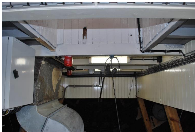
Skylight og eksos/kjøleluftkanal til motor.
