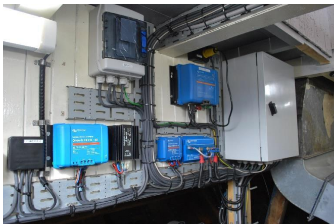
EI-tavler og sikringsskap.
