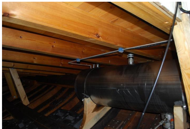
Dieselryr fra dieseltank.
