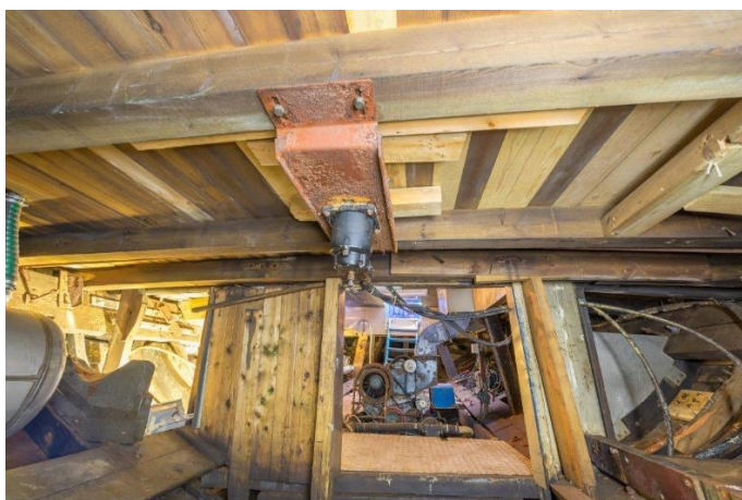
Rester av skott forut for motor i maskinrom 2015.
