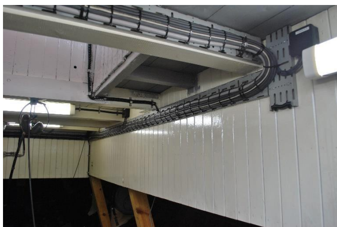
Kabelføring på innsiden av casing.
