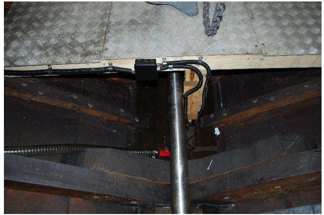
Propellaksling og akterende av dørken i maskinrom.
