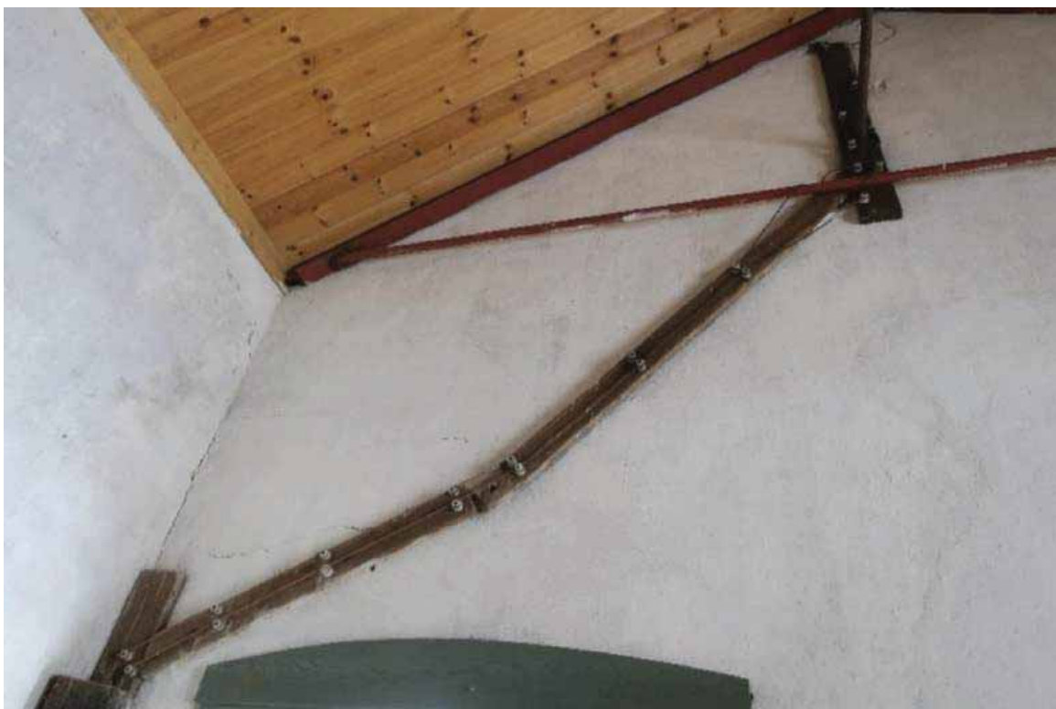
Elektrisk anlegg over døra på vestre gavlvegg.
