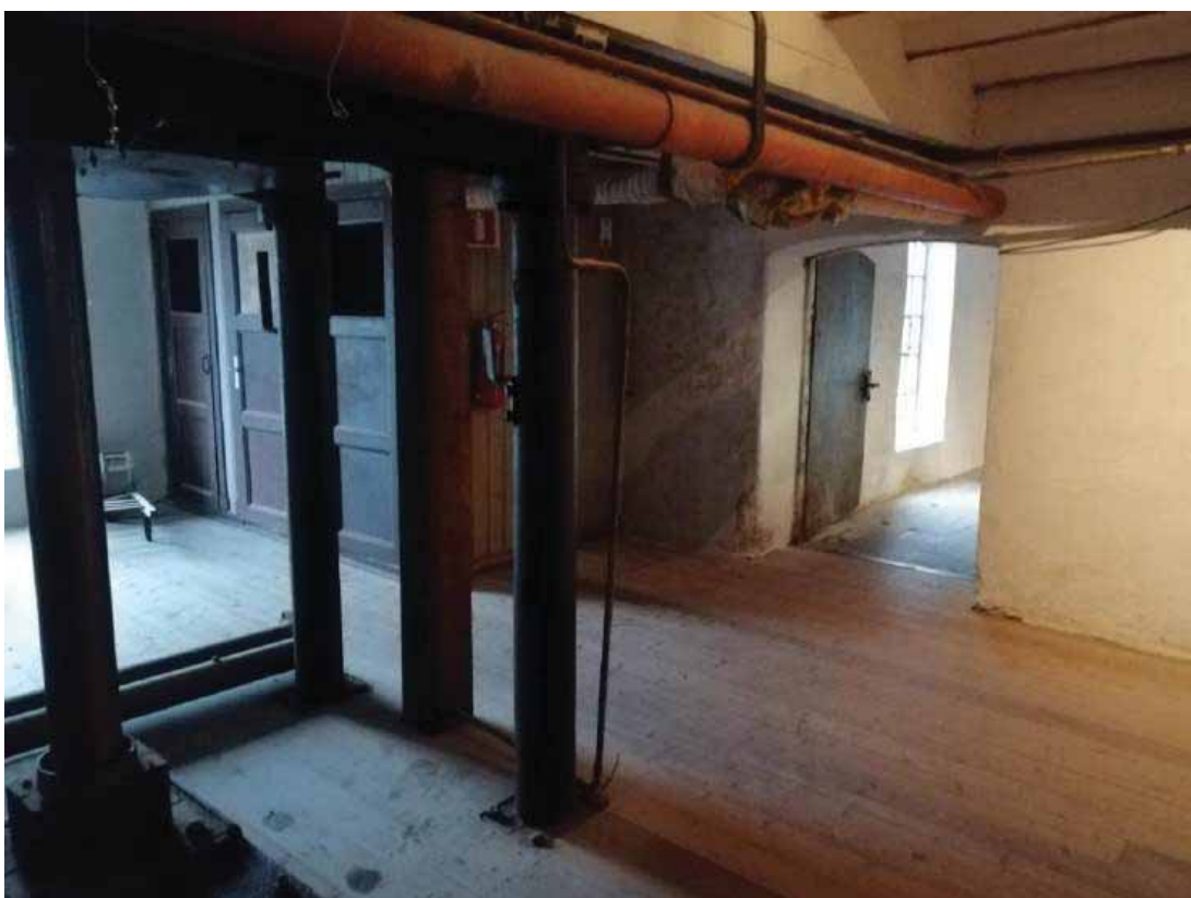
Sentralvarmerør i området ved Akslingsrommet.
