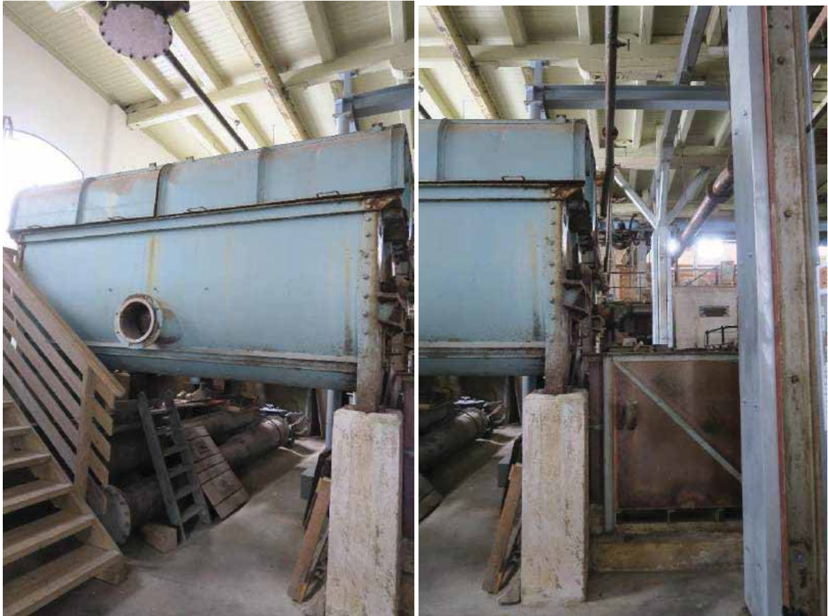
Fortykkerne står på betongfundamenter.
