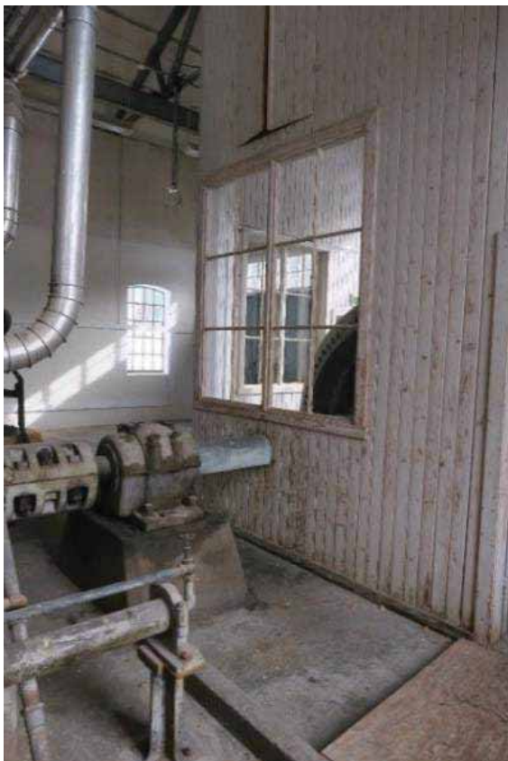
Koblingen mellom treslipemaskinene og generatoren som er plassert på andre siden av veggen mot sør.
