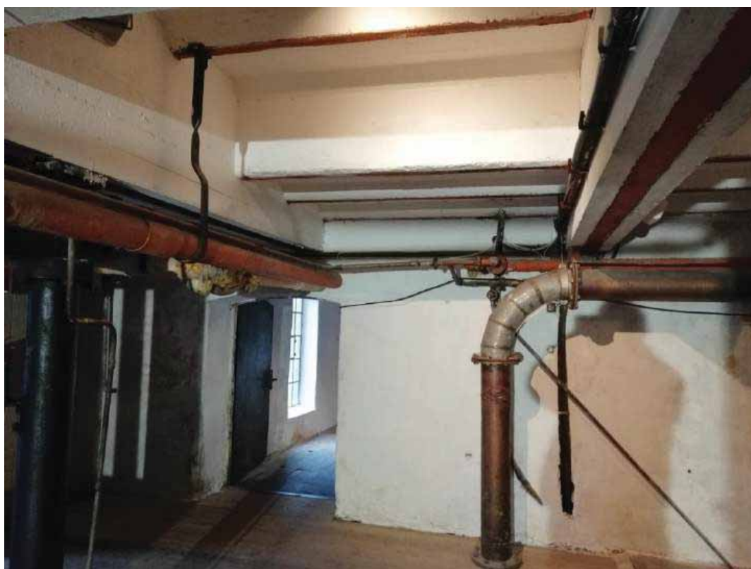
Sentralvarmerør i området ved Akslingsrommet.
