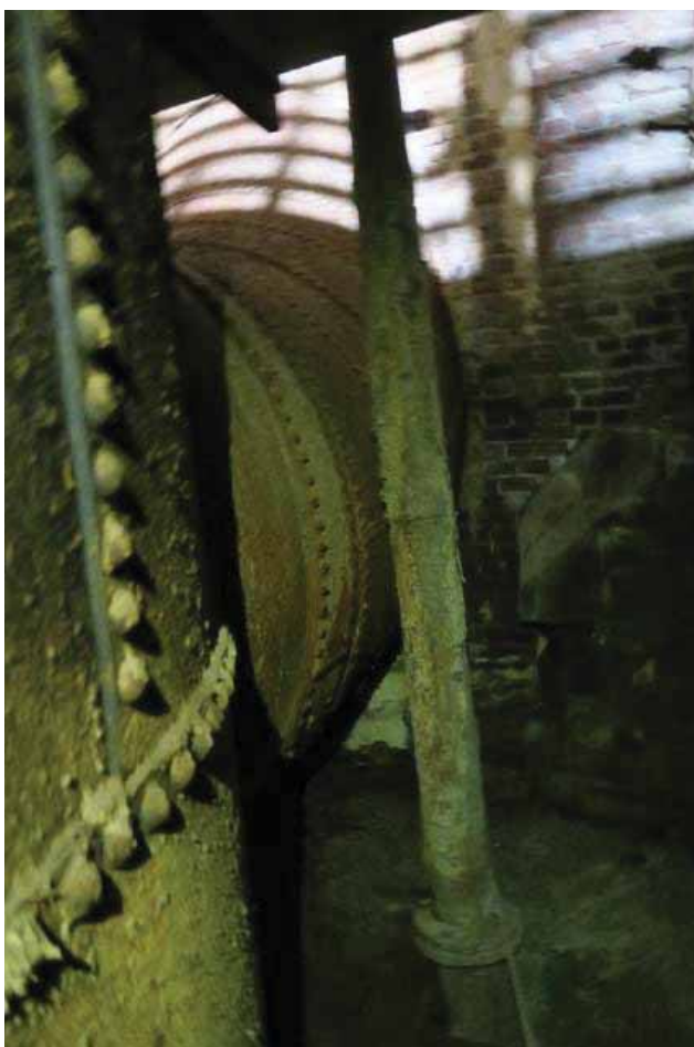
Detalj av turbinrør på nivå 4.
