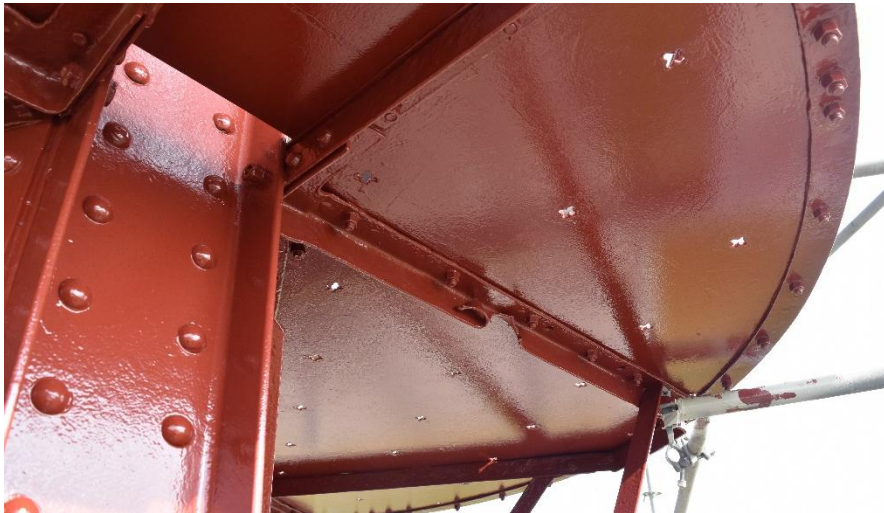
Figur 21: Undersiden av ny dørplate. Merk skuddskade i vinkeljern. Foto: FFK.
