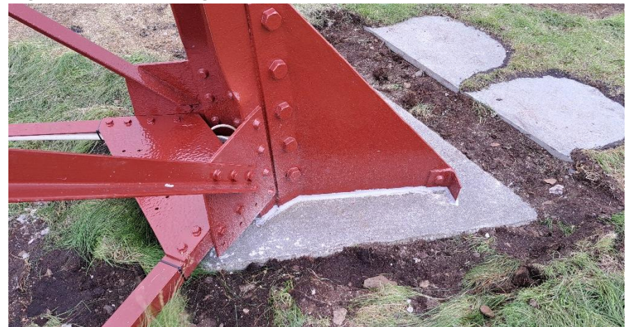
Figur 41: Detalj fra ferdig istandsatt fundament. Stålprofil langs bakken er flyttet opp – se hull fra opprinnelig plassering nederst på plata. Det ble støpt ny overflate på betongfundament, fuget med moderne fugemasse. Foto: FFK.
