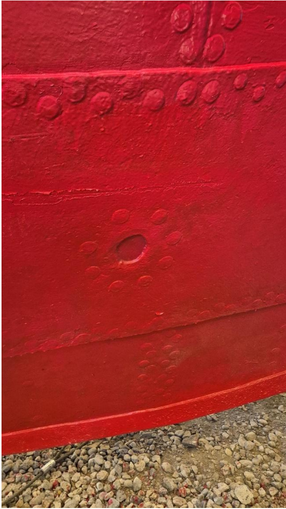
Styrbord side, under vannlinja. Tidligere utløp fra toalett er blendet med klinket blindplate. 6/5-2026. Foto: Kjartan Nordby, Agder fylkeskommune.
